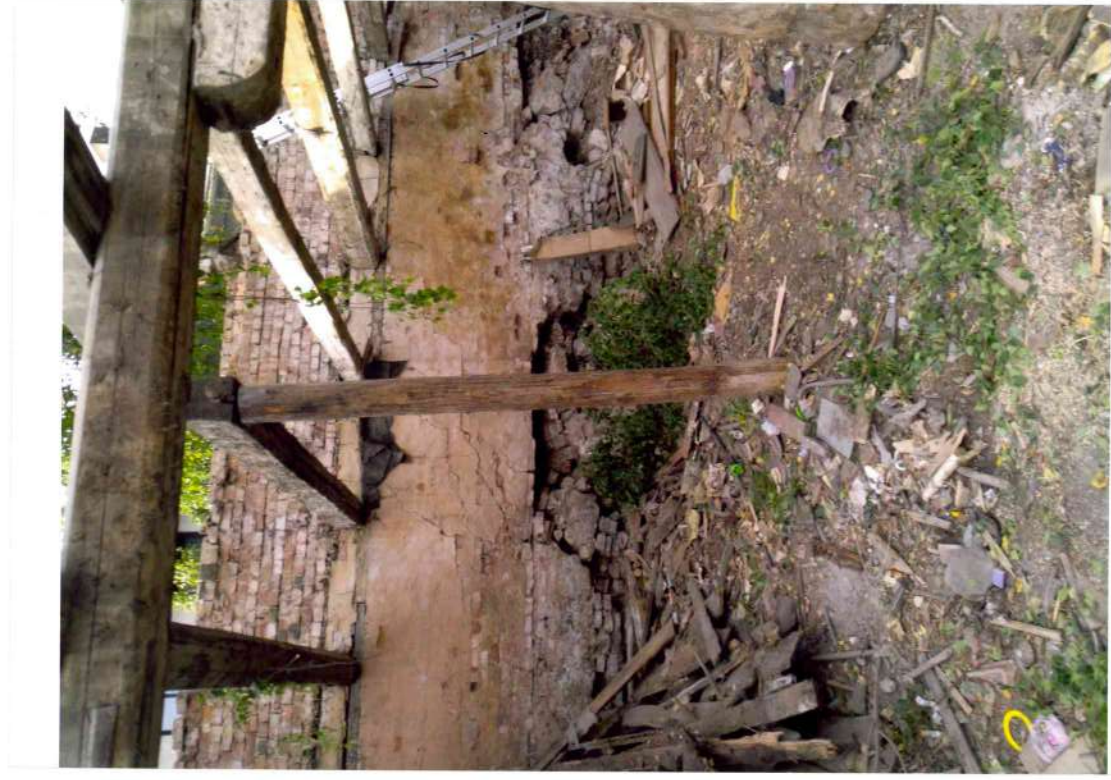
21. attēls. Saimniecības ēkas ārsienas ( mūra žogs pret Kalēju ielu) fragments (vidus daļa) ar koka pārseguma sijām no sākotnējās ēkas. Sienas apakšējā daļa bojāta ar ieaugušo koku saknēm.
