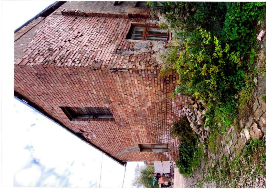
30. attēls. Dzīvojamās ēkas Nr.32 mūra apjoma kopskats no ZR puses. Z fasādes lejasdaļā uz ķieģeļiem izdalījušies sāļi, R fasādes augšdaļā ķieģeļu virsma erodējusi, atsevišķi ķieģeļi izdrupuši. Saglabājies sākotnējais koka logs L-1 (112X155cm).
