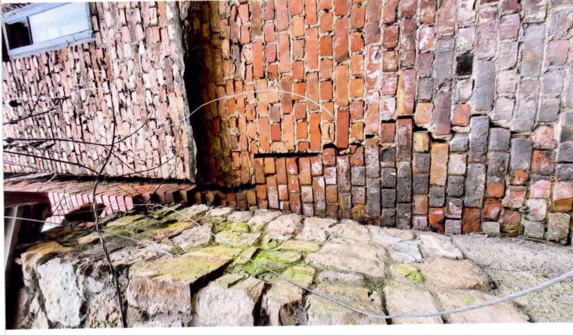
13. attēls. Dzīvojamās ēkas (apbūves C daļa) Z fasādes fragments. Ēkas ZA stūrī gala āršiena atdalījusies iekšpagalma āršienas ar caurejošu plaisu.
