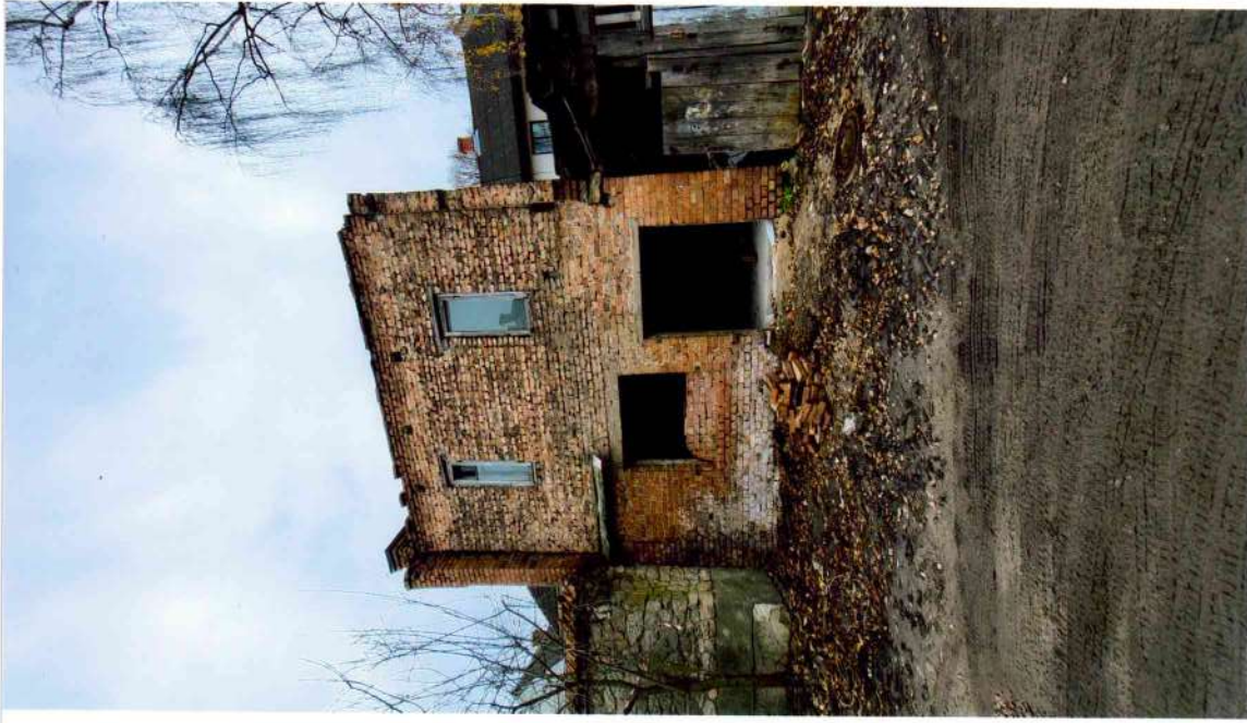
12. attēls. Dzīvojamās ēkas (apbūves C daļa) Z fasāde. Skats no iekšpagalma. Ēkas pārbuve nepabeigta, ailes iebūvētas neregulāri, haotiski. 2.stāvā iebūvēti koka logi.
