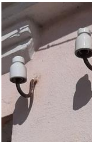
27. attēls. Novecojuši elektrības vadu stiprinājuma āķi
