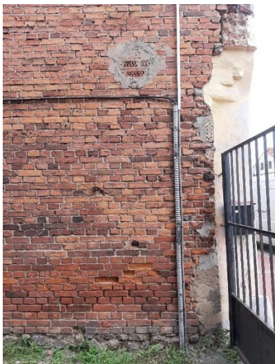
37.attēls. Nobrukušais stūris un aizmūrētā ventilācijas lūka ēkas R sienā
