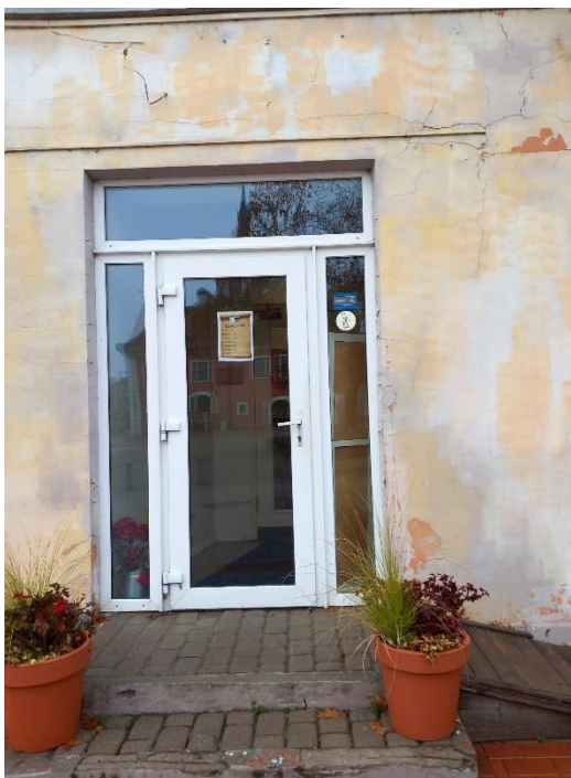
94. attēls. PVC durvis fasādē (plānā D/1)
