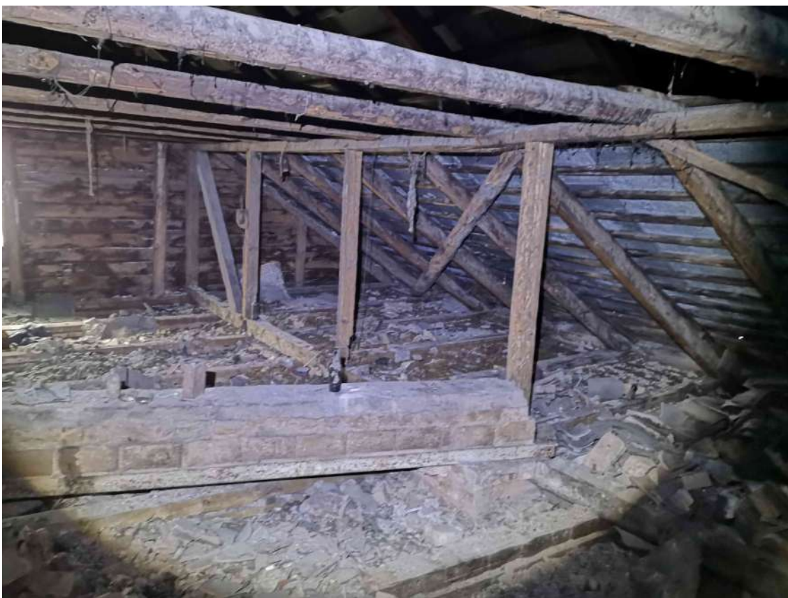
66.fotoattēls Jumta konstrukciju kopskats. Lokāli deformēti augšējie kopturi.
