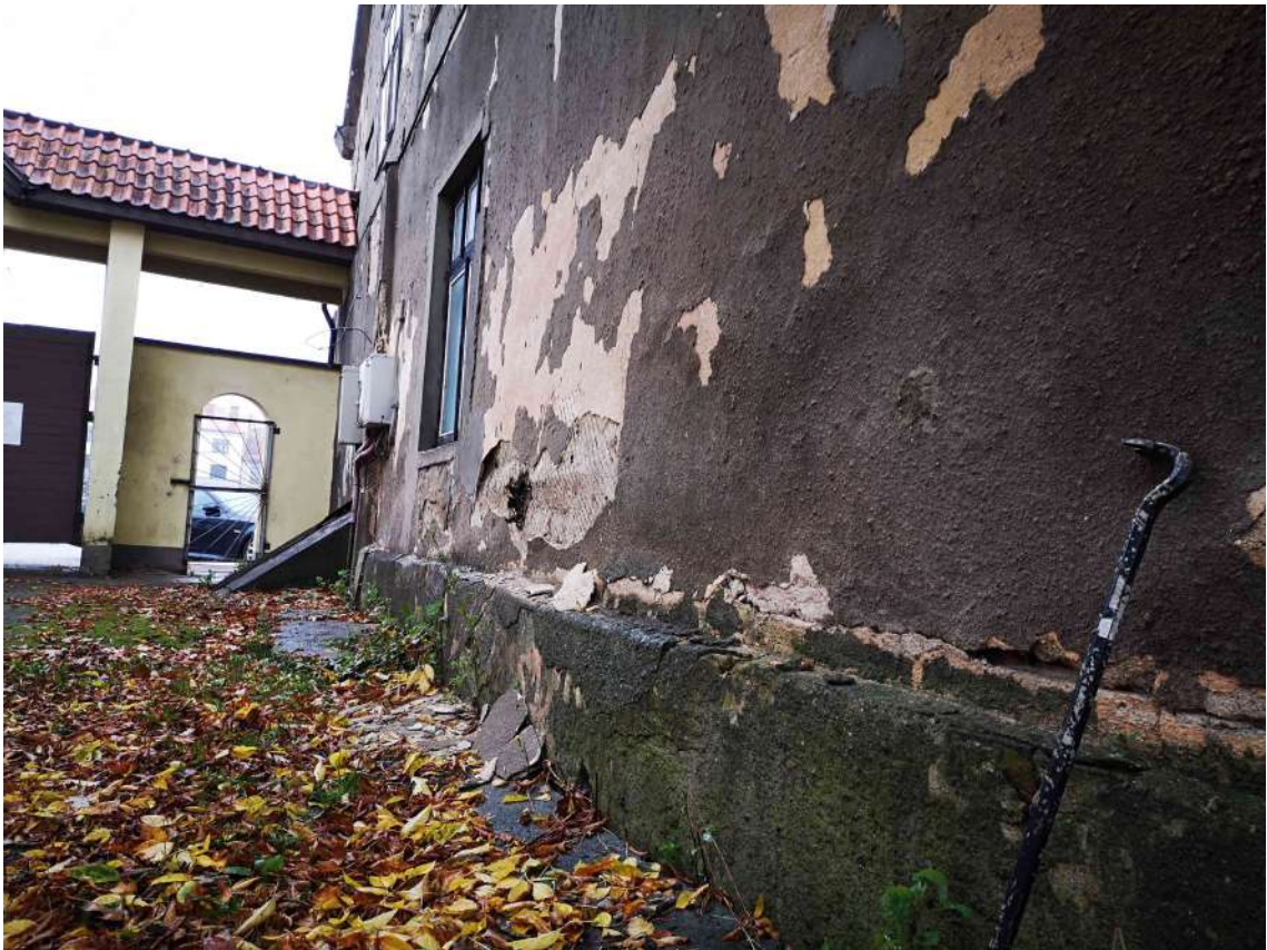
8.fotoattēls D fasādes cokola daļas apdares bojājumi.
