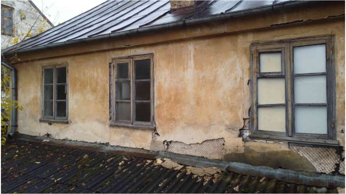
11.fotoattēls Pagalma fasādes 2.stāva apdares bojājumi.
