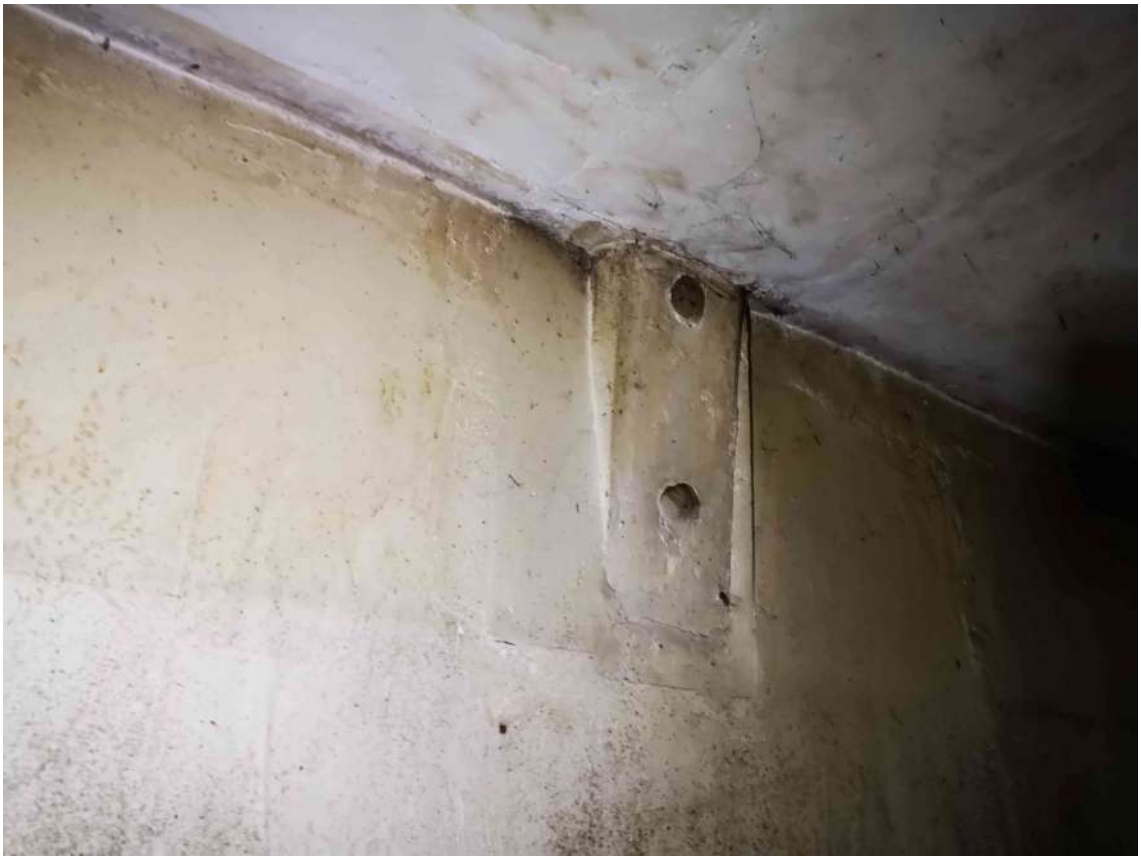
49.fotoattēls 1.stāva pārseguma atbalsta elements (iesrādāts starpsienā).
