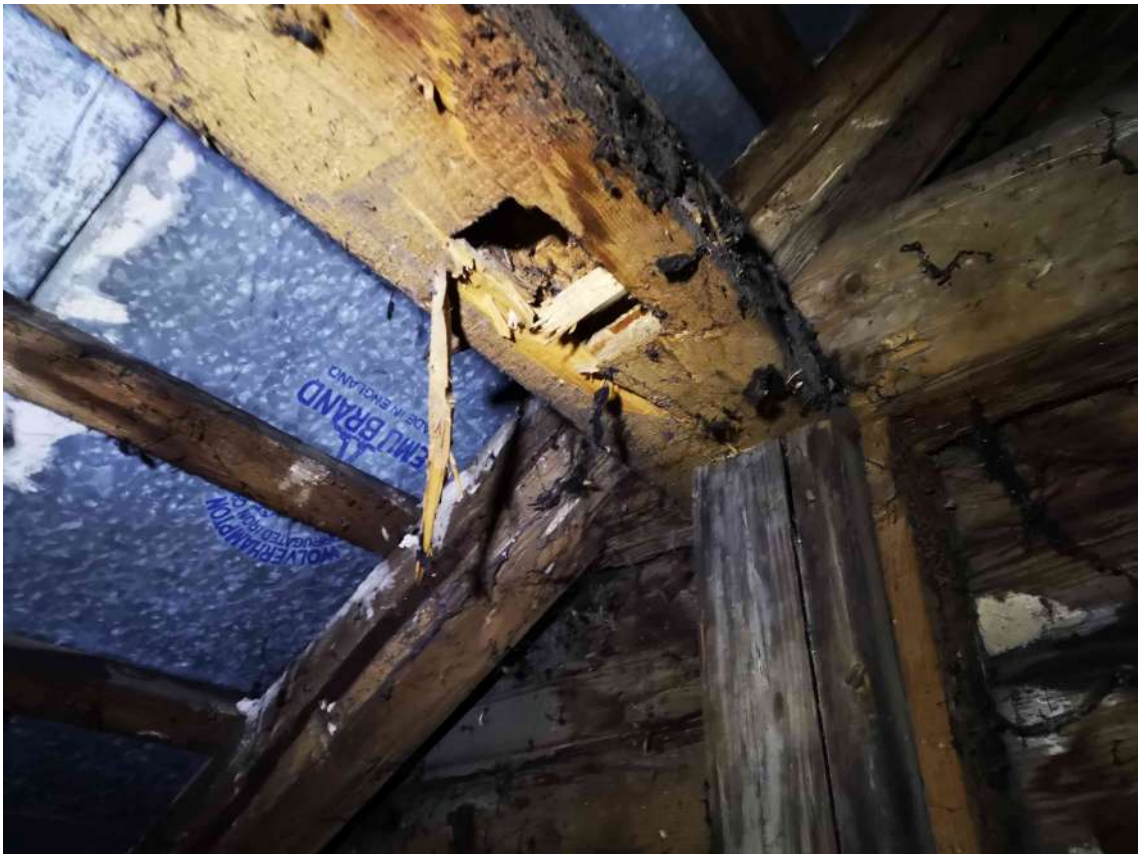
71.fotoattēls Lokāli demontēts jumta krēsla atgāžņa/stata mezgls.
