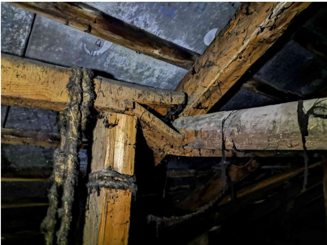
72.fotoattēls Deformēts jumta krēsla augšējā koptura/saišķa balstmezglis.
