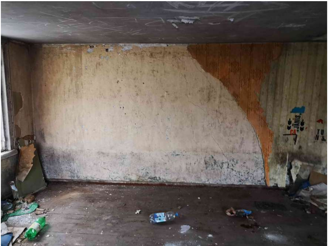
63.fotoattēls 2.stāva nesošās starpsienas deformāciju izraisītas plaisas apdarē.
