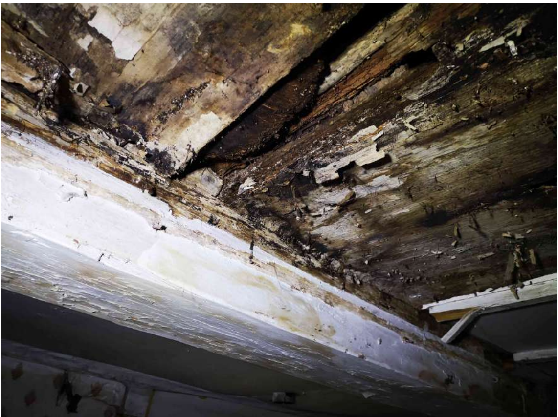
42.fotoattēls Satrupējusi triniņi liktu dēļu griestu konstrukcija virs pārseguma pasijas.
