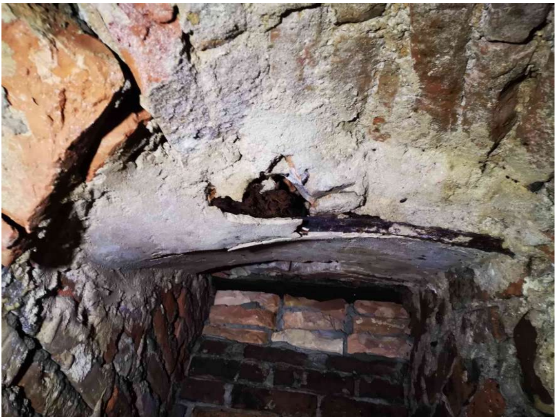
33.fotoattēls Korozijas ietekmē atslāņojušies pagraba ailu pārsedzes elementi.
