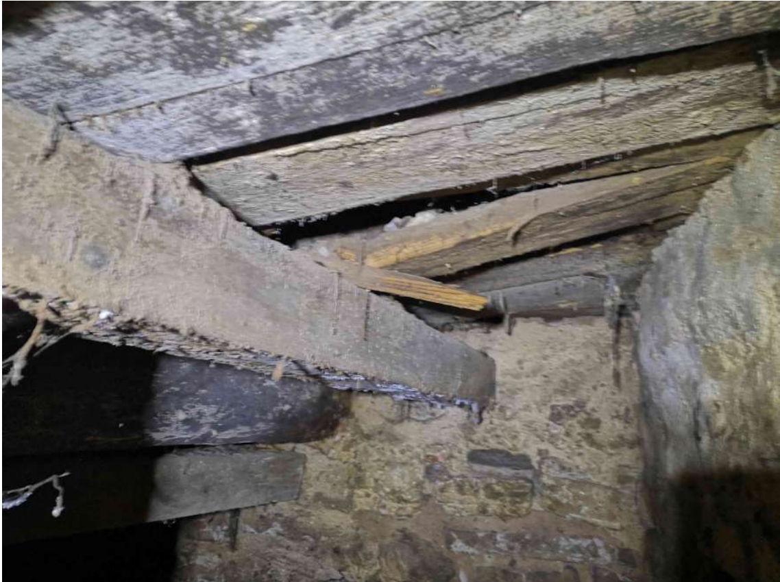
24.fotoattēls Lokāli iebrukušas/satrupējušas pagraba pārseguma konstrukcijas.
