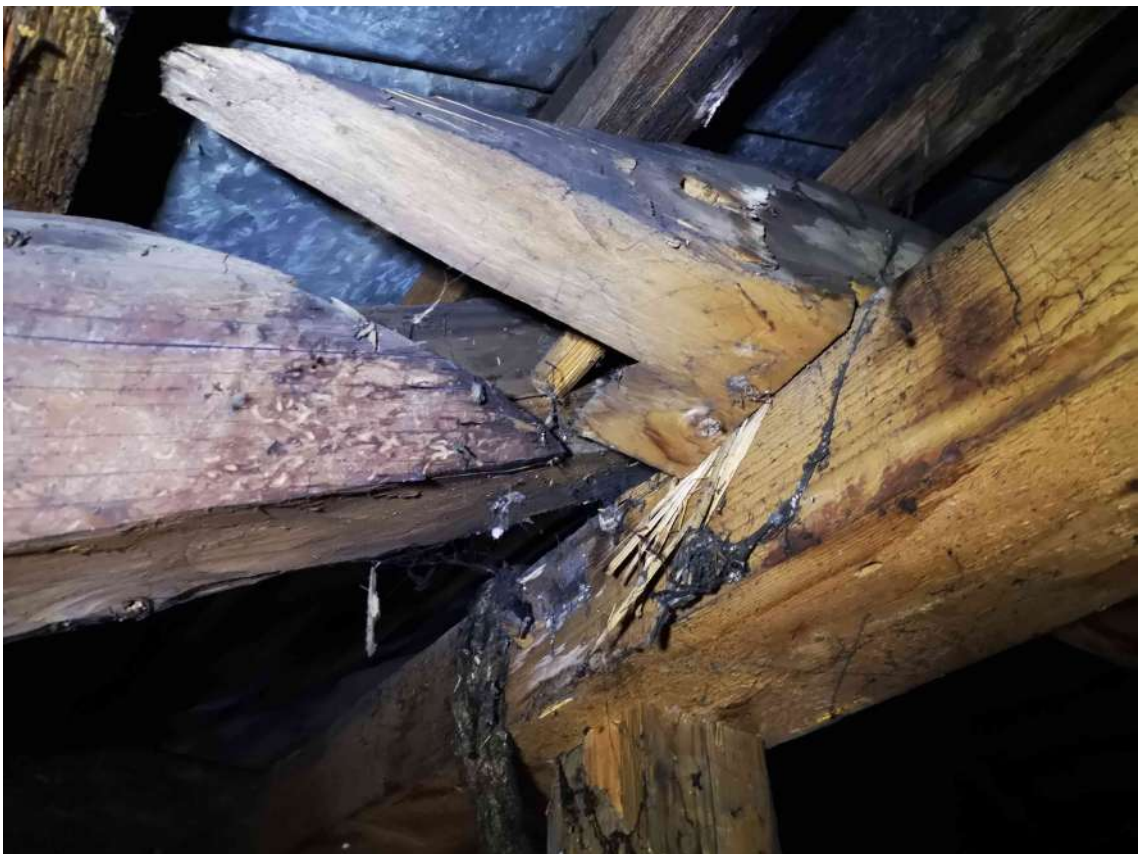
74.fotoattēls Deformējies spāru/saišķa savienojuma mezgls.
