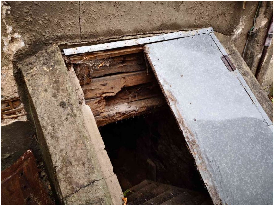
12.fotoattēls Trupējušas ārsienu apakšējo guļšķautņu konstrukcijas. Pagraba noeejas lūka.
