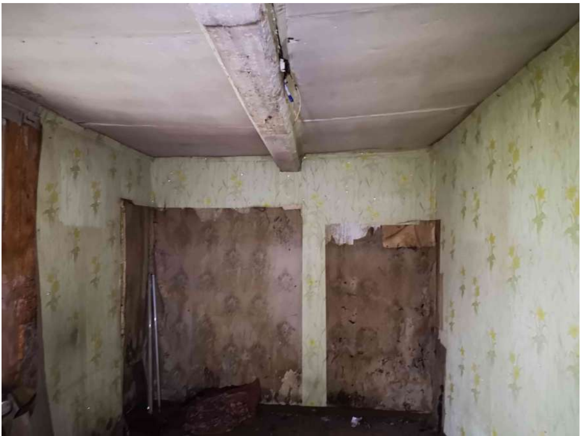
43.fotoattēls 1.stāva pārseguma pasija. Griestu apdares/pārseguma(?) deformācijas.
