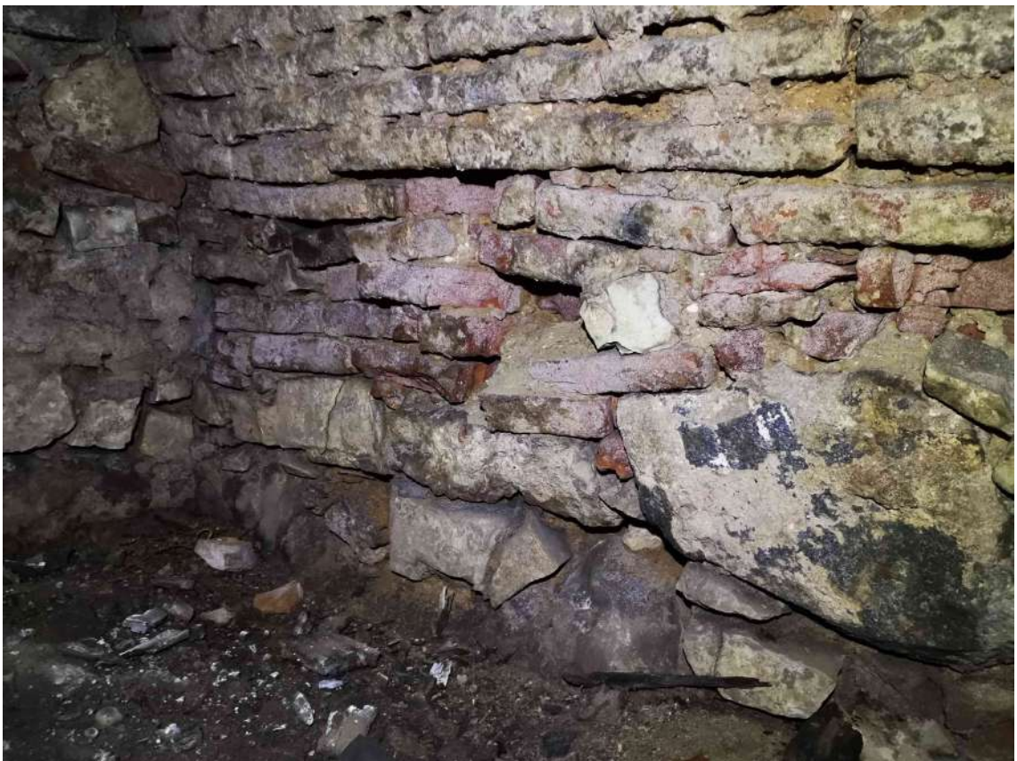
32.fotoattēls Erodējis pagraba nesošo sienu mūrējuma fragments. Šuvju erozija.
