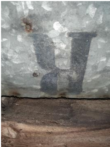
69. attēls. Jumta skārda loksnes fragments
