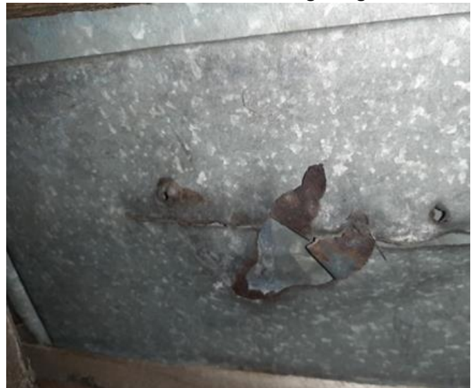
70. attēls. Šāviņu radītie jumta bojājumi
