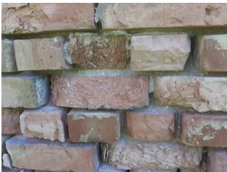
42. attēls. Mitruma bojātie ķieģeļi pagalma fasādē
