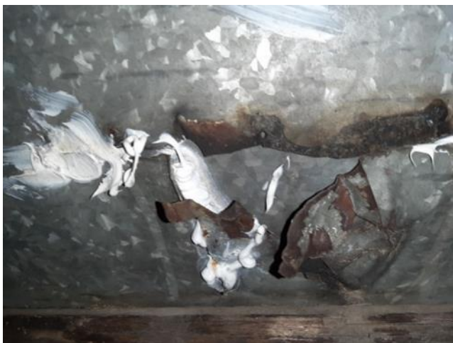
71. attēls. Šāviņu radītie jumta bojājumi
