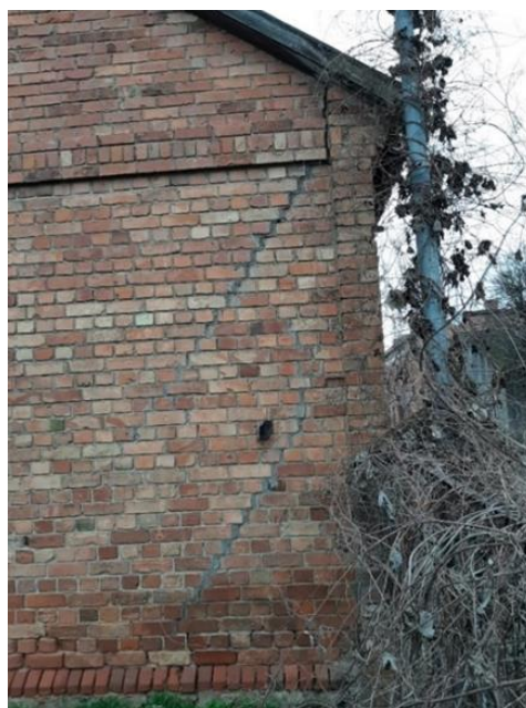
40. attēls. DA fasādē plaisas aizdarinātas ar cementu
