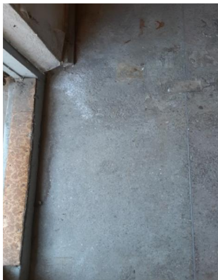
94. attēls. Betona grīdas fragments pie ārdurvīm
