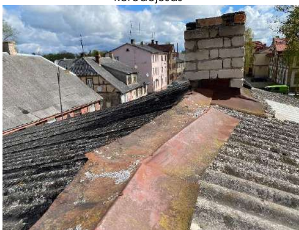
F - 61 Kores nosegskārds jumta centrālajā daļā korodējis, izklāvējis, nav atbilstoši nostiprināts
