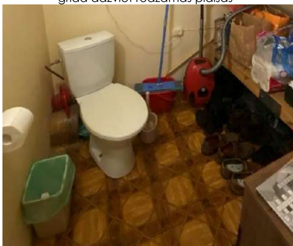
F - 87 Linoleja grīdas segums otrā stāva dzīvokļa sanmezglā
