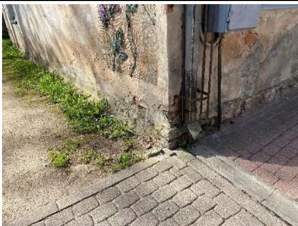
F - 9 Ēkas ZA stūrī izbūvēta lietus ūdens notekcaurule, zonā ap notekcauruli ievērojami bojāta apdare, mūrī mitruma piesātinājums. A fasādē pie pamatiem veidojas veģetācija
