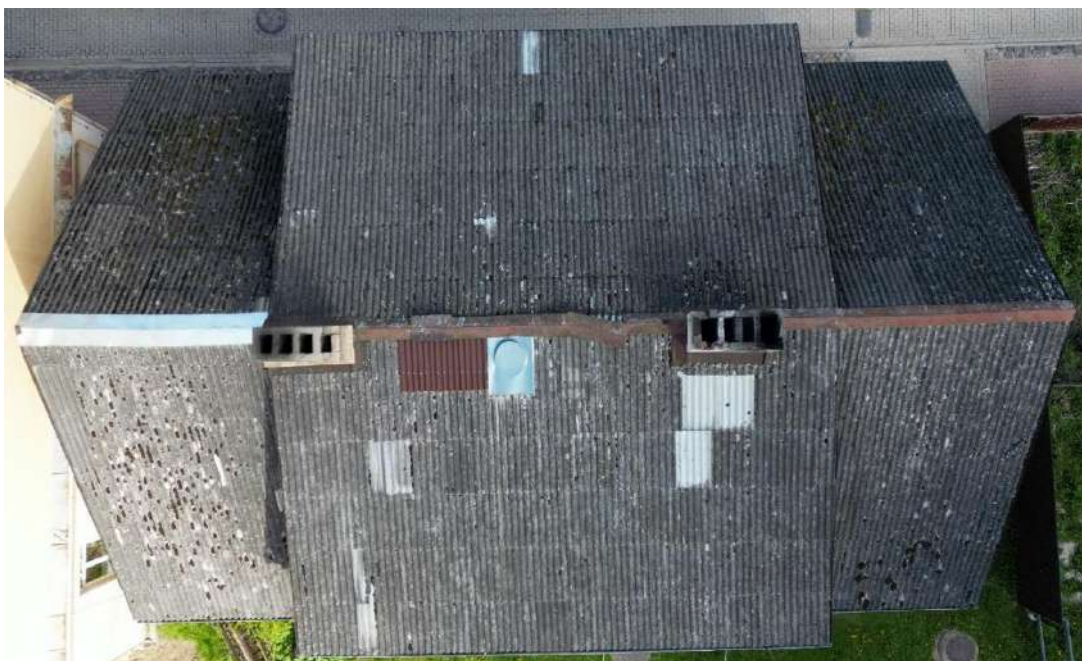
F - 57 Ēkas jumts skatā no augšas. Redzams, ka jumta segumam laika gaitā veikti lokāli labojumi. Ēkas R pusē nesenā pagātnē mainīts kores nosegelements
