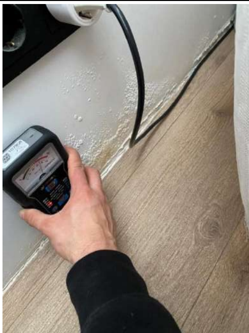
F - 33 Mitruma piesātinājums un izsāļojumi uz apdares pagalma puses ār sienas lejas daļā pirmā stāva dzīvoklī
