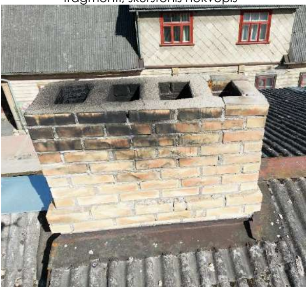
F - 105 Ēkas R puses skursteņa virsjumta daļa nesenā pagātnē pārmūrēta, bet arī šim skurstenim redzami izdrupumi, saistvielas erozija, virsjumta daļa nokvēpusi. Izdrupusi saistviela dažviet aizvietota ar celtniecības putām
