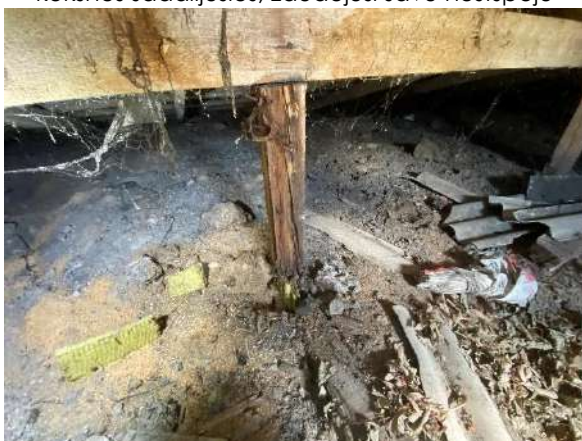
F - 53 Ēkas centrālās daļas (Rīgas ielas pusē) jumta konstrukciju kopturis deformējies, tā statņu balstvietās redzami izteikti trupes bojājumi, koknes sadalījusies, zaudējusi savu nestspēju
