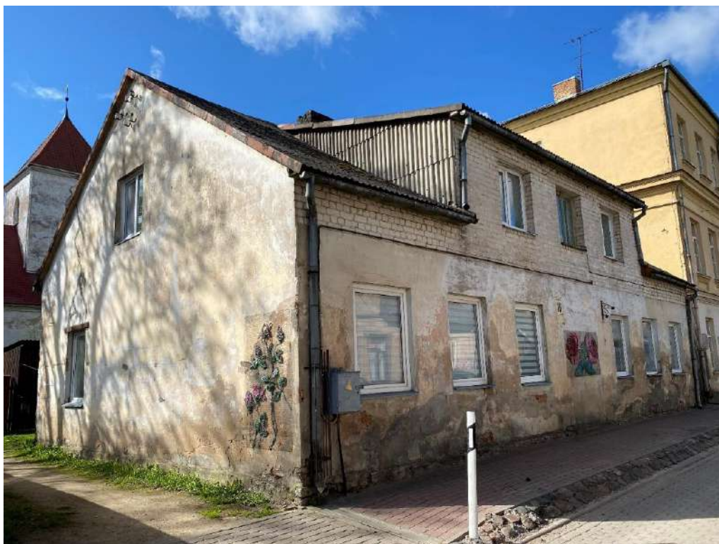
F - 23 Skats uz ēku no Rīgas ielas. Pirmajā stāvā apmestas māla ķieģeļu mūra ārsienas, otrajā stāvā – neapmests silikātķieģeļu mūris. Sienu lejas daļās izteikts mitruma piesātinājums, bojāta apdare
