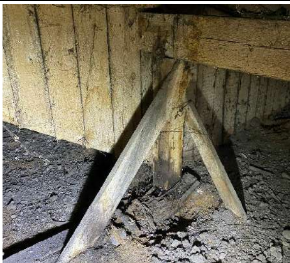
F - 51 Ēkas centrālās daļas (Rīgas ielas pusē) jumta konstrukciju kopturis deformējies, tā statņu balstvietās redzami izteikti trupes bojājumi, koknes sadalījusies, zaudējusi savu nestspēju
