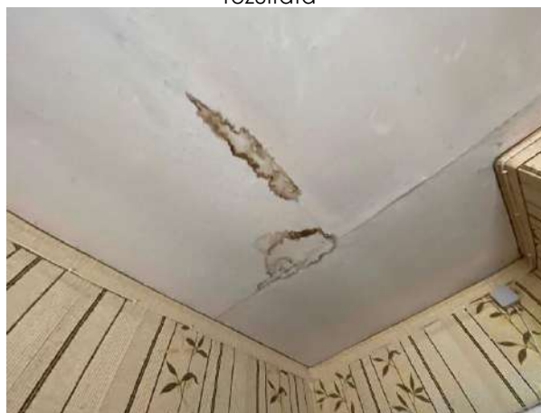
F - 118 Otrā stāva dzīvoklī uz griestu apdares atsevišķās zonās redzami notecējumi
