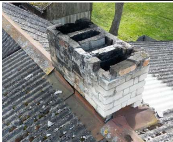
F - 102 Ēkas A puses skursteņa virsjumta daļā redzami izdrupumi, mūra erozija, nestabili mūra fragmenti, skurstenis nokvēpis
