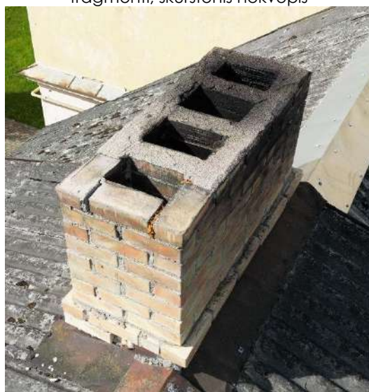
F - 106 Ēkas R puses skursteņa virsjumta daļa nesenā pagātnē pārmūrēta, bet arī šim skurstenim redzami izdrupumi, saistvielas erozija, virsjumta daļa nokvēpusi. Izdrupusi saistviela dažviet aizvietota ar celtniecības putām
