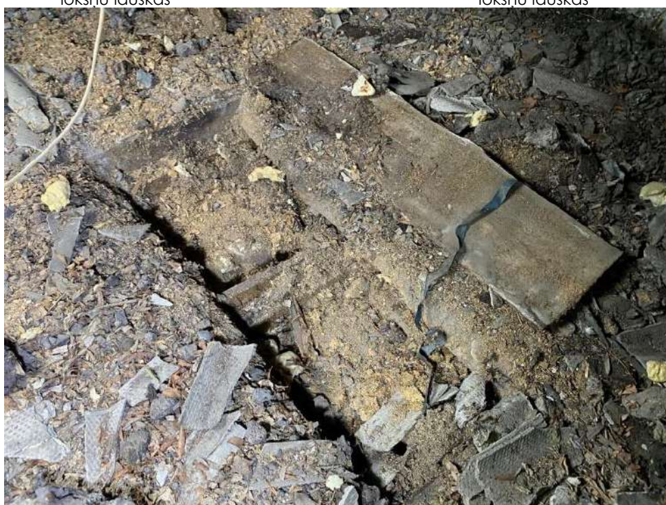
F - 40 Otrā stāva pārsegumam izbūvēts izdedžu, skaidu, būvgružu siltumizolācijas uzbērums, daudzviet ēkas bēniņos mētājas azbestcimenta lokšņu lauskas. Dēļu klāja atsegums
