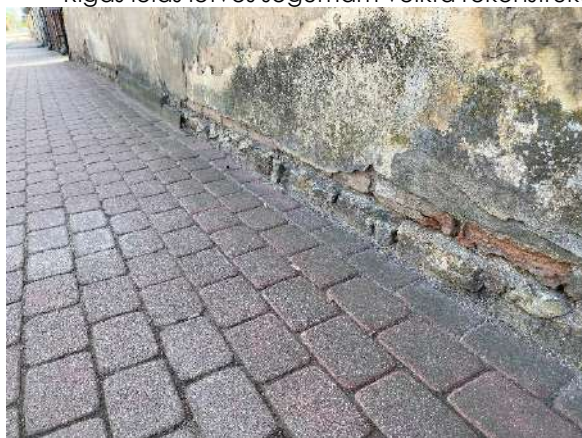
F - 2 Ielas rekonstrukcijas laikā paaugstināts ietves līmenis, dēļ tā samazinājies ēkas cokola augstums, atsevišķās zonās tas atrodas zem ietves līmeņa
