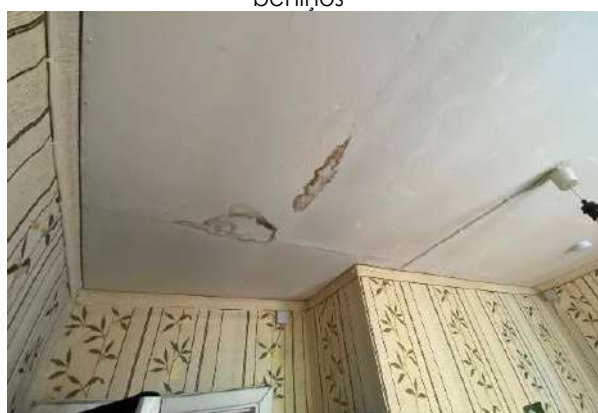
F - 68 Otrā stāva dzīvoklī vairākās vietās uz griestu apdares savulaik radušies notecējumi
