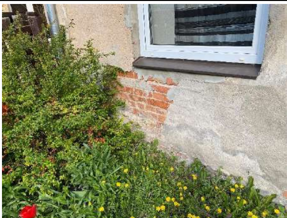
F - 15 Ēkas DR stūrī izbūvēta lietuss ūdens notekcaurule, kura nokrišņu ūdeni novada pie ēkas pamatiem, gar pamatiem veidoti apstādījumi, ievērojami bojāta sienas lejas daļas apdare
