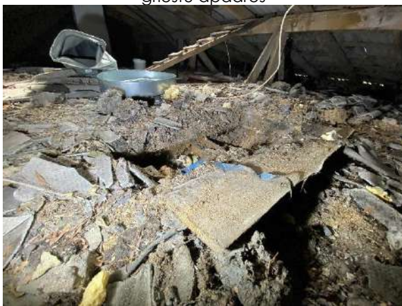
F - 43 Otrā stāva pārsegumam izbūvēts izdedžu, skaidu, būvgružu siltumizolācijas uzbērumš, daudzviet ēkas bēniņos mētājas azbestcimenta lokšņu lauskas
