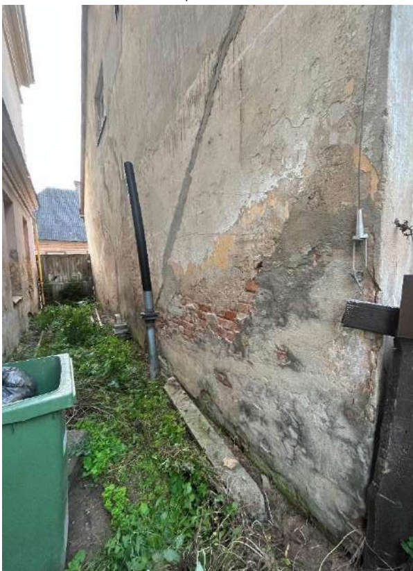
F - 17 Zemes līmenis gar ēkas R puses gala fasādē laika gaitā pieaudzis, zona starp ēkām netiek kopta, tajā nav sakārtota nokrišņu novadīšana, cokols atrodas zem pieguļošās zemes līmeņa, dēļ nepareiziem zemes kritumiem nokrišņu ūdens nonāk pie ēkas pamatiem, infiltrējas sienā
