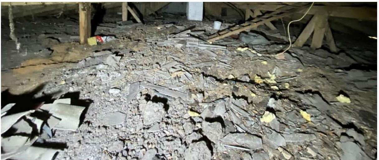
F - 37 Otrā stāva pārsegumam izbūvēts izdedžu, skaidu, būvgružu siltumizolācijas uzbērums, daudzzviet ēkas bēniņos mētājas azbestcimenta lokšņu lauskas
