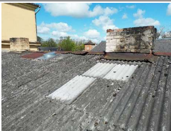
F - 59 Laika gaitā jumta segumam veikti lokāli remontdarbi. Skuršeņiem skārda iestrādes korodējušas
