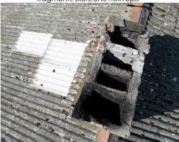
F - 103 Ēkas A puses skursteņa virsjumta daļā redzami izdrupumi, mūra erozija, nestabili mūra fragmenti, skurstenis nokvēpis
