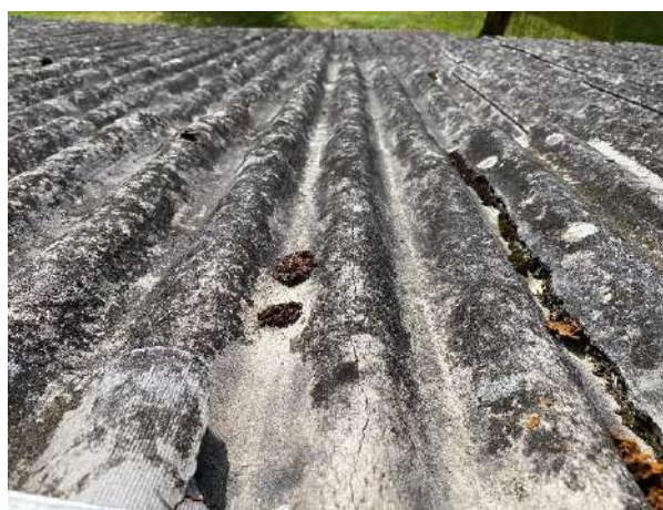
F - 62 Jumta seguma loksnes vairākās vietās bojātas – ar plaisām, salūzušas, uz tām veidojas bioloģiskais apaugums
