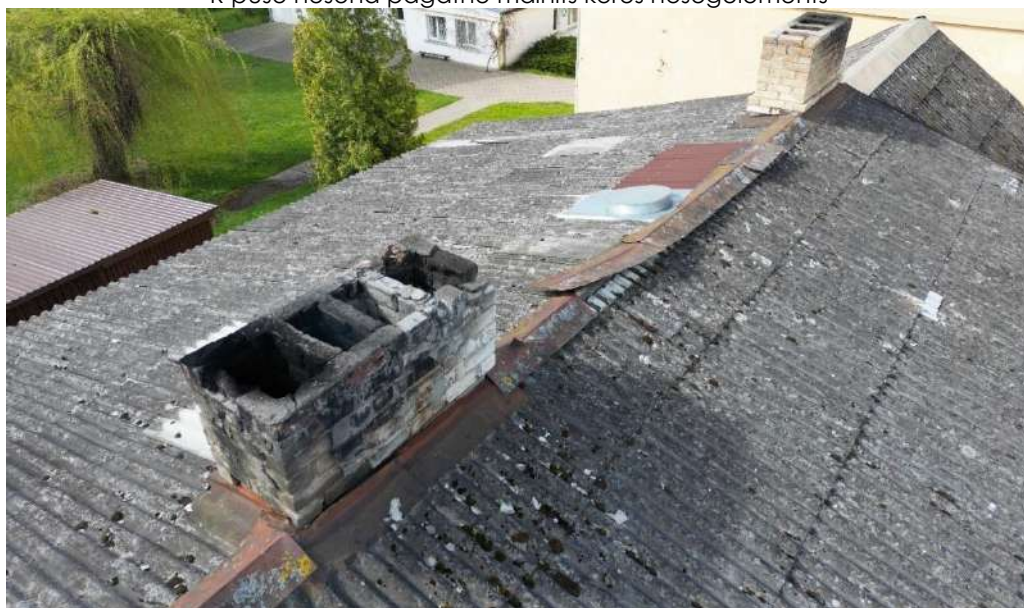
F - 58 Jumta centrālajā daļā korodējis, izklāvējis kores nosegskārds, skursteņu augšdaļās izdrupumi
