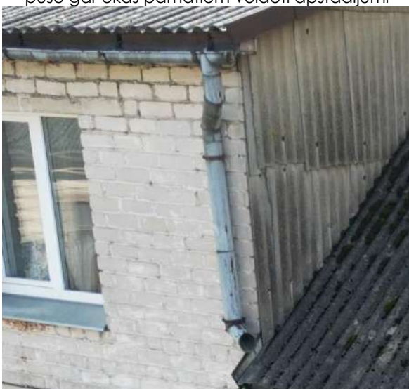
F - 73 Notekcaurules un teknes ar korozijas pazīmēm
