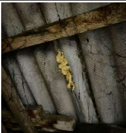
F - 65 Lokālās zonās salūzušās jumta seguma loksnes "labotas" ar celtniecības putām
