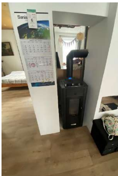
F - 97 Granulu apkures katls pirmā stāva dzīvoklī, tā dūmkanāls ievadīts skurstenī
