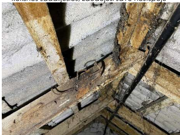
F - 56 Atsevišķās vietās, kur nokrišņu mitrums iekļuvis bēniņos, uz jumta konstrukcijām un latojuma redzami notecējumi, trupes bojājumi
