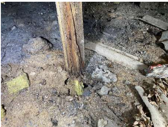
F - 45 Lokālās zonās, kur uz pārseguma balstītis jumta konstrukciju kopturis, redzami savulaik radušies mitruma bojājumi, nav izslēgts, ka trupējušas arī pārseguma konstrukcijas
