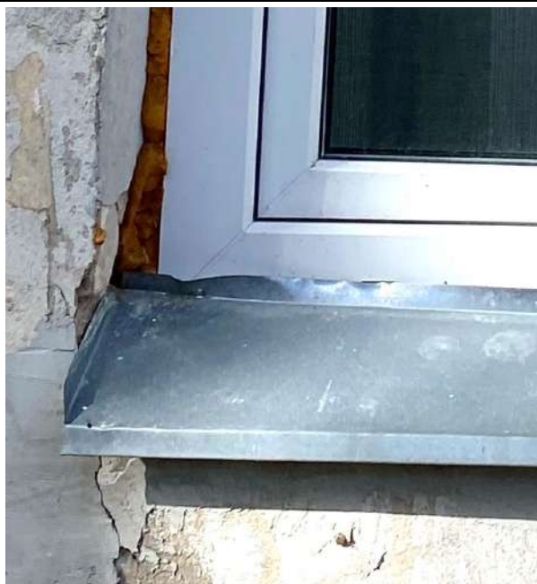
F - 93 Ārējā palodze izbūvēta nekvalitatīvi, daļēji nosedz loga rāmja drenāžas atveres. Nav atjaunota ārējā ailes apdare
