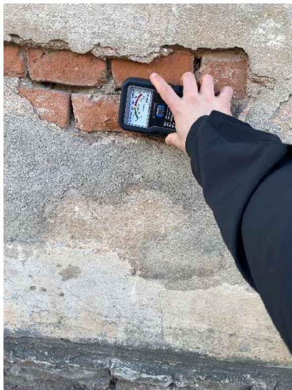
F - 8 Paaugstināts mitruma piesātinājums sienas lejas daļā novērojams pa visu ēkas perimetru
