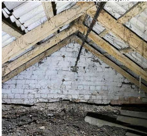
F - 110 Bēniņos pie jumta koka konstrukcijām stiprināti elektrokabeļi
