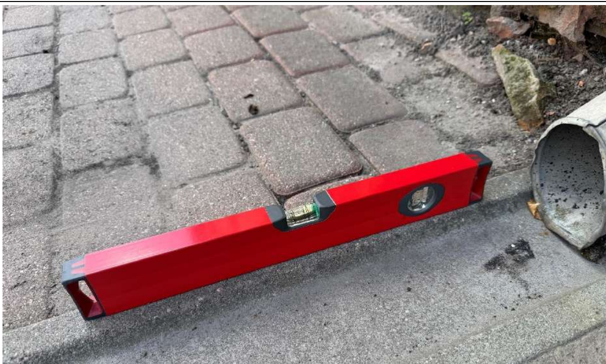
F - 6 Rīgas ielas ietvē iebūvētajai betona teknei (pie ēkas ZR stūra notekcaurules gala) redzams ačgārns kritums – virzienā uz ēkas pamatiem
