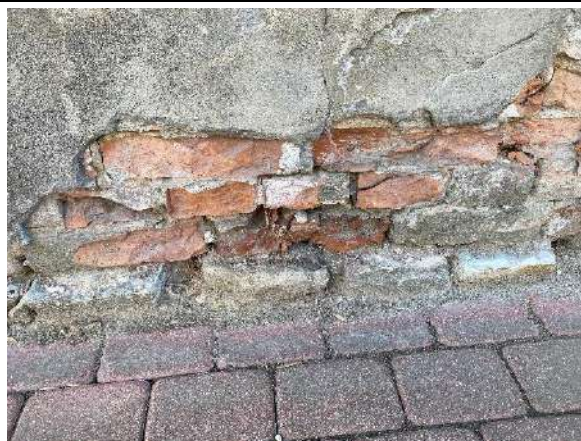
F - 126 Sienu lejas daļās apdare ievērojami bojāta, dažviet zudusi, redzama mūra erozija
