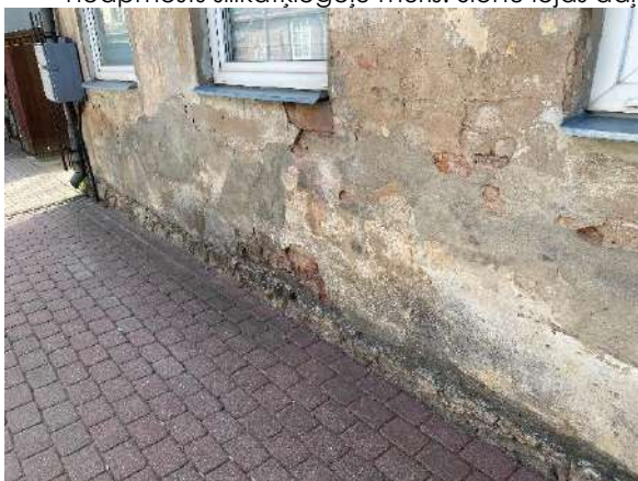
F - 25 Ārsienu lejas daļā izteikts mitruma piesātinājums, vairākās zonās atslāņojusies apdare, redzama mūra erozija
