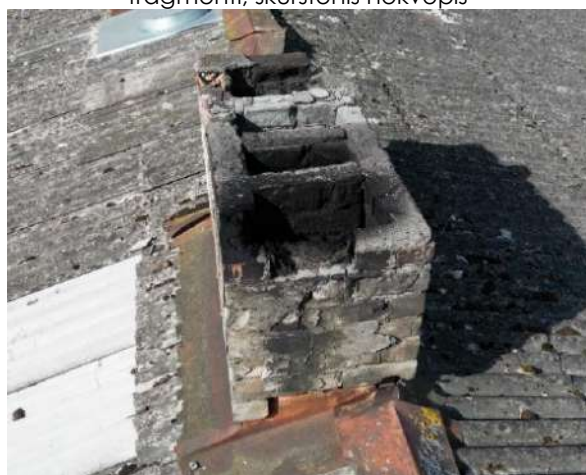
F - 104 Ēkas A puses skursteņa virsjumta daļā redzami izdrupumi, mūra erozija, nestabili mūra fragmenti, skurstenis nokvēpis
