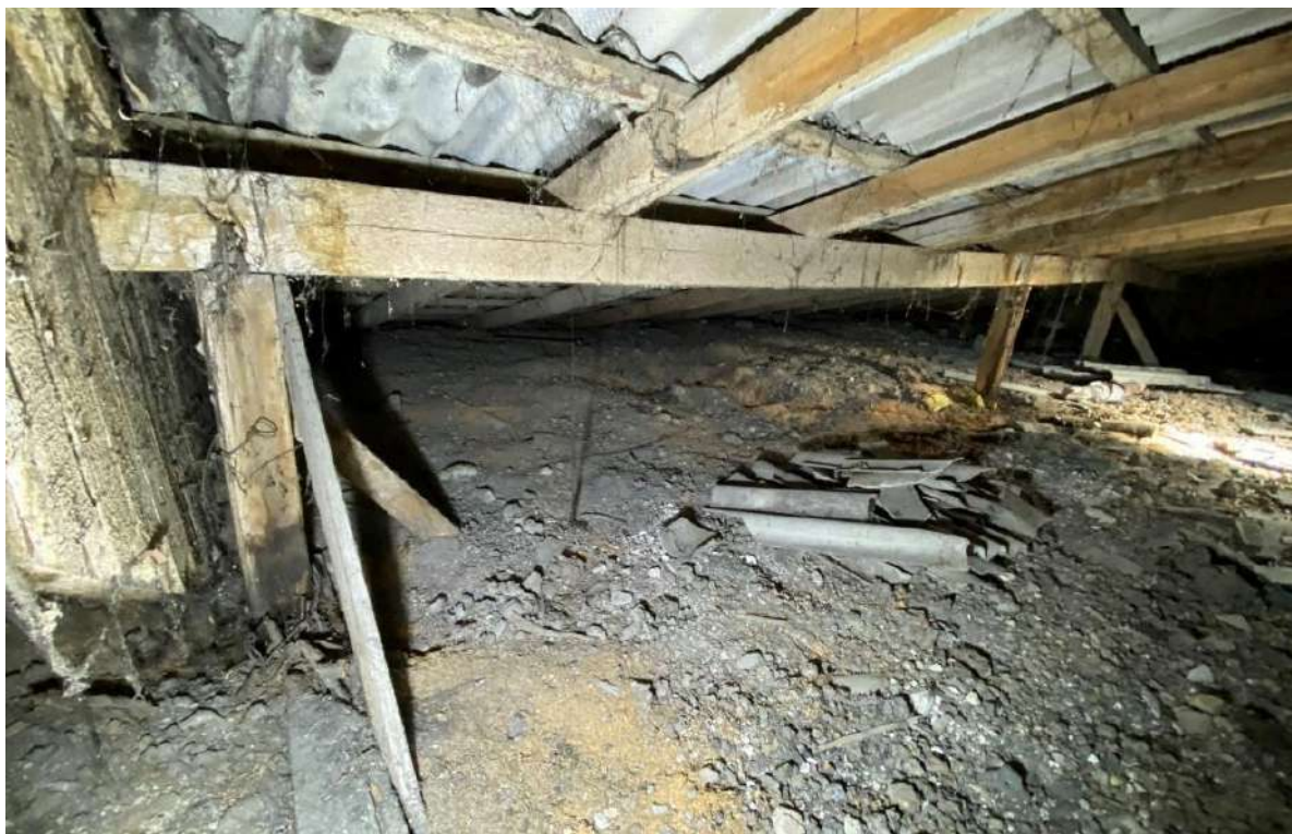
F - 49 Ēkas centrālās daļas (Rīgas ielas pusē) jumta konstrukciju kopturis deformējies, tā statņu balstvietās redzami izteikti trupes bojājumi, koksnes sadalījusies, zaudējusi savu nestspēju
