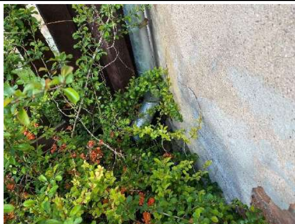
F - 72 Ēkas DR stūrī esošās notekcaurules gals nokrišņu ūdeni novada pie ēkas pamatiem, kur veidoti arī apstādījumi
