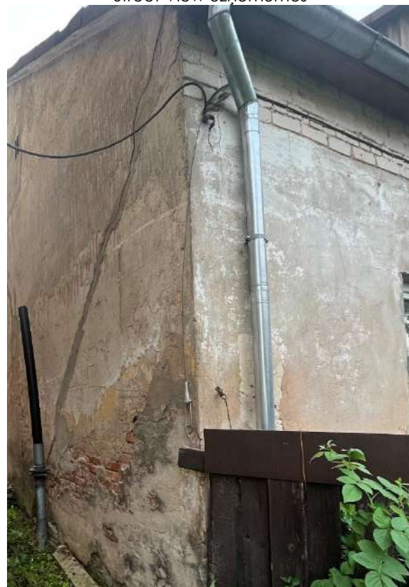
F - 32 Diagonālas plaisas, apdares bojājumi un mitruma piesātinājums ēkas R puses gala sienā. Plaisas liecina par ēkas daļu nevienmērīgu sēšanos, kas visticamāk saistīta ar pamatu/pamatnes izskalojumiem dēļ nesakārtotās nokrišņu novadīšanas šajā zonā
