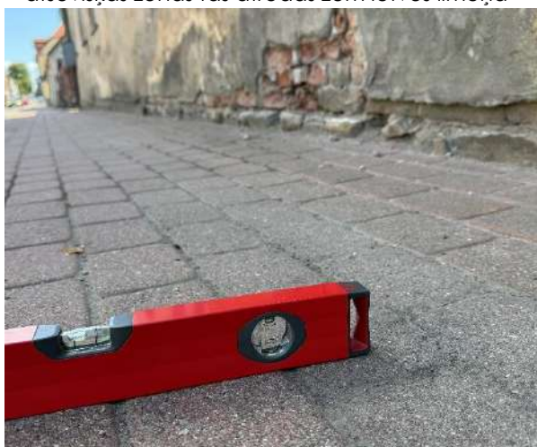
F - 4 Ne visur Rīgas ielas ietvei nodrošināts pietiekams kritums. Dažviet ietvei novērojams ačgārs kritums – virzienā uz ēkas pamatiem
