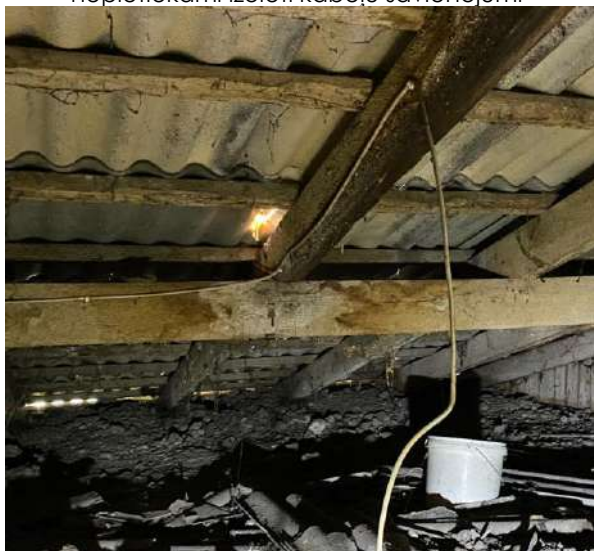
F - 109 Bēniņos pie jumta koka konstrukcijām stiprināti elektrokabeļi, dažviet tie nokarājas, nav atbilstoši nostiprināti
