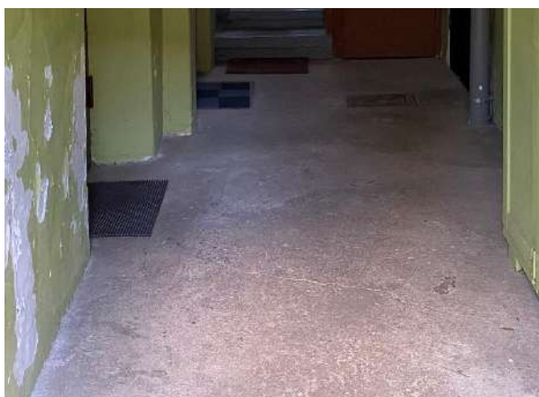
F - 85 Kāpņu telpā izbūvēta betonēta grīda, grīdā dažviet redzamas plaisas
