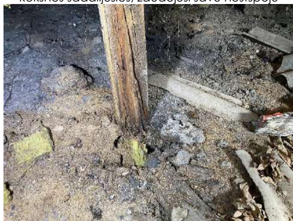
F - 54 Ēkas centrālās daļas (Rīgas ielas pusē) jumta konstrukciju kopturis deformējies, tā statņu balstvietās redzami izteikti trupes bojājumi, koknes sadalījusies, zaudējusi savu nestspēju
