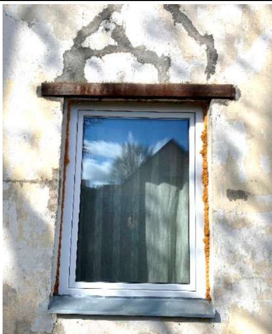
F - 92 Ēkas A gala fasādes logs. Pārsedze pastiprināta ar tērauda leņķdzelzi, logs iestrādāts ar celtniecības putām, tam izbūvēta skārda ārējā palodze
