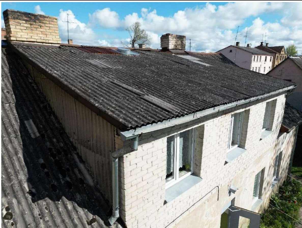
F - 48 Ēkas vidusdaļā esošajai otrā stāva jumta izbūvei lēzens jumts, segts ar azbestcimenta loksnēm. Pagalma puses lietus ūdens teknei redzamas deformācijas
