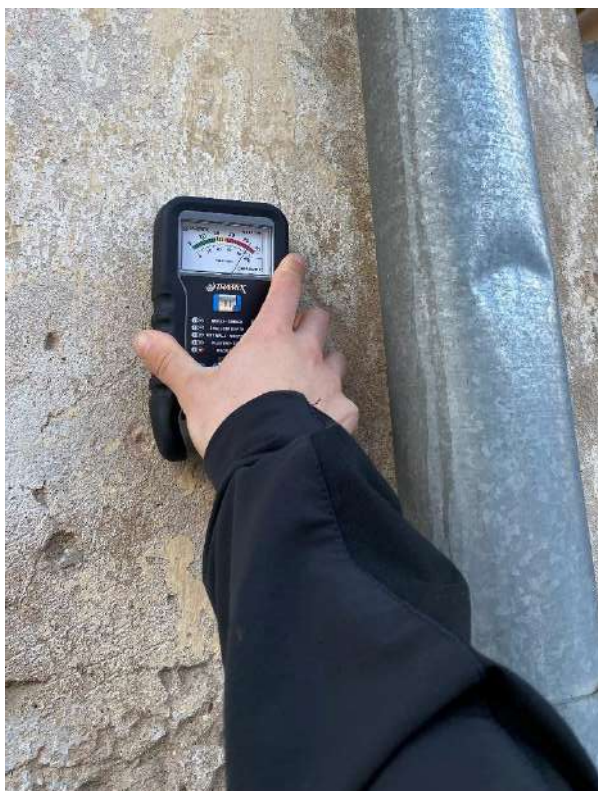
F - 7 Fasādes zonā ap ZR stūra notekcauruli novērojams īpaši izteikts mitruma piesātinājums līdz pat ~2m augstumam
