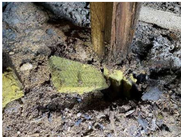
F - 46 Lokālās zonās, kur uz pārseguma balstītis jumta konstrukciju kopturis, redzami savulaik radušies mitruma bojājumi, nav izslēgts, ka trupējušas arī pārseguma konstrukcijas
