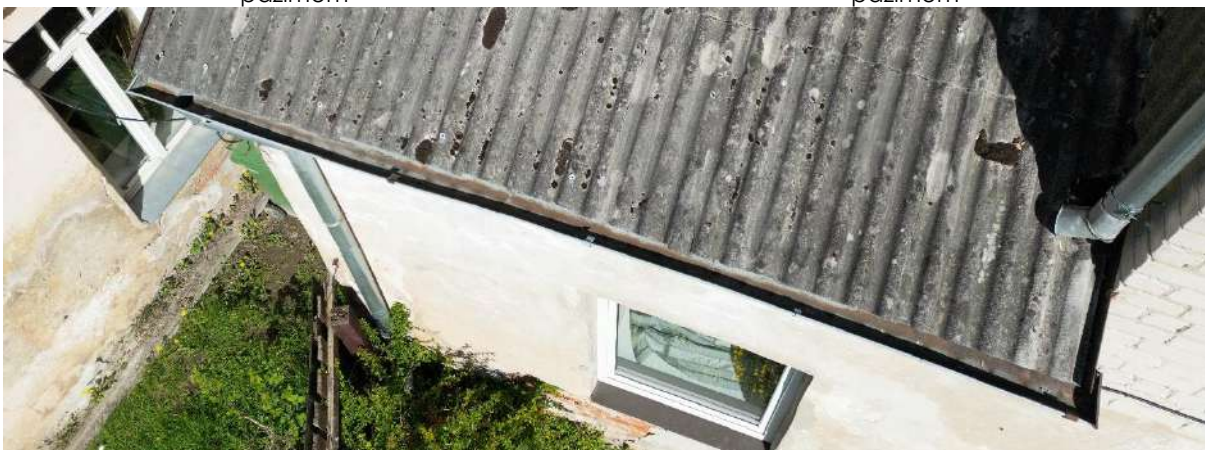
F - 75 Notekcaurules un teknes ar korozijas pazīmēm
