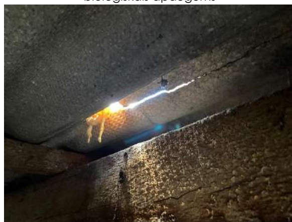
F - 64 Jumta seguma bojājumi skatā no bēniņiem, nokrišņu ūdens nonāk bēniņos
