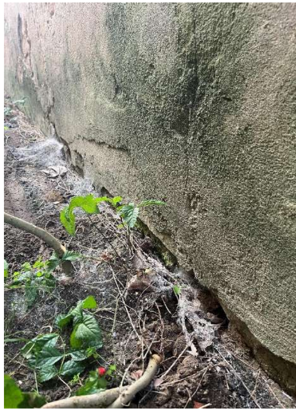
F - 18 Ēkas R gala fasādē cokols atrodas zem ēkai pieguļošās zemes līmeņa, šajā zonā notiek izteikta nokrišņu ūdens infiltrācija pamatos un sienā, teritorija starp ēkām nav kopta
