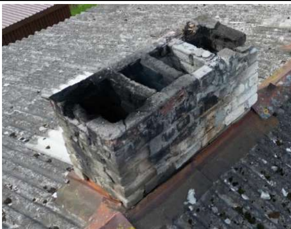
F - 101 Ēkas A puses skursteņa virsjumta daļā redzami izdrupumi, mūra erozija, nestabili mūra fragmenti, skurstenis nokvēpis
