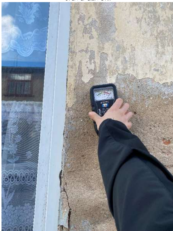
F - 35 Rīgas ielas fasādē mitruma piesātinājums ār sienās un fasāžu apdares bojājumi dažviet novērojami pat virs ~1,5m augstuma
