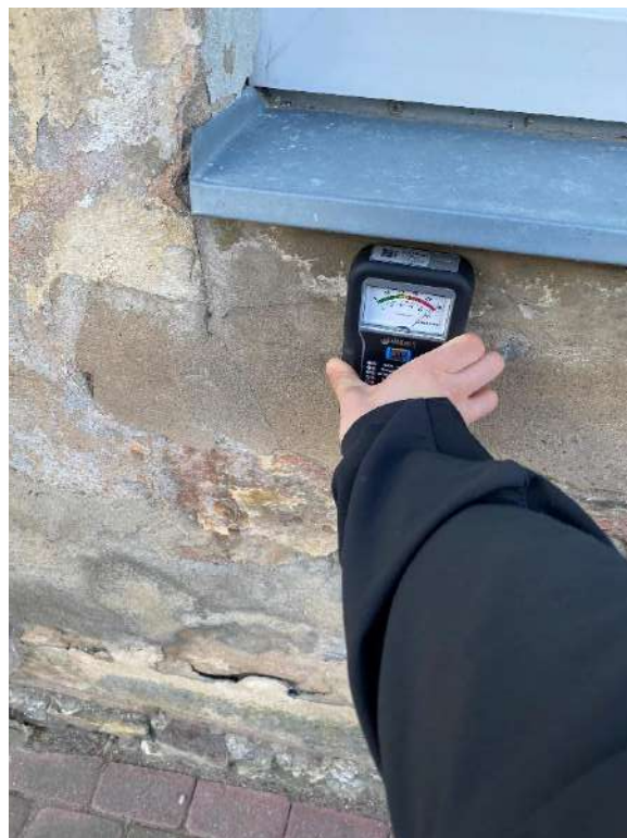
F - 36 Izteikts mitruma piesātinājums ēkas Rīgas ielas fasādē zonā zem loga līnijas
