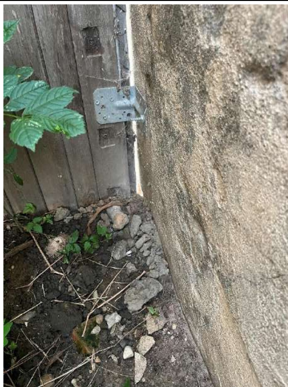
F - 20 Pie ēkas R fasādes esošais zemes līmenis laika gaitā pieaudzis, ēkas cokols atrodas zem zemes, kā rezultātā notiek nokrišņu ūdens infiltrācija ārsienā. Zonā starp ēku un īpašumu Rīgas ielā 8 nav sakārtota nokrišņu ūdens novadīšana
