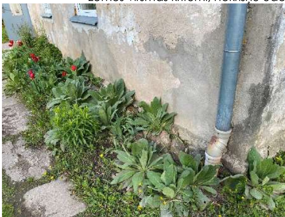
F - 13 Ēkas DA stūrī esošā lietus ūdens notekcaurule pieslēgta pazemes tīklam, gar pamatiem veidoti apstādījumi, nav izbūvēta nokrišņu novadapmale
