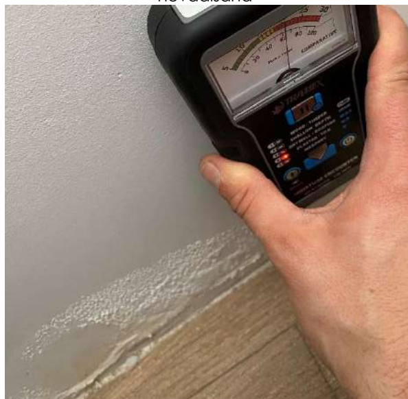
F - 22 Izsāļojumi, apdares bojājumi 1. stāva sienu lejas daļās redzami arī no telpu puses (zonās, kur sienas nesedz apšuvums)
