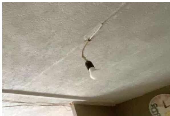
F - 108 Elektroinstalācijas nepilnības/defekti – nenostiprināti kabeli, gaismas ķermeņi, nepietiekami izolēti kabelu savienojumi
