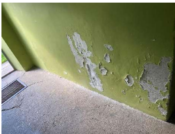
F - 115 Kāpņu telpas sienu lejas daļu apdare bojāta kapilārā mitruma iedarbības rezultātā
