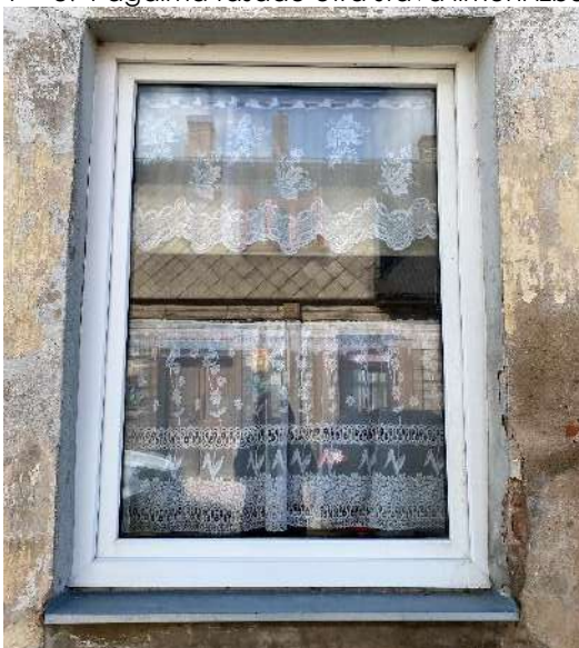
F - 90 Ēkas Rīgas ielas fasādē pirmā stāva līmenī izbūvēti PVC pakešlogi bez daļījuma
