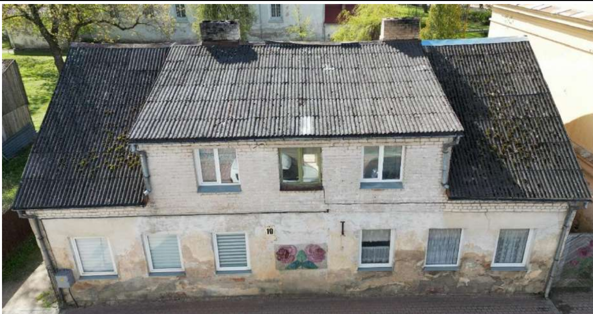
F - 24 Skats uz ēku no Rīgas ielas. Pirmajā stāvā apmestas māla ķieģeļu mūra ārsienas, otrajā stāvā – neapmests silikātķieģeļu mūris. Sienu lejas daļās izteikts mitruma piesātinājums, bojāta apdare
