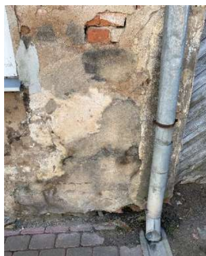
F - 5 Fasādes zonā ap ZR stūra notekcauruli novērojams īpaši izteikts mitruma piesātinājums līdz pat ~2m augstumam
