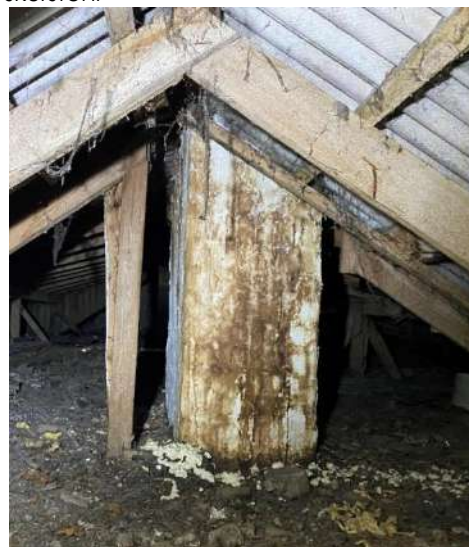
F - 100 Bēniņos uz skursteņiem redzami izteikti notecējumi, izsvīdumi
