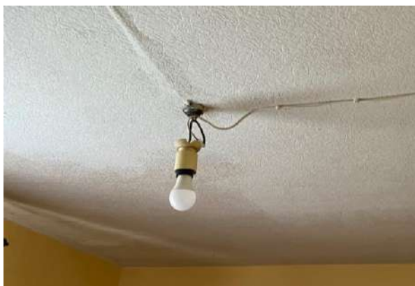
F - 107 Elektroinstalācijas nepilnības/defekti – nenostiprināti kabeli, gaismas ķermeņi, nepietiekami izolēti kabelu savienojumi
