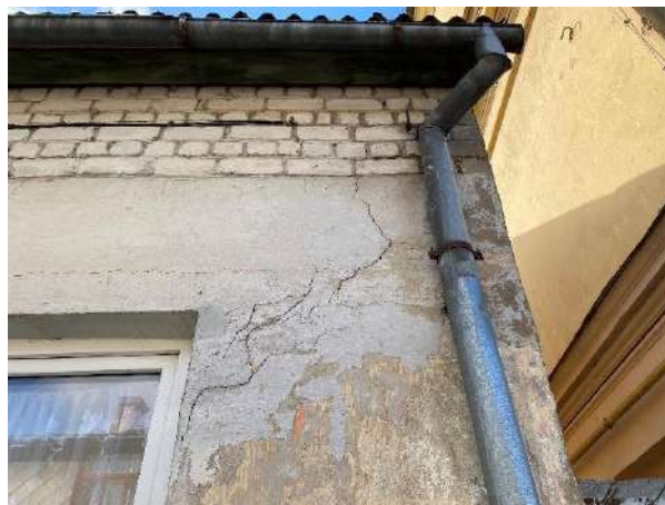
F - 124 Fasāžu apdarē vairākās vietās redzamas plaisas, nolietojies, bojāts krāsojums
