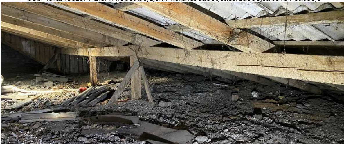
F - 50 Ēkas centrālās daļas (Rīgas ielas pusē) jumta konstrukciju kopturis deformējies, tā statņu balstvietās redzami izteikti trupes bojājumi, koksnes sadalījusies, zaudējusi savu nestspēju
