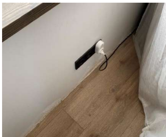
F - 116 Pirmā stāva dzīvokļa iekšējā apdare sienas lejas daļā bojāta kapilārā mitruma iedarbības rezultātā
