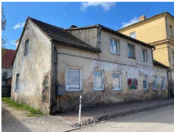
F - 123 Ēkas fasādes skatā no Rīgas ielas. Apdare ievērojami bojāta mitruma iedarbības rezultātā
