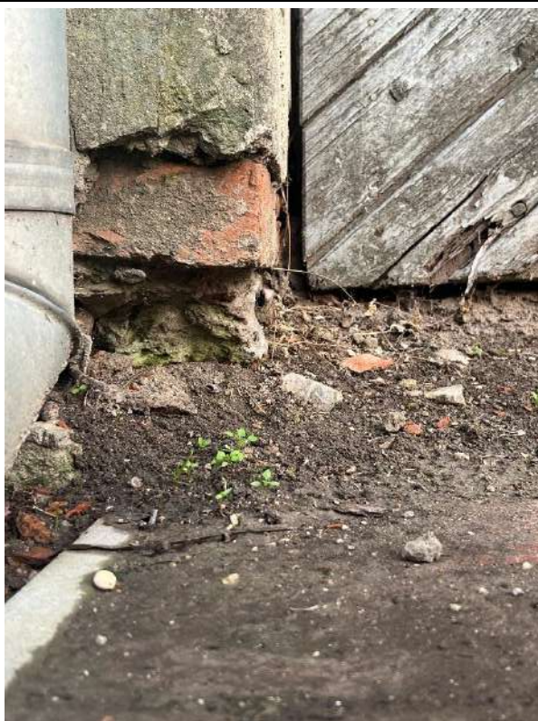
F - 19 Ēkas ZR stūrī ēkas cokols atrodas zem zemes līmeņa. Zemes līmenis gar R fasādi ievērojami augstāks par ietves līmeni
