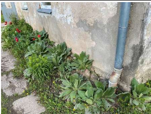
F - 71 Ēkas DA stūrī esošā lietus ūdens notekcaurule pieslēgta pazemes fīklam. Pagalma pusē gar ēkas pamatiem veidoti apstādījumi
