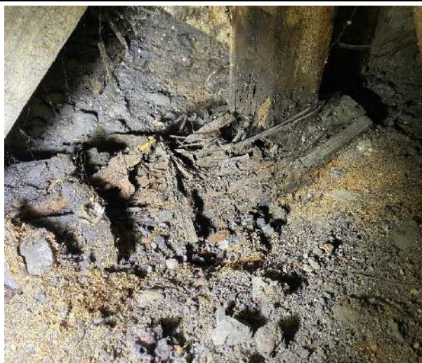
F - 52 Ēkas centrālās daļas (Rīgas ielas pusē) jumta konstrukciju kopturis deformējies, tā statņu balstvietās redzami izteikti trupes bojājumi, koknes sadalījusies, zaudējusi savu nestspēju
