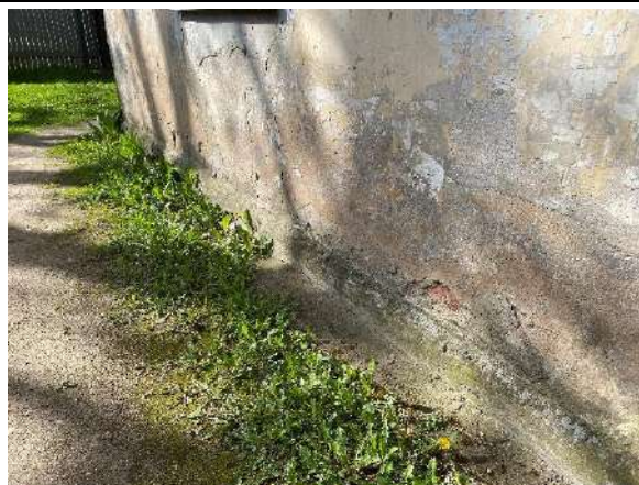
F - 10 Ēkas A puses fasādē fragmentāri izbūvēta betona nokrišņu novadapmale, gar pamatiem veidojas veģetācija, nav nodrošināti atbilstoši pieguļošas zemes kritumi
