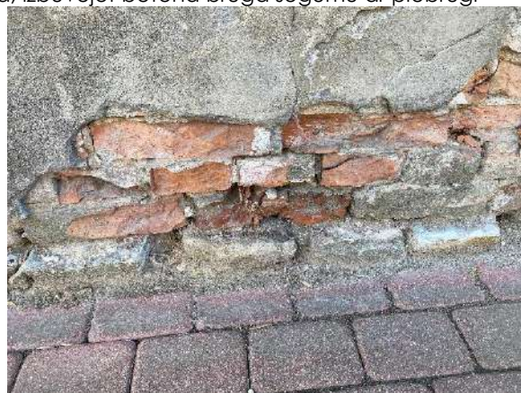
F - 3 Cokola un sienu lejas daļā redzami ne tikai apdares bojājumi, bet arī mūra erozija
