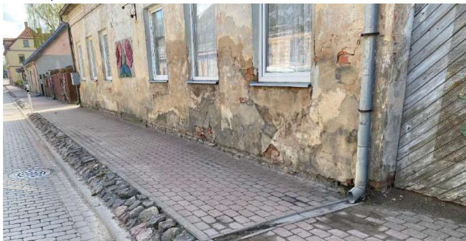
F - 1 Ēkas Rīgas ielas fasādes fragments. Sienas lejas daļā redzami izteikti mitruma radīti bojājumi, ilgstoši notikusi mitruma migrācija mūrī. Apdare ievērojami bojāta, vairākās zonās atdalījusies, zudusi. Rīgas ielas ietves segumam veikta rekonstrukcija, izbūvējot betona bruģa segumu ar piebruģi
