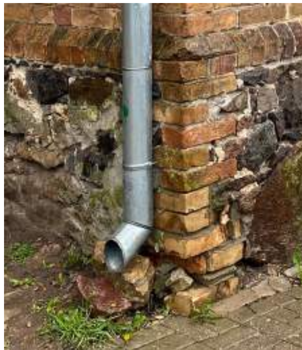
F - 138 Ēkas DA stūrī nokrišņu ūdens nonāk uz cokola. Cokola stūrī redzami mūra izdrupumi
