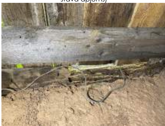
F - 97 Koka konstrukciju trupes bojājumi Z puses zeltiņa apakšdaļā
