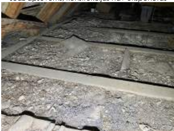
F - 77 Pirmā stāva pārseguma sijas skatā no bēniņiem
