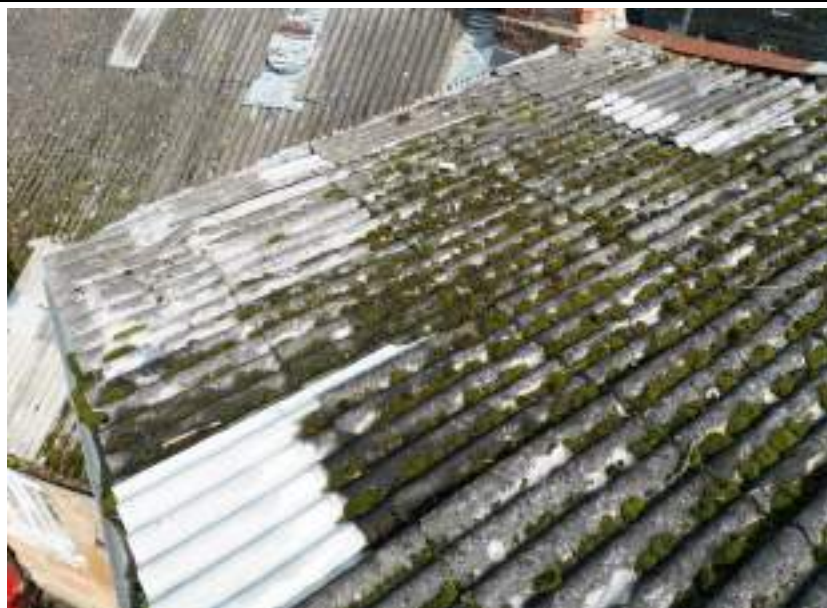
F - 106 Ēkas 2. stāva apjoma jumts. Uz seguma izteikts sūnu apaugums, vairākas loksnes bojātas, atsevišķas loksnes mainītas. Lietus ūdens tehnē uzkrājas sūnas, tā ir netīra, pilnvērtīgi nefunkcionē
