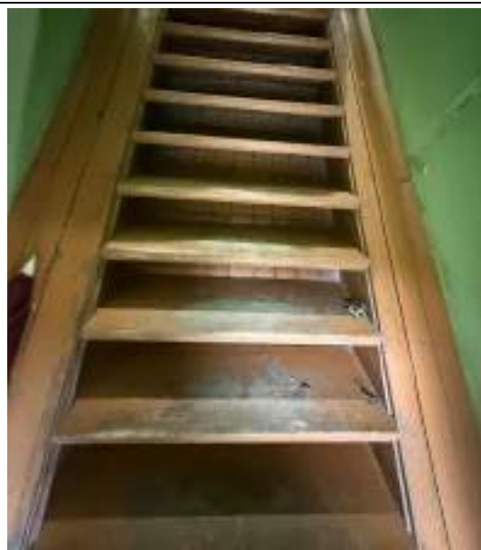
F - 140 Kāpņu telpas koka kāpnes. Pakāpieniem un starplaukumam nolietojies krāsojums
