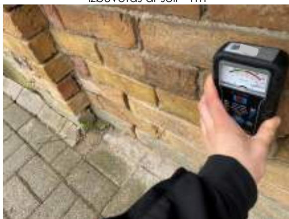
F - 44 Cokla daļās mūrī paaugstināts mitruma piesātinājums
