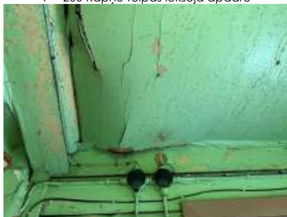
F - 202 Atsevišķās zonās griestu apšuvuma loksnes deformējušās, ielūzušās
