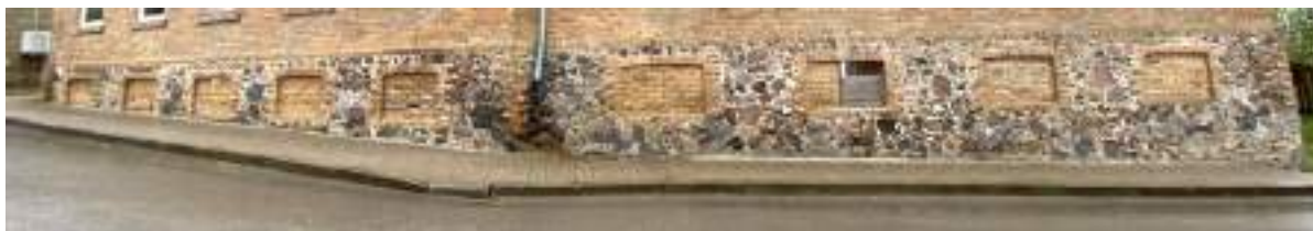
F - 1 Ēkas virspamati (cokols) Baznīcas ielas fasādēs. Zudis notekcaurules gals, nokrišņu ūdens tiek novadīts uz cokola, radot saistvielas izskalojumus, mūra eroziju
