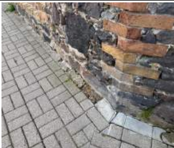
F - 5 Ielas segums zonā pieslēgumvietās cokolam vairākās zonās bojāts, ar izdrupumiem, u.c. bojājumiem
