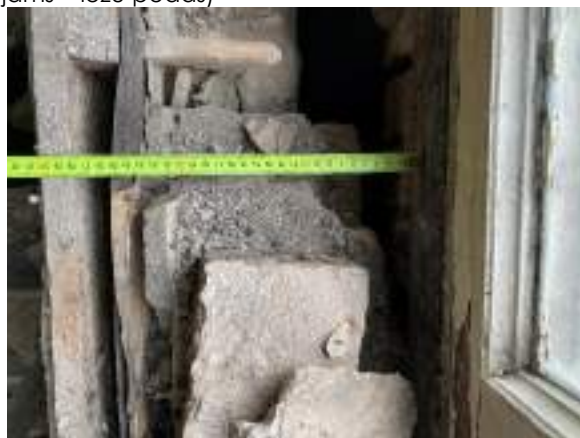
F - 38 Zonā, kur demontēta iekšējā palodze, izveidots atsegums, kurā redzams ārsienas sastāvs
