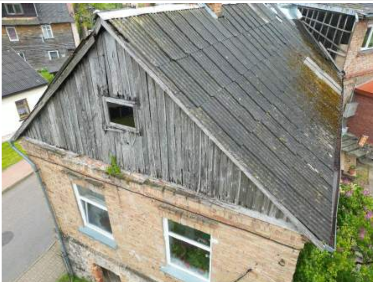
F - 205 Ēkas Z puses gala fasādes zelminim koka dēļu apšuvums. Dēļi vairākās zonās bojāti. Starpdzegai zudis lāsenis, redzami ķieģeļu izdrupumi, starpdzegā ieaudzis koks
