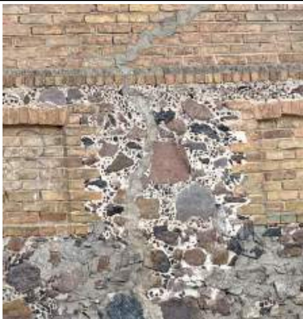
F - 22 Cokolā un sienā esošā plaisa ēkas Baznīcas ielas fasādes Z daļā savulaik aizpildīta ar cementa bāzes javu
