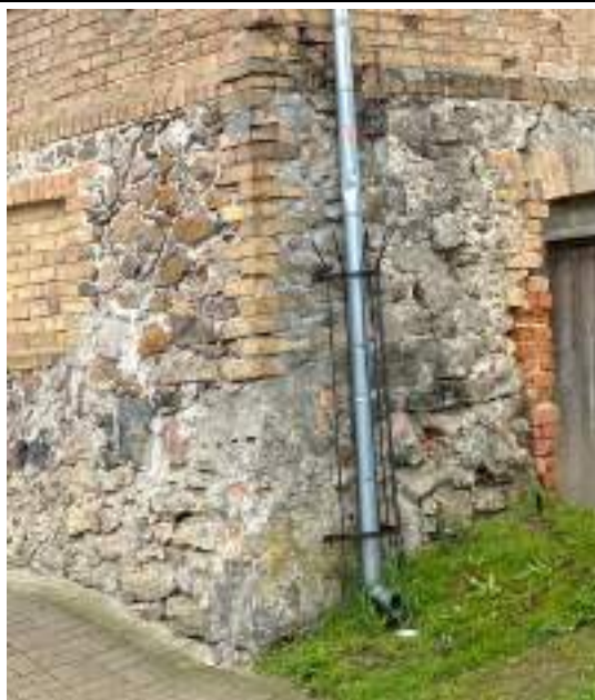
F - 23 Ēkas Z stūrī savulaik veikti lokāli mūra remontdarbi, t.sk. lietojot cementa bāzes javu
