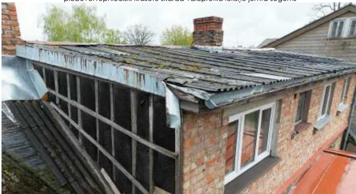
F - 117 Ēkas 2. stāva apjoma jumtam korodējusi, atrauta skārda vējmala. Uz lēzenā jumta veidojas sūnu apaugums
