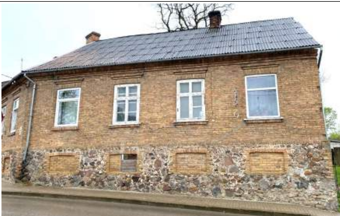
F - 27 Ēkas Baznīcas ielas fasādes Z daļa. Mūrī vairākās zonās redzamas izteiktas plaisas
