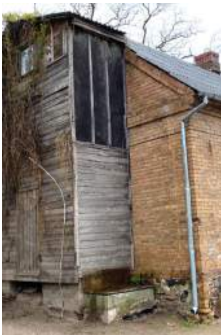
F - 137 Kāpņu telpas apjoma jumta plaknei pret Baznīcas ielu nav izbūvēta lietussūknis notek sistēma, nokrišņu ūdens notek pie cokola, šļakatu veidā nonāk uz cokola un sienām
