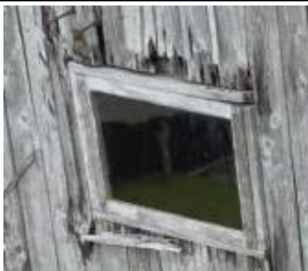
F - 163 Ēkas Z puses zeminī izbūvēts logs koka rāmī. Zonā ap logu trupējies dēļu apšuvums
