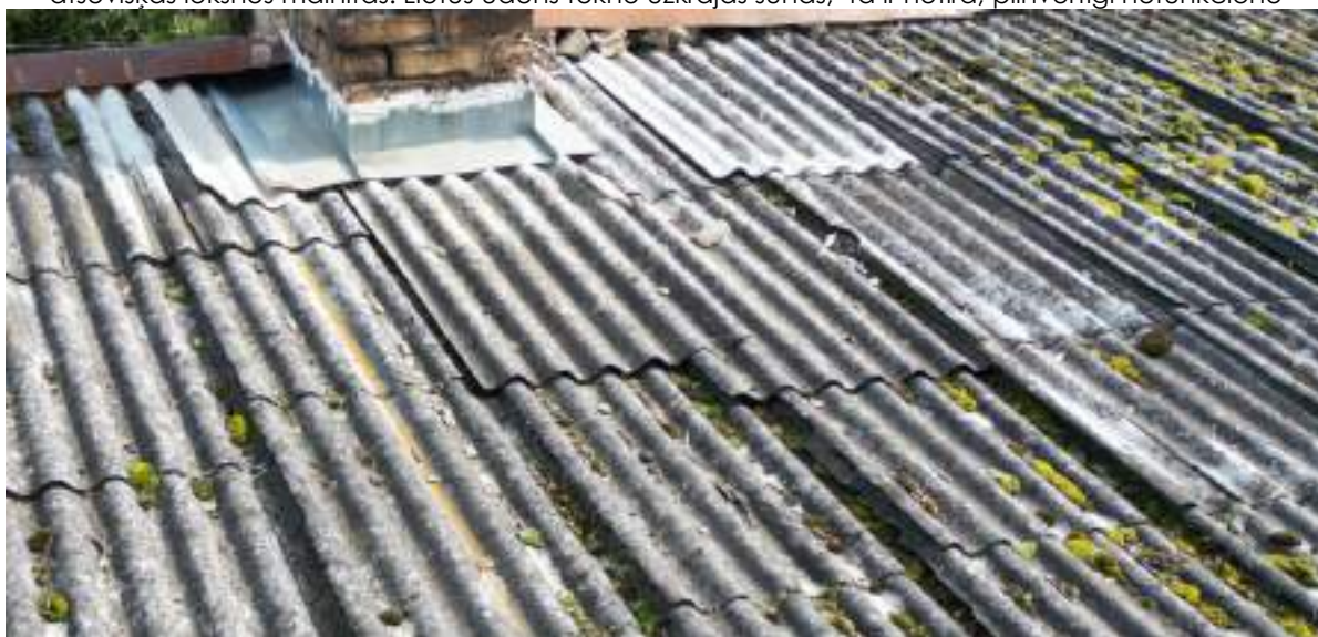
F - 107 Ēkas 2. stāva apjoma jumtam seguma loksnes dažviet blīvi nepieguļ, uz seguma veidojas sūnu apaugums. Zem šīs zonas nokrišņu ūdens nonāk uz 2. stāva dzīvokļa virtuves telpas griestu apdares
