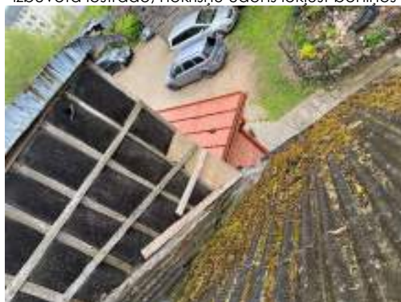
F - 115 Uz pagalma puses jumta plaknes veidojas sūnu apaugums, korodējuši skārda elementi
