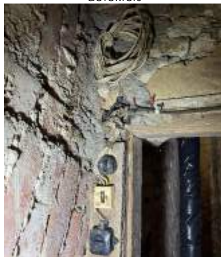
F - 190 Kabeļi ar bojātu izolāciju, sadales kārbai zudis nosegvāks, bojāti slēdži, nav demontēti neizmantojamie kabeļi ēkas pagraba telpā
