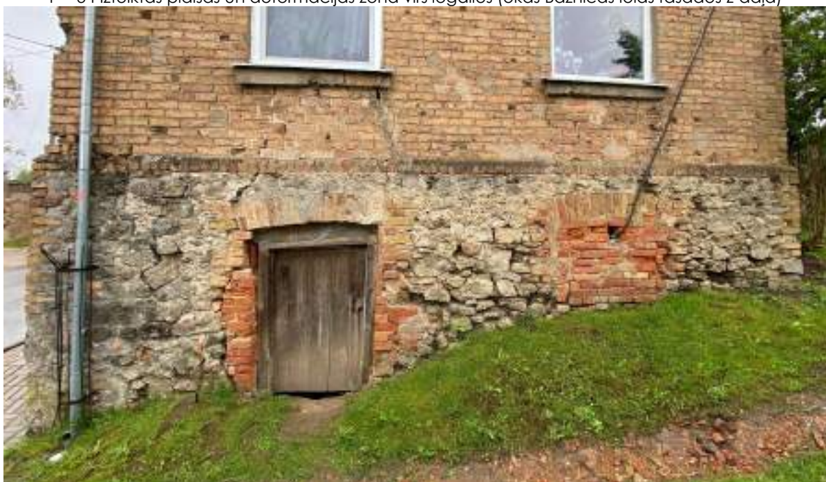
F - 35 Ēkas Z puses gala fasādē redzama izteikta mūra erozija cokola daļā, plaisas un deformācijas zonā ap pagraba ieeju, plaisas zonā starp durvju aili un 1. stāva logaili, mehāniski bojājumi mūrī (iespējams – ložu pēdas)
