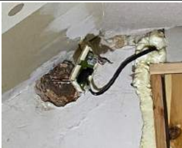
F - 187 Neatbilstoši kabeļu stiprinājumi, savienojumi ēkas 2. stāvā
