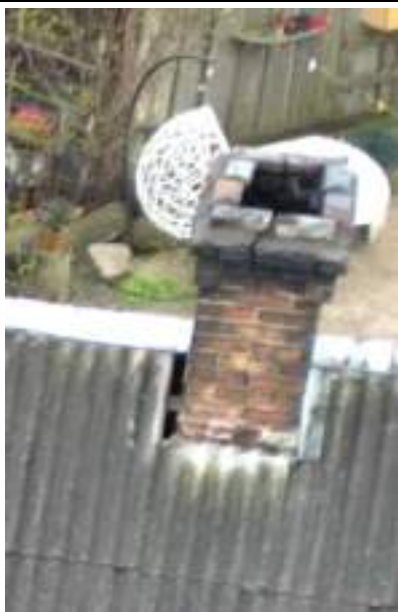
F - 176 Zonā, kur jumta Z puses skurstenis šķērso jumta segumu, nav izbūvēta vai zudusi skursteņa iestrāde
