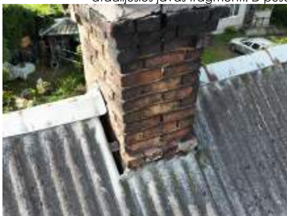
F - 112 Z puses skurstenim Baznīcas ielas pusē nav izbūvēta iestrāde, nokrišņu ūdens iekļūst bēniņos
