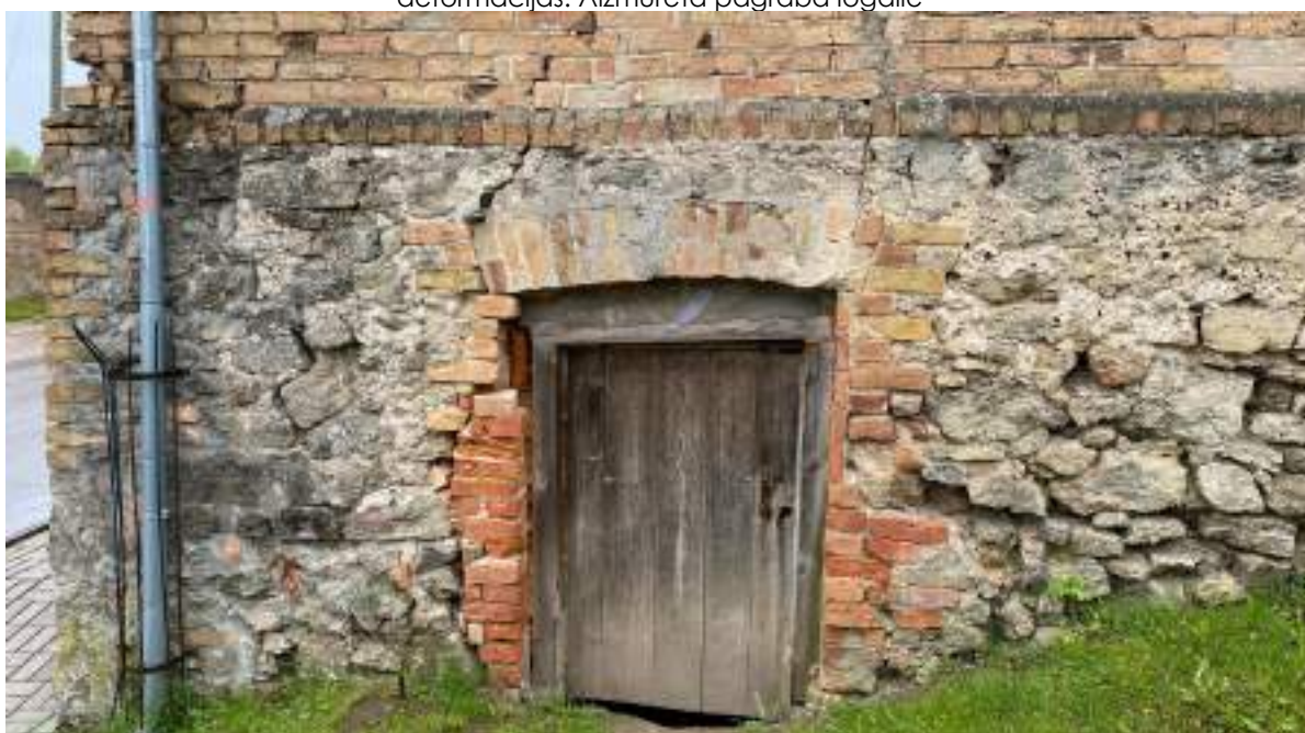
F - 20 Ēkas Z gala fasādē cokolā izteikta mūra erozija – saistvielas izskalojumi, plaisas, deformācijas. Izteikti bojājumi redzami zonā ap durvju aili. Durvju ailes pārsedzes zonā redzama izteikta plaisa, šajā zonā caurejoša plaisa redzama arī pagraba pārseguma velvēs. Durvju lejas daļā nokrišņu ūdens ieplūst pagrabā. Redzams, ka ēkas stūrī savulaik veikti lokāli mūra labojumi, t.sk. ar cementa javu
