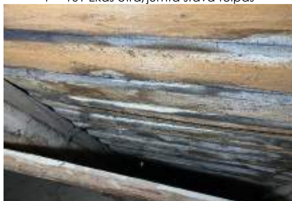
F - 103 Vairākās zonās uz dēļu klāja redzami notecējumi, kas liecina par jumta seguma bojājumiem
