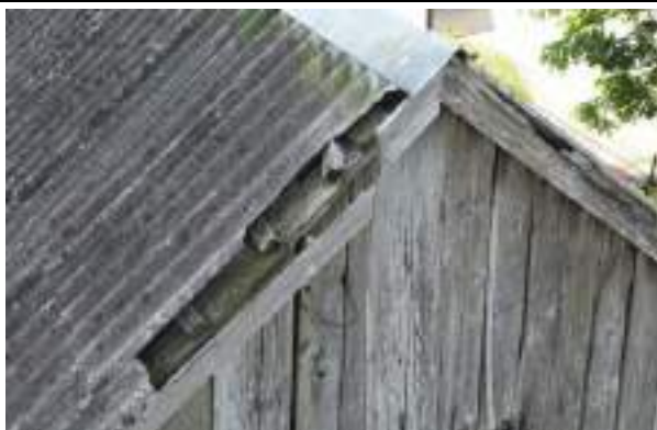
F - 118 Jumta Z puses zelminim bojāts vējdēlis, jumta segums šajā zonā
