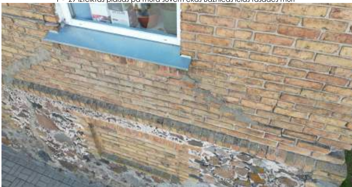
F - 30 Plaisas un deformācijas (nobīdes no vertikāles) mūrī ēkas Baznīcas ielas fasādes Z daļā. Plaisas savulaik aizpildītas/aizziestas, t.sk. lietojot cementa javu
