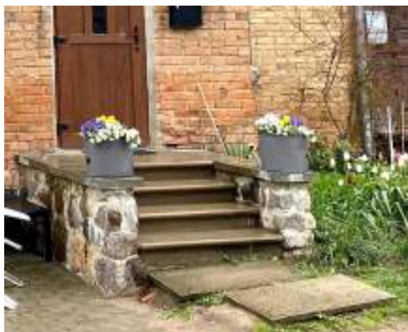
F - 141 Pirmā stāva piebūves kāpnes. Kāpņu laukumam, kura augstums pārsniedz 45cm, nav izbūvētas margas
