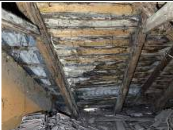
F - 94 Vairākās zonās uz dēļu klāja redzami izteikti notecējumi, trupes sēņu attīstība, dēļi trupējuši (pagalma puses jumta zona, kur pieslēdzas 2. stāva apjoms)
