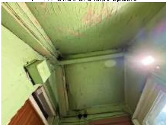
F - 201 Kāpņu telpas griestu apdare nolietojusies, bojāta
