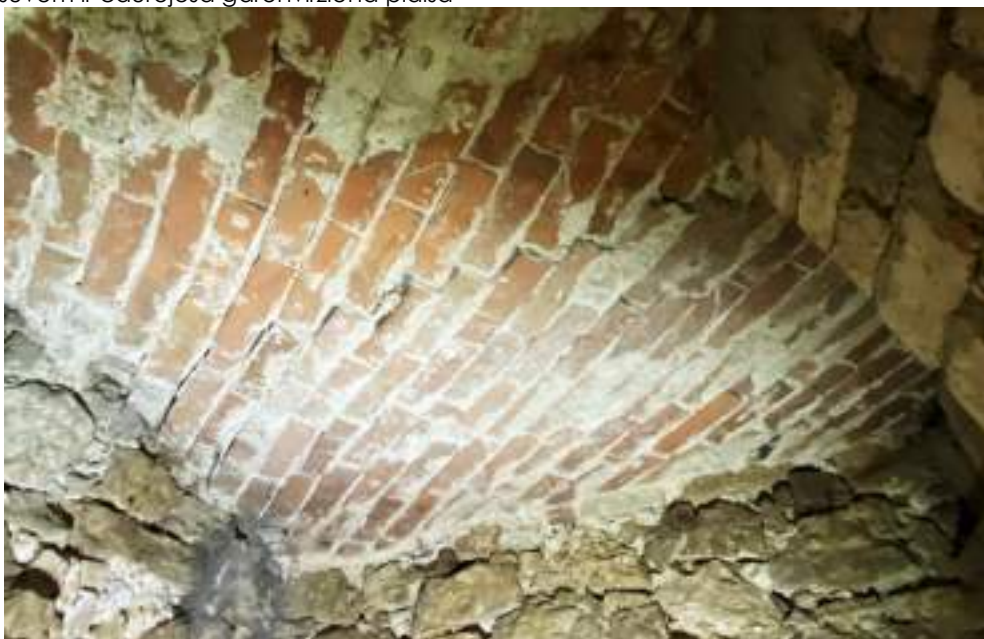
F - 72 Pagraba telpā Nr. 903-1 papildus balstkonstrukcija izbūvēta zonā, kur velvē pa mūra šuvēm ir caurejoša garenvirziena plaisa
