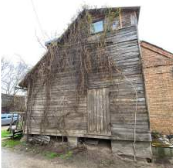
F - 209 Uz kāpņu telpas apjoma D puses fasādes un jumta aug vītenaugs, fasāžu dēļu apšuvums nolietojies, dažviet bojāts
