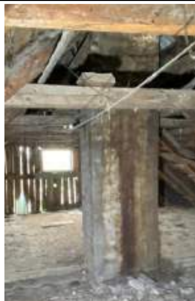
F - 178 Bēniņu daļā uz skursteņa redzami notecējumi
