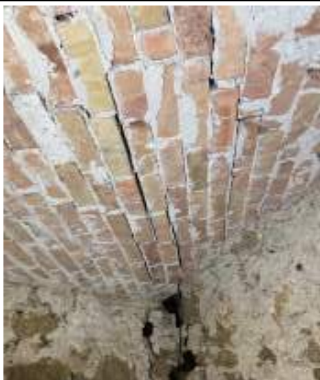
F - 63 Pagraba pārseguma velve telpā Nr. 903-3. Velvē redzamas izteiktas deformācijas, caurejošas plaisas pa mūra šuvēm
