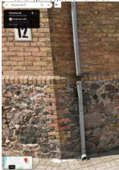
F - 136 Google Street View 2021. g. uzņēmumā redzams, ka jau iepriekš šajā zonā notekcaurule bijusi bojāta
