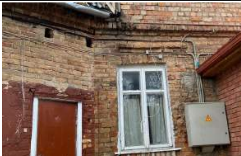
F - 192 Pagalma fasādē stiprināti, nokarājas dažādi kabelji, t.sk. neizolēti kabelju gali
