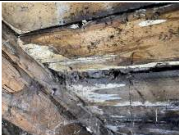
F - 95 Vairākās zonās uz dēļu klāja redzami izteikti notecējumi, trupes sēņu attīstība, dēļi trupējuši (pagalma puses jumta zona, kur pieslēdzas 2. stāva apjoms)
