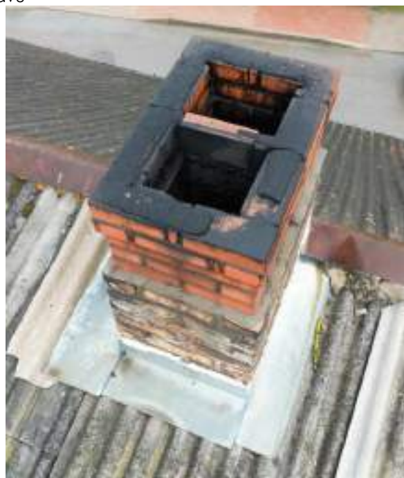
F - 183 Jumta D daļas skurstenim augšdaļā redzami javas izdrupumi, skurstenis nokvēpīs, iekšpusē to klāj sodrēji
