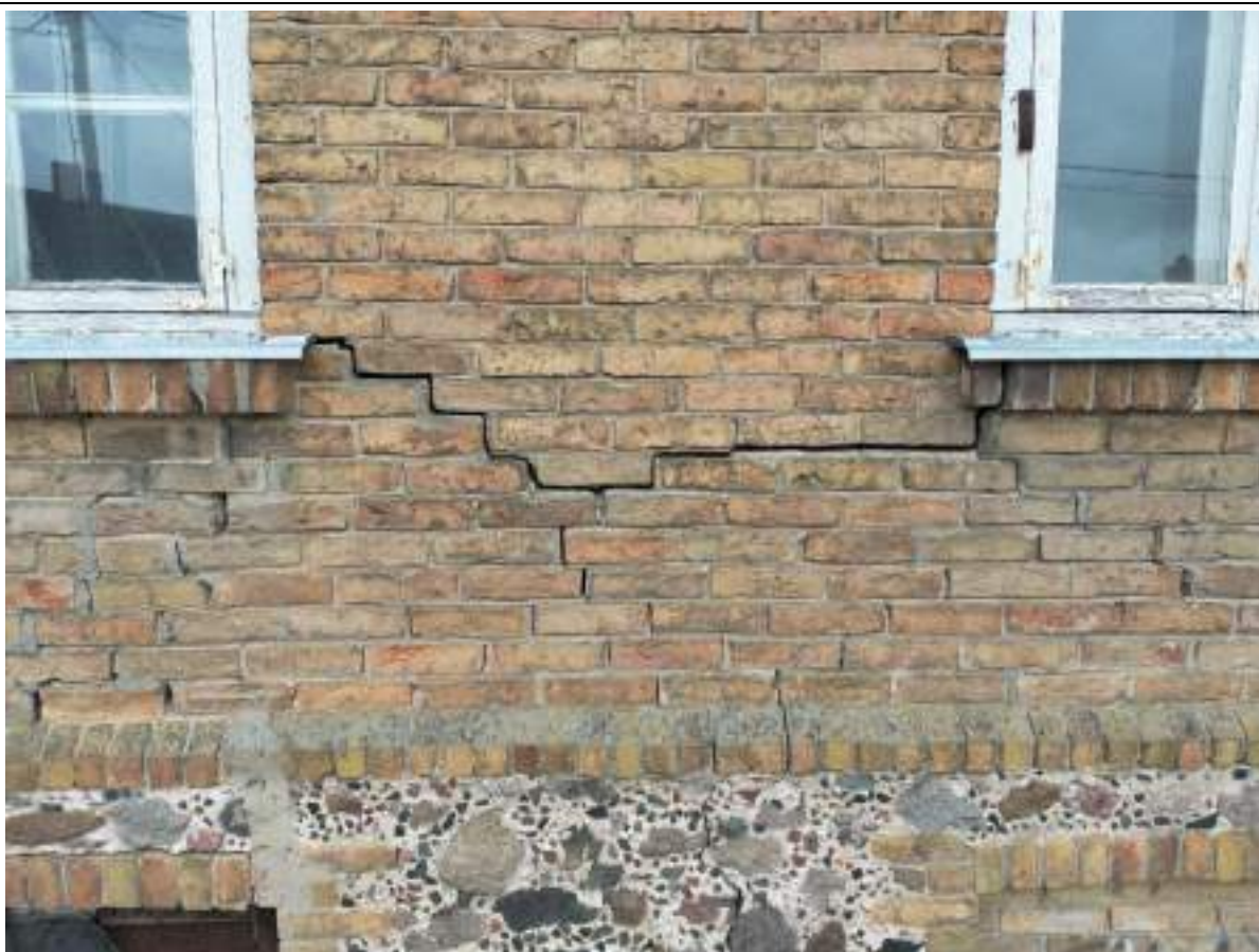
F - 29 Izteiktas plaisas pa mūra šuvēm ēkas Baznīcas ielas fasādes mūrī
