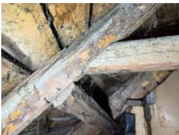
F - 90 Koka konstrukcijās, kas nav mizotas, mizā redzami koksnes kaitēkļu radīti bojājumi
