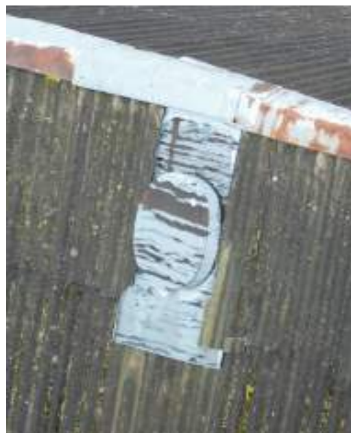
F - 170 Uz skārda lūkas, tāpat, kā uz citiem jumta skārda elementiem, veidojas korozija
