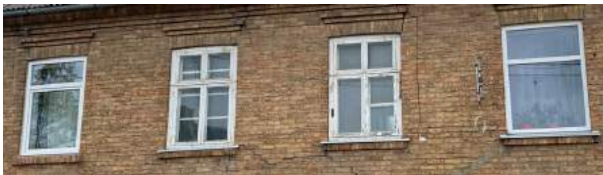
F - 155 Baznīcas ielas fasādē lielākā daļa no vēsturiskajiem koka logiem nomainīti uz PVC konstrukcijas stikla pakešu logiem, nesaglabājot vēsturisko rūšu dalījumu. Saglabājušies divi koka logi
