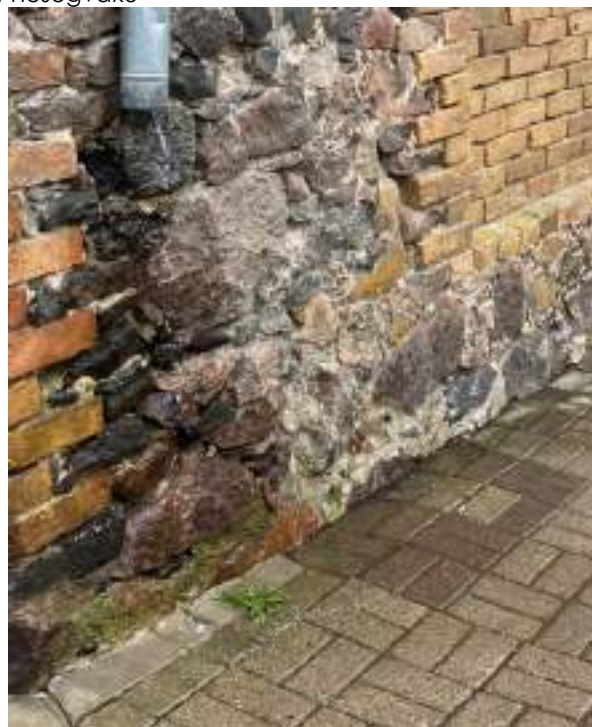
F - 4 Šajā zonā ietves segums iegrimis, veidojot ačgārnu slīpumu – virzienā uz pamatiem
