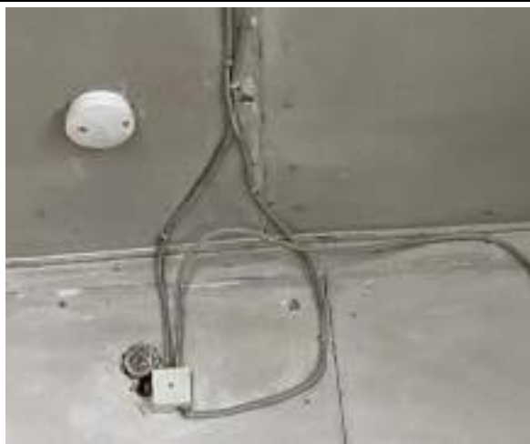
F - 188 Nenostiprināti kabeļi ar bojātu izolāciju dzīvoklī Nr. 9. Pie griestiem izbūvēts dūmu detektors
