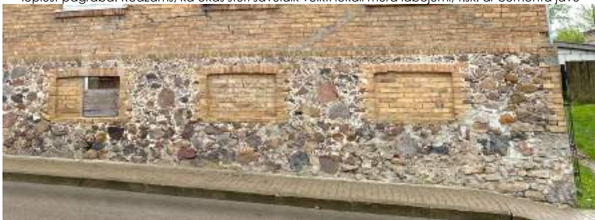
F - 21 Ēkas Z daļā cokolā un sienās redzamas plaisas, deformācijas, savulaik veikti lokāli plaisu aizpildīšanas un mūra šuvju atjaunošanas pasākumi, t.sk. lietojot cementa javu
