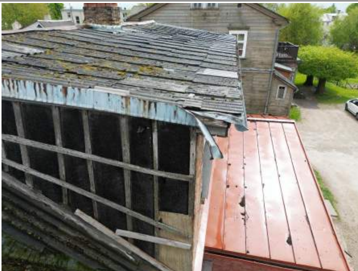
F - 116 Ēkas 2. stāva apjoma jumtam korodējusi, atrauta skārda vējmala. Pirmā stāva ieejas mezgla piebūvei rūpnieciski krāsotu skārda valcprofila lokšņu jumta segums
