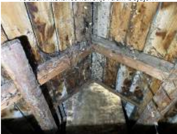
F - 92 Spāru savienojums korē. Skursteņa pieslēgumvieta jumtam nav hermētiska, uz dēļu klāja redzami notecējumi
