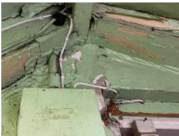
F - 184 Neatbilstoši izolēti kabeļu savienojumi kāpņu telpā
