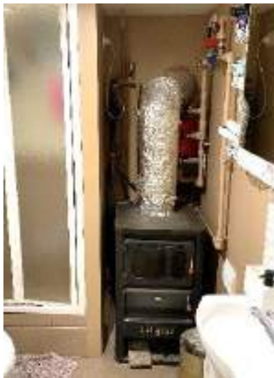
F - 171 Malkas krāsns 1. stāva dzīvoklī
