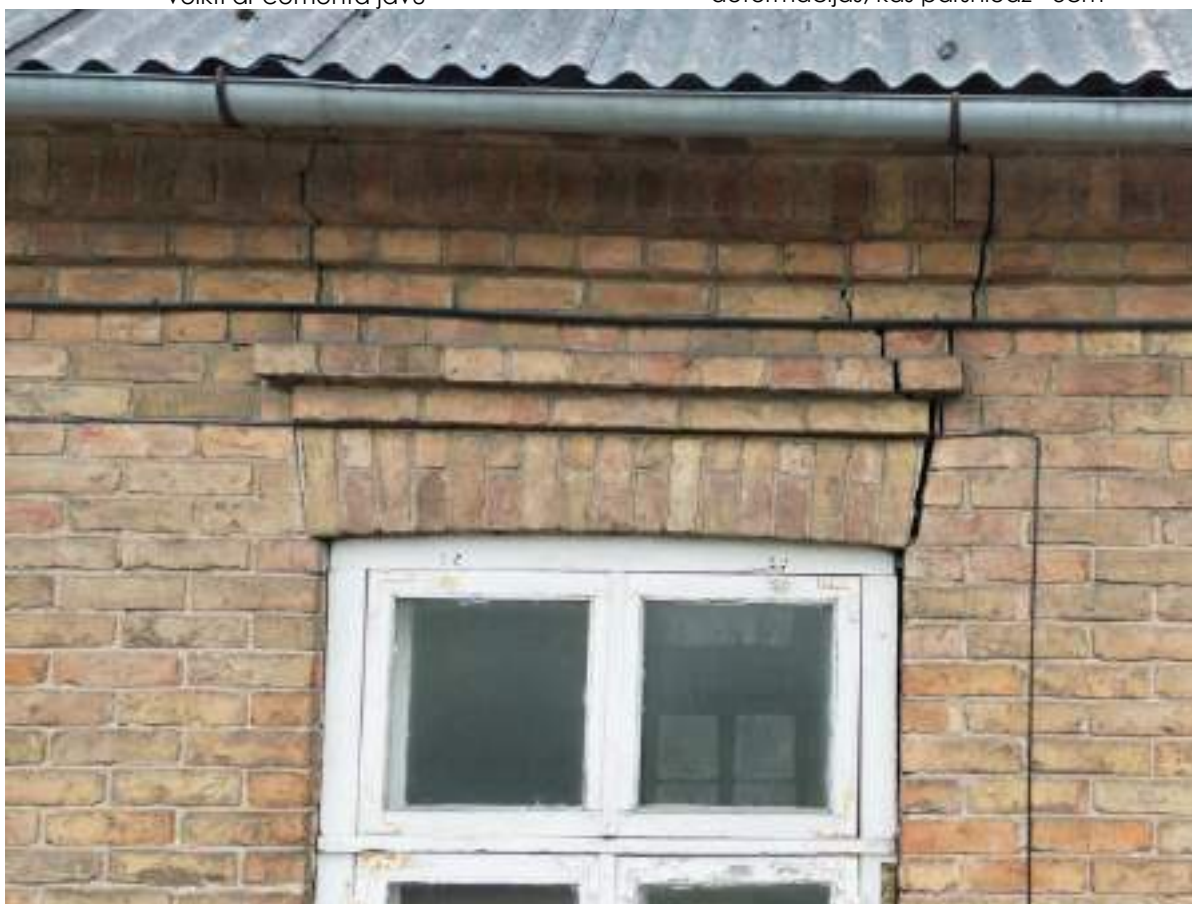
F - 33 Izteiktas plaisas un deformācijas zonā virs logailes (ēkas Baznīcas ielas fasādes Z daļā)
