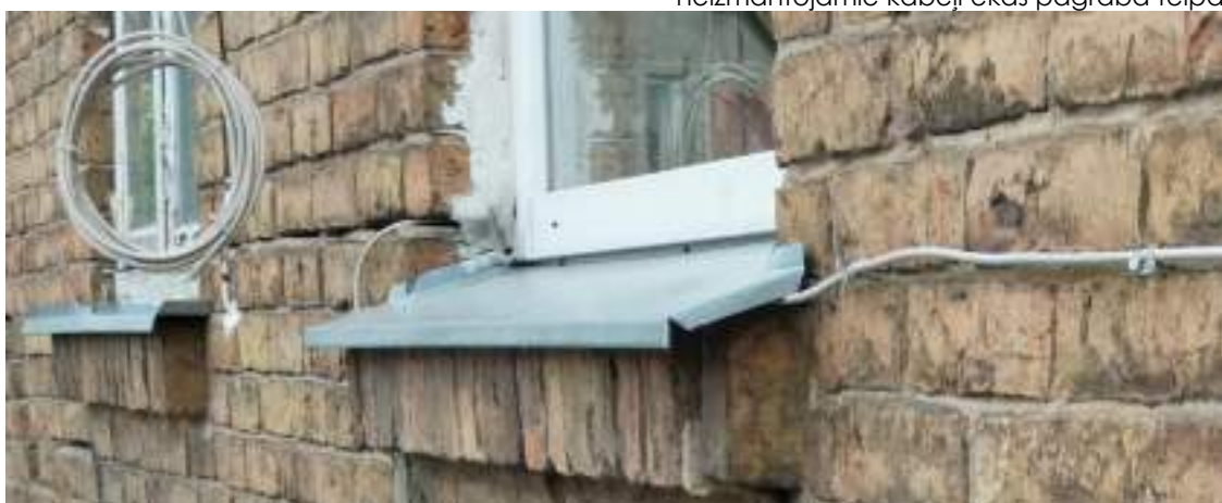
F - 191 Ēkas Baznīcas ielas fasādē stiprināti, nokarājas kabeļi, kabeļi vilkti arī caur plaisām ēkas ārsienā
