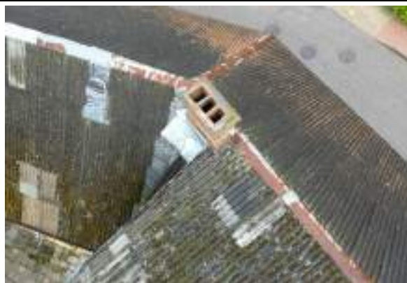
F - 110 Jumta kores segtas ar skārdu, skārda nosegelementi korodējuši, dažviet deformējušies
