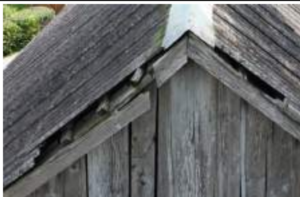
F - 119 Jumta Z puses zelminim bojāts vējdēlis, jumta segums šajā zonā
