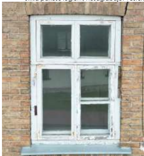
F - 156 Koka groplogam nolietojies krāsojums, korodējušas metāla detaļas
