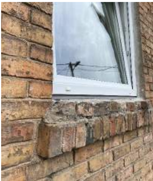
F - 158 Daļai logu nav izbūvētas ārējās palodzes
