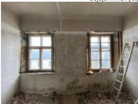
F - 37 Skats uz ēkas ārsienu no telpas Nr. 003-5 puses. Logiem demontētas iekšējās palodzes un ailu apdare
