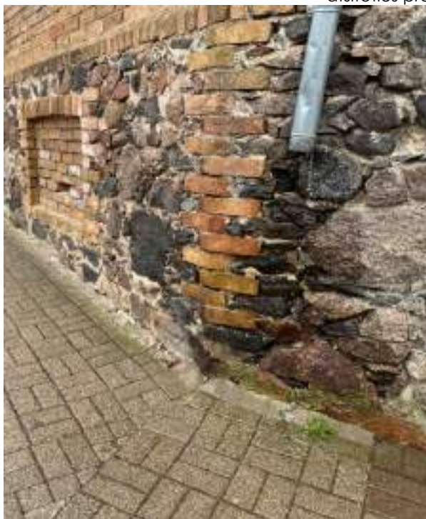
F - 3 Baznīcas ielas fasādē zudis notekcaurules gals, ūdens tiek novadīts uz cokola, veicinot mūra eroziju
