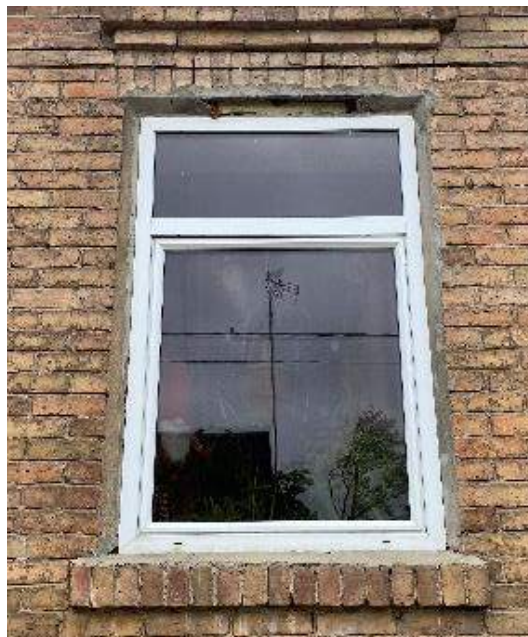
F - 159 Daļai logu nav izbūvētas ārējās palodzes, nav pilnvērtīgi atjaunota ailu ārējā apdare
