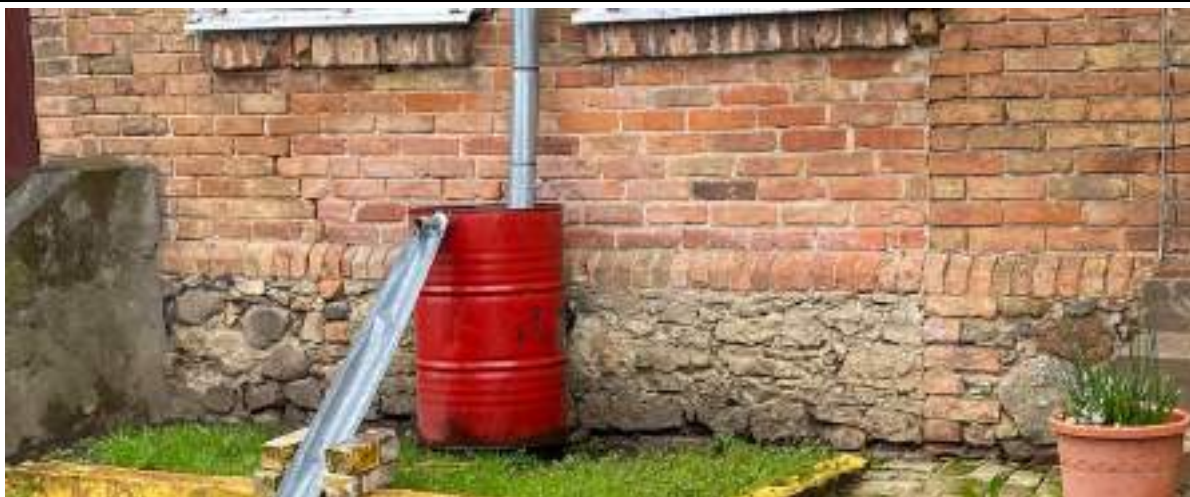
F - 46 Pagalma fasādē arī dažviet redzamas plaisas mūra šuvēs, redzams, ka savulaik veiktas pārbūves, par to liecina ķieģeļu mūra savienojumi, atšķirīgais mūra raksturs dažādās cokola zonā
