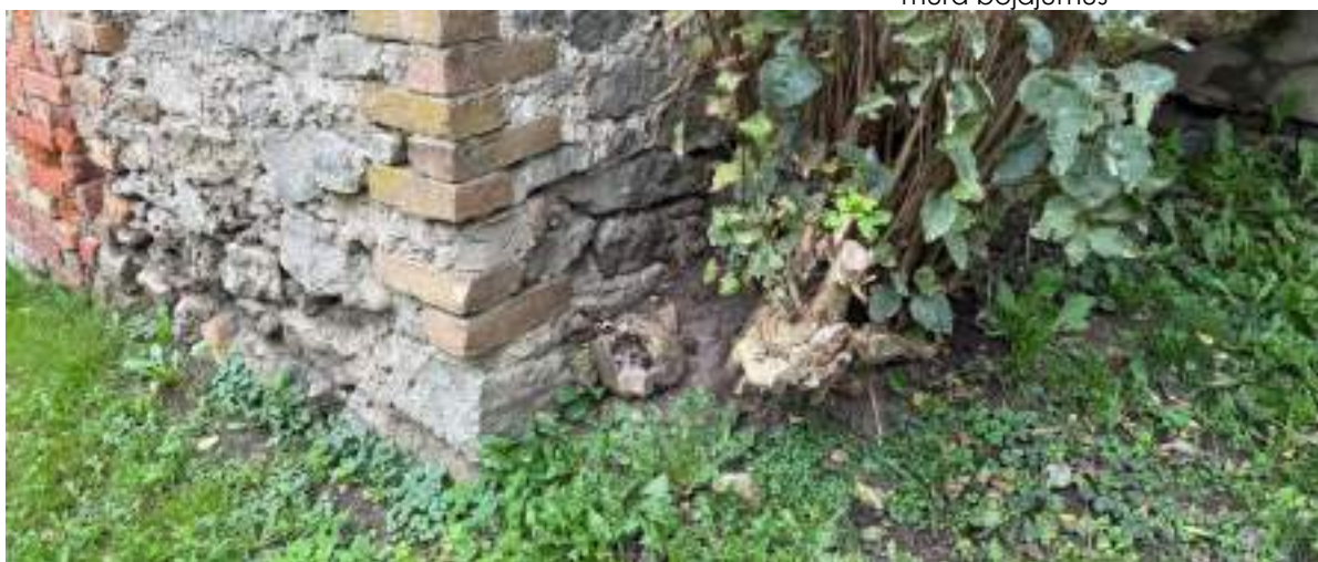
F - 18 Ēkas ZR stūrī augošā krūma sakņu sistēma veicina pamatu mūra bojājumus, šajā zonā redzama mūra erozija – saistvielas izskalojumi, deformācijas, savulaik veikti lokāli labojumi
