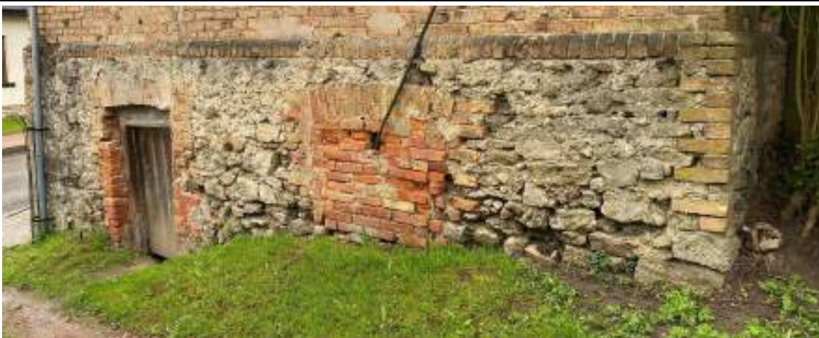
F - 19 Ēkas Z puses gala fasādē cokolā redzama izteikta mūra erozija – saistvielas izskalojumi, plaisas, deformācijas. Aizmūrēta pagraba logaile
