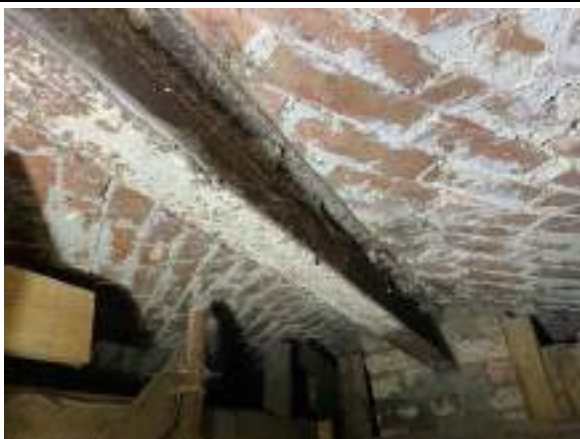
F - 68 Pagraba telpā Nr. 903-1 zem velves izbūvēta papildus atbalsta konstrukcija no mūra stabiem un metāla sijas. Uz sijas veidojas korozija
