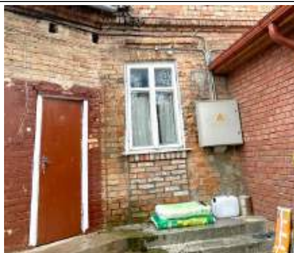
F - 208 Pagalma fasādē laika gaitā veiktas pārbūves, t.sk. pārbūvējot logu un durvju ailes
