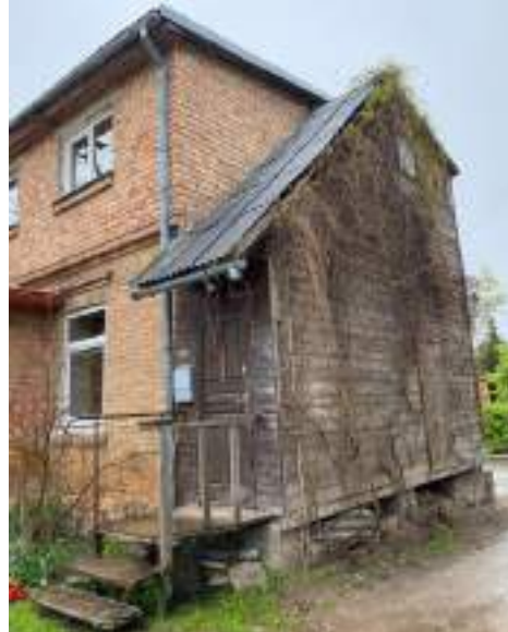
F - 210 Uz kāpņu telpas apjoma D puses fasādes un jumta aug vītenaugs, fasāžu dēļu apšuvums nolietojies, dažviet bojāts
