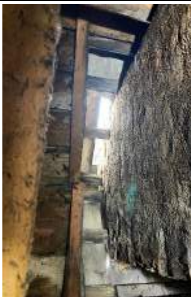
F - 177 Šajā zonā nokrišņu ūdens nonāk ēkas bēniņos
