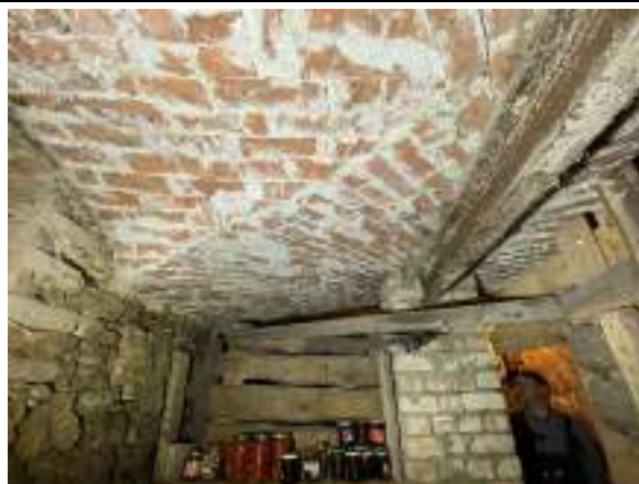
F - 69 Pagraba telpā Nr. 903-1 zem velves izbūvēta papildus atbalsta konstrukcija no mūra stabiem un metāla sijas. Uz sijas veidojas korozija
