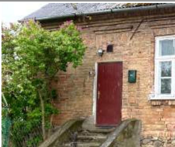
F - 207 Pagalma fasādē laika gaitā veiktas pārbūves, t.sk. pārbūvējot logu un durvju ailes
