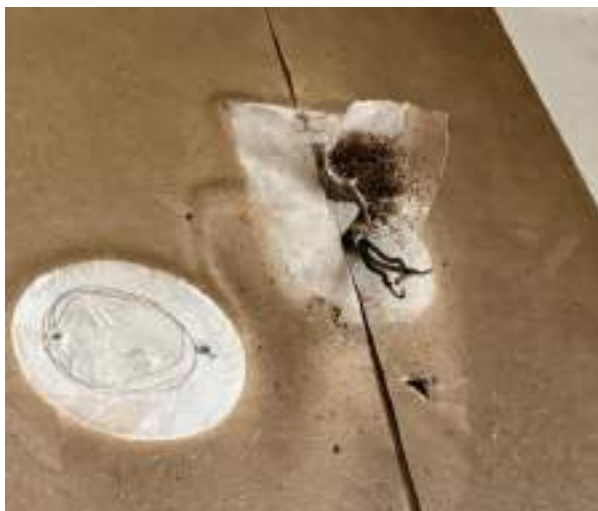
F - 189 Neizolēti kabeļu gali dzīvoklī Nr. 9
