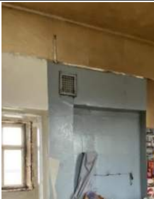
F - 195 Dzirvokļi Nr. 9 esošais dabīgās ventilācijas kanāls
