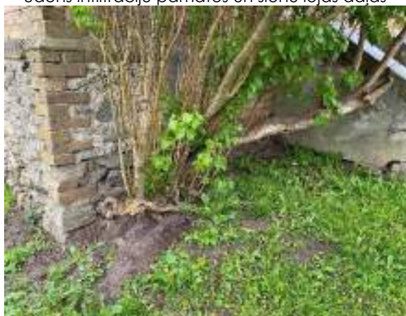
F - 17 Ēkas ZR stūrī pamatu tiešā tuvumā izeudzis ceriņu krūms, tā sakņu sistēma veicina pamatu mūra bojājumus
