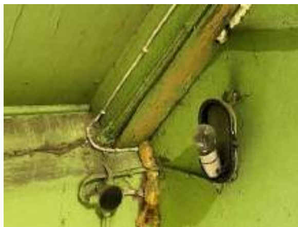
F - 185 Kāpņu telpā gaismas ķermenim zudis aizsargkupols
