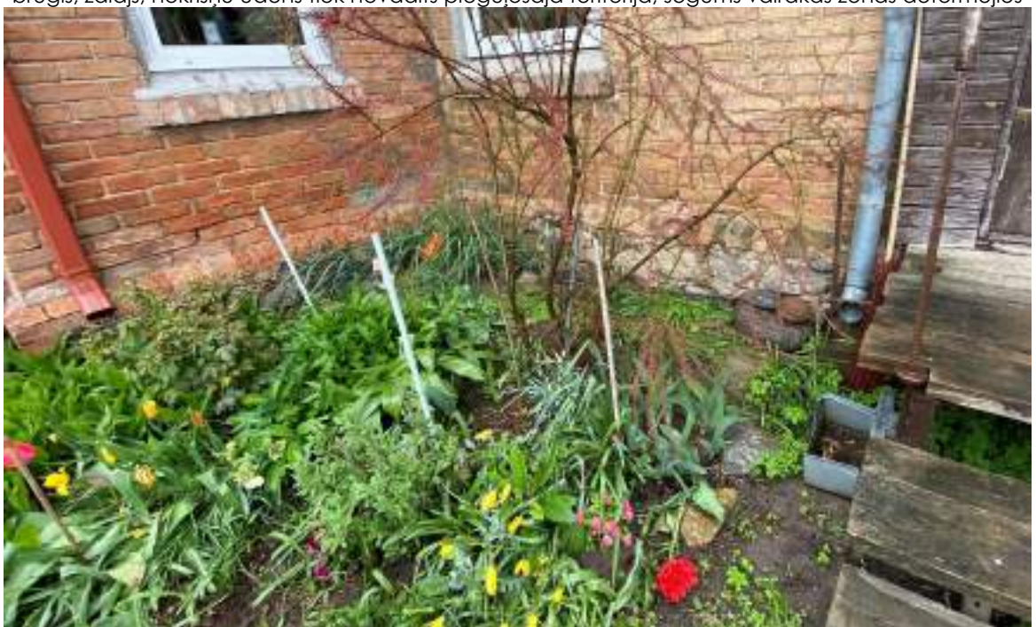
F - 13 Ēkas DA daļā pamatu tiešā tuvumā veidoti apstādījumi, ūdens tiek novadīts pie pamatiem, radot mitruma piesātinājumu, izskalojumus
