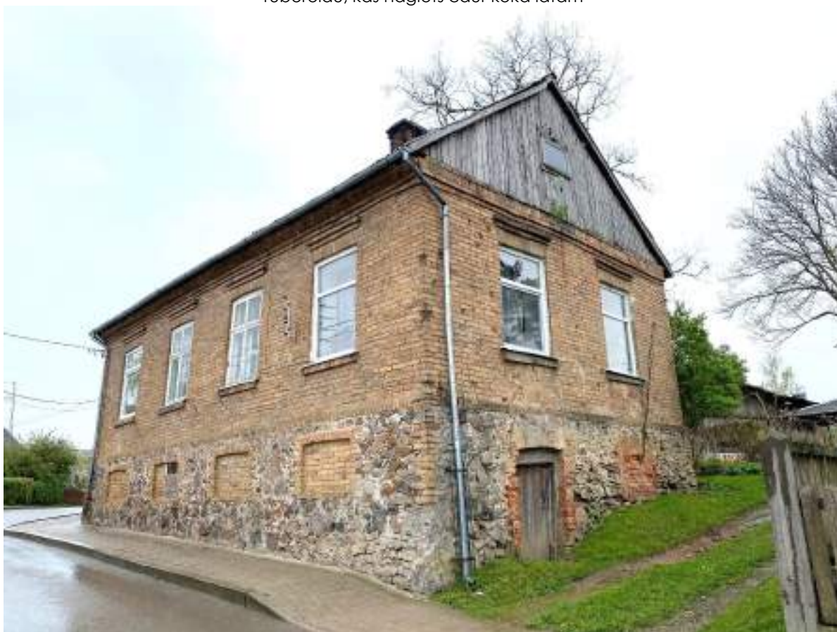
F - 204 Ēkas Baznīcas ielas fasādes Z daļa, Z puses gala fasāde. Ēkas Z stūrī veikti lokāli labojumi ar cementa javu. Gala fasādē redzami mehāniski bojājumi, kas, iespējams, ir ložu pēdas
