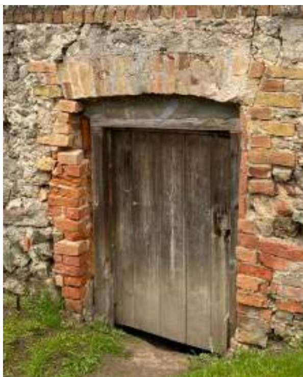
F - 165 Pagraba ieejai izbūvētas koka namdaru (dēļu) durvis. Durvju apakšdaļā nav sliekšnis, redzama sprauga, pa kuru nokrišņu ūdens ieplūst pagrabā. Zonā ap durvju aili redzama mūra erozija, radušās deformācijas
