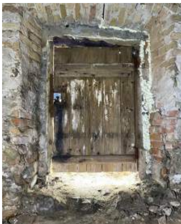
F - 166 Pagraba ieejai izbūvētas koka dēļu durvis. Durvju apakšdaļā nav sliekšnis, redzama sprauga, pa kuru nokrišņu ūdens ieplūst pagrabā. Zonā ap durvju aili redzama mūra erozija, radušās deformācijas, spraugas dažviet blīvētas ar celtniecības putām
