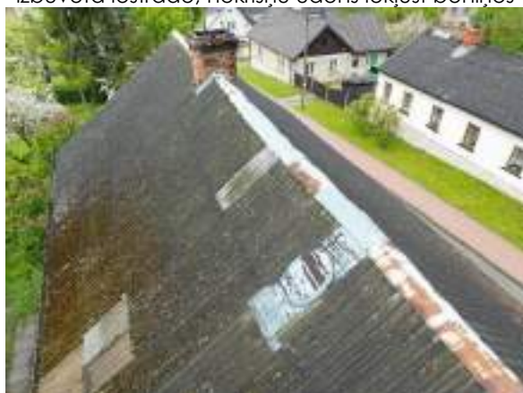
F - 114 Uz pagalma puses jumta plaknes veidojas sūnu apaugums, korodējuši skārda elementi
