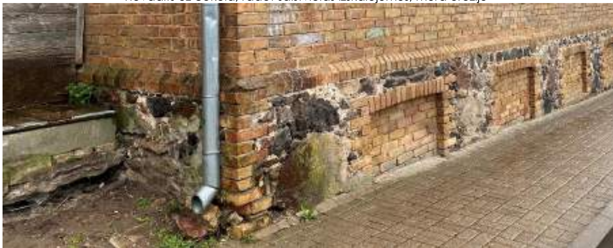
F - 2 Ēkas DR stūrī dēļ lietus ūdens notek sistēmas bojājumiem nokrišņu ūdens notek uz cokola, veicinot mūra eroziju. Nokrišņi uz cokola, sienu lejas daļas nonāk arī notekot no kāpņu telpas apjoma jumta, atsitoties pret nasegvāku
