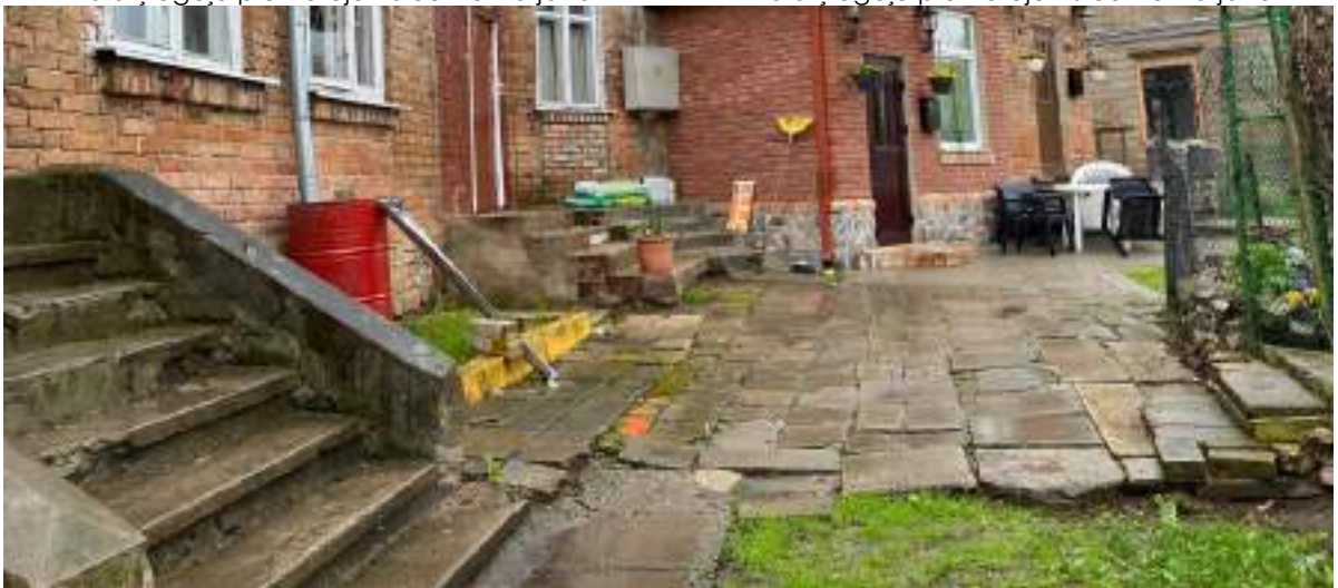
F - 12 Pagalma pusē izbūvēts betona plāksņu, betona bruģa segums, cokolam piekļaujas kāpnes, bruģis, zālājs, nokrišņu ūdens tiek novadīts piegulošajā teritorijā, segums vairākās zonās deformējies
