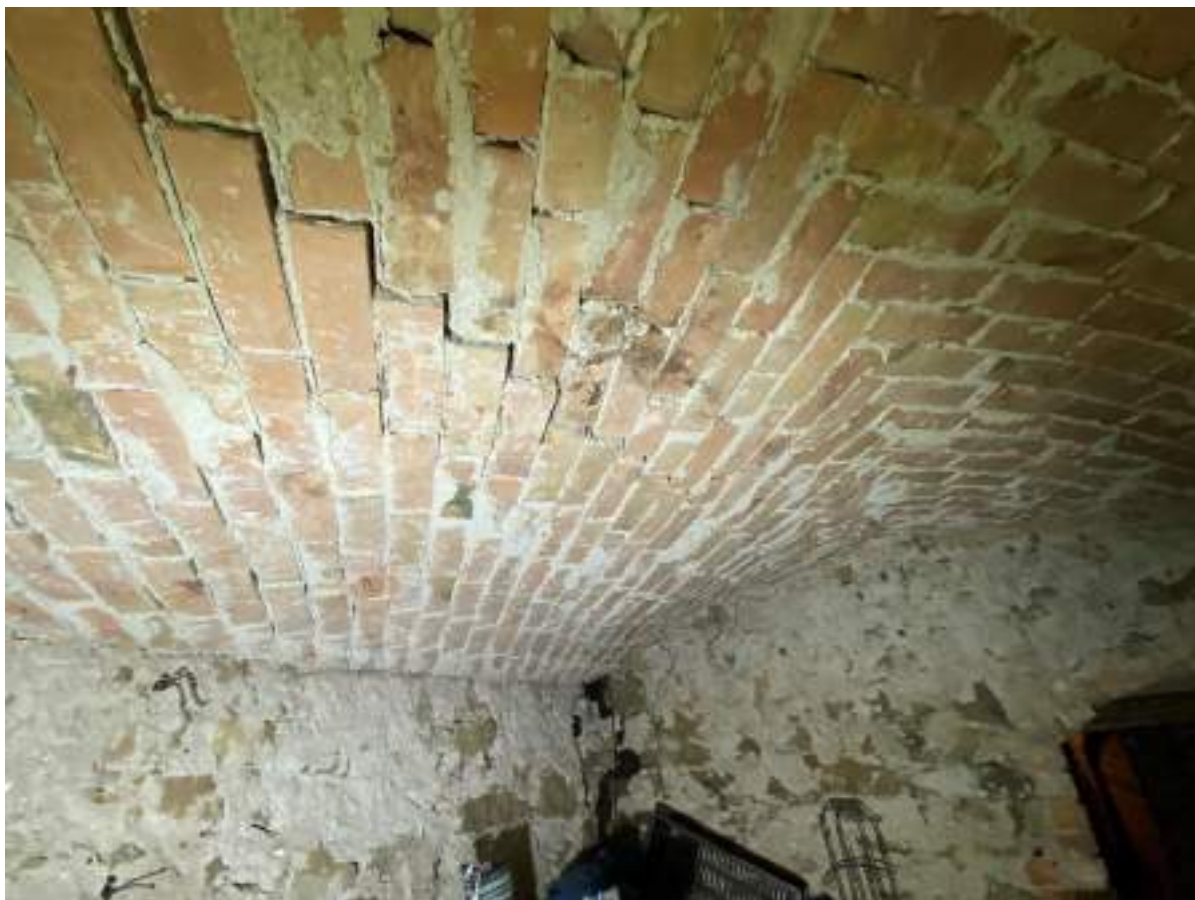
F - 62 Pagraba pārseguma velve telpā Nr. 903-3. Velvē redzamas izteiktas deformācijas, caurejošas plaisas pa mūra šuvēm
