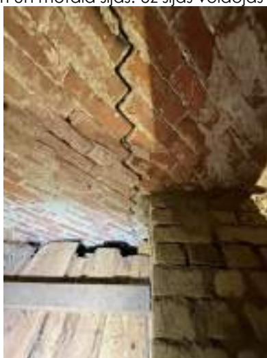
F - 70 Pagraba telpā Nr. 903-1 papildus balstkonstrukcija izbūvēta zonā, kur velvē pa mūra šuvēm ir caurejoša garenvirziena plaisa
