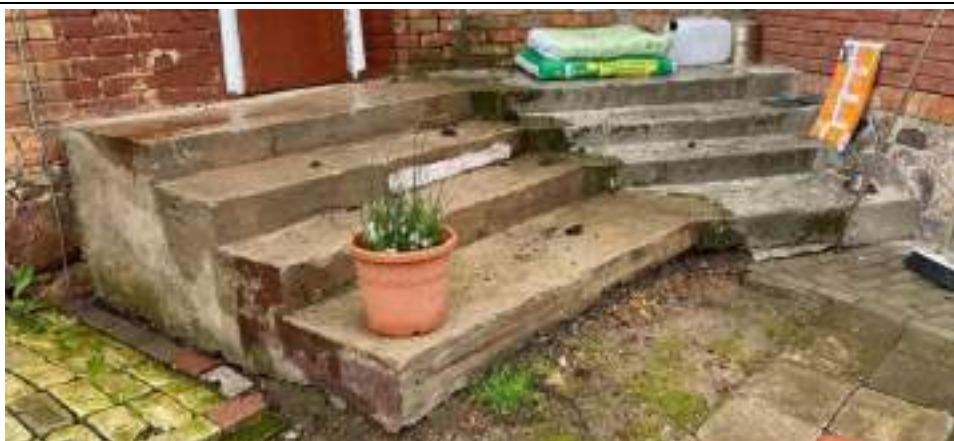
F - 144 Pagalma fasādes centrālās daļas ieejas kāpnes. Kāpņu augšējam laukumam, kura augstums ir lielāks par 0,45m, nav izbūvētas margas
