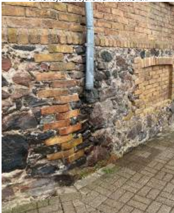
F - 135 Baznīcas ielas fasādē zuduši notekcauruļu apakšējie posmi, nokrišņu ūdens tiek novadīts uz mūra cokolu
