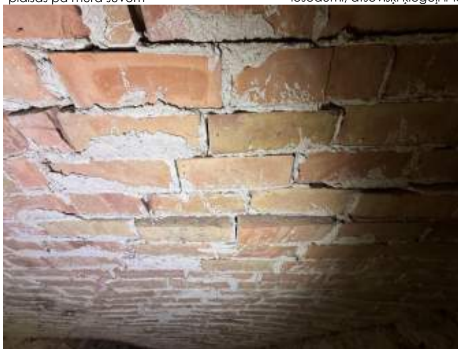
F - 65 Ķieģeļu velvē redzamas deformācijas, iesēdumi, atsevišķi ķieģeļi kustīgi
