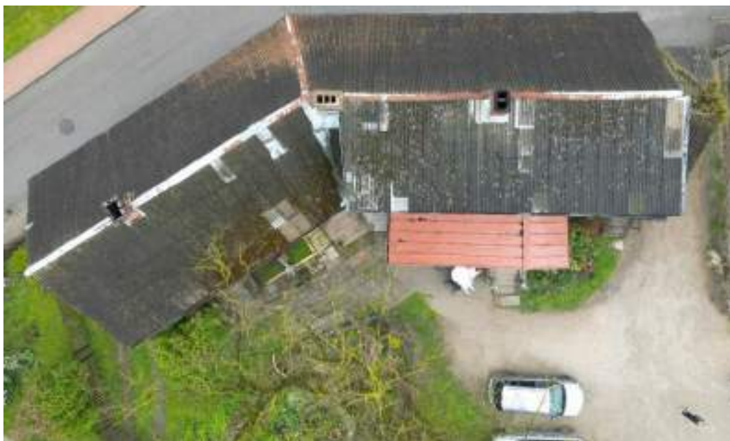
F - 104 Ēkas jumts skatā no augšas. Redzams, ka jumta segumam laika gaitā veikti lokāli labojumi. Pagalma pusē, kur aug koks, uz jumta veidojas izteikts sūnu apaugums
