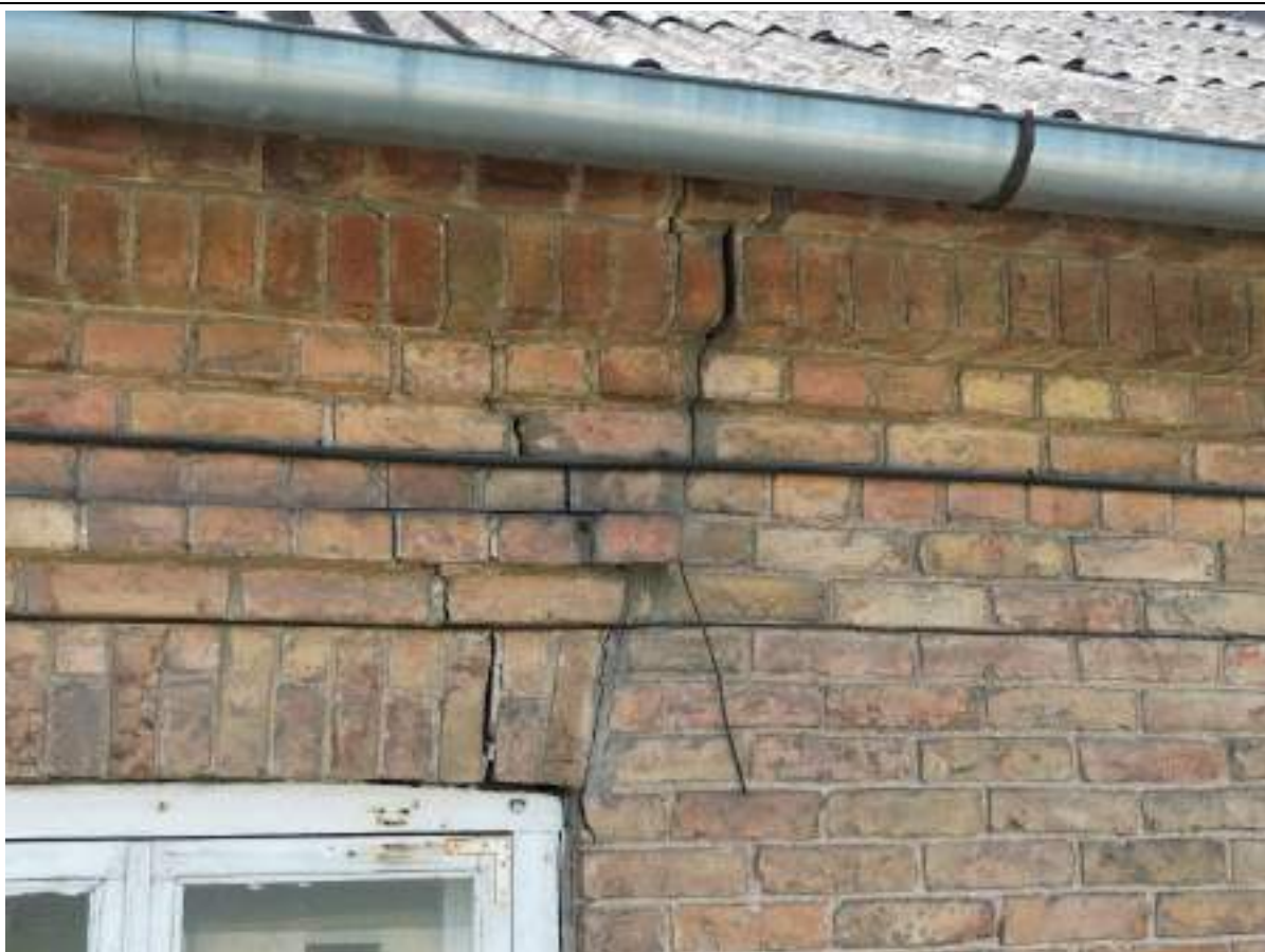
F - 34 Izteiktas plaisas un deformācijas zonā virs logailes (ēkas Baznīcas ielas fasādes Z daļā)
