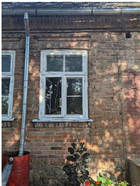
Atšķirīgu celtniecības periodu sadures vieta ēkas R fasādes D daļā. 2025. gada foto
