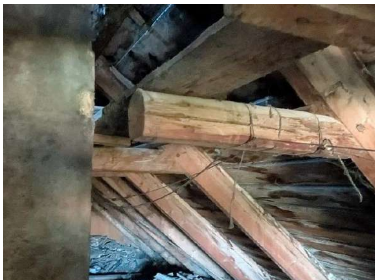
Jumta konstrukcijas fragments – vieta, kur viens no saišķiem skursteņa vietā pārzāgēts un tā funkcijas nodrošināšanai izveidota izmija – apzāgētā saišķa horizontālā slodze ar tam pienaglotas planks palīdzību pārnesta uz blakus esošajiem saišķiem. 2025. gada foto
