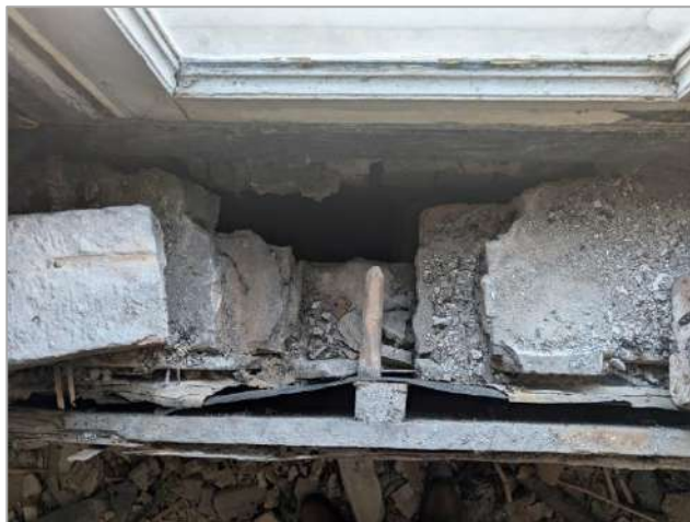
Skats no augšas uz gaisa šķirkārtu ēkas R ārsienā (logailā L5). 2025. gada foto
