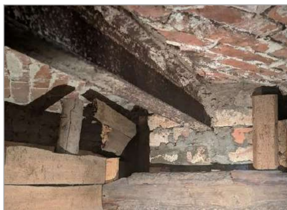
Padomju laikā iebūvētais sākotnējās velves pastiprinājums – uz ķieģeļu stabiem balstīts tērauda švelleris. 2025. gada foto
