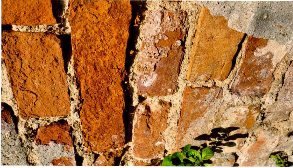
32. attēls. Māla ķieģeļu mūra fragments D fasādē. Zudis apmetums.
