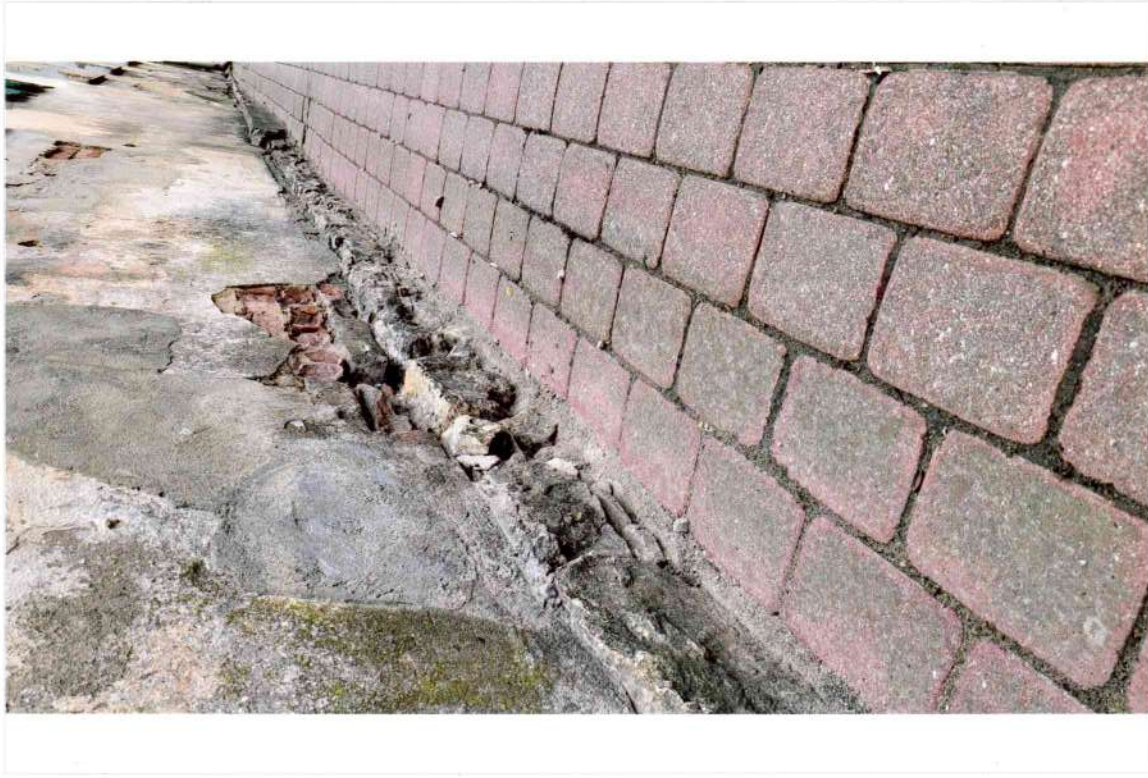
17. attēls. Cokols Z fasādē, akmens mūrējumam zudususi apdare.
