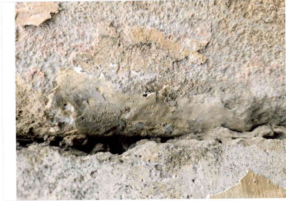
15. attēls. Ēkas Z fasādes fragments ar krāsojumu uz aizmūrētās durvju ailes malas.
