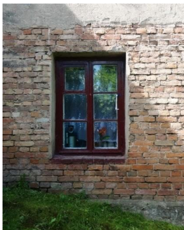
40. attēls. Skats uz atšķirīga izmēra un dalījuma 20. gadsimta vidus logu L1-16 ZA fasādē. Logailai nav izmūrēta pārsedzes ķieģeļu arka un palodze
