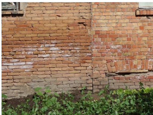
16. attēls. DA gala šķērskorpusa DA fasādes fragments. Vecākajam apjomam (pa kreisi) piekļaujas jaunāks ar atšķirīgu mūrējumu un aizmūrētu logailu L1-12
