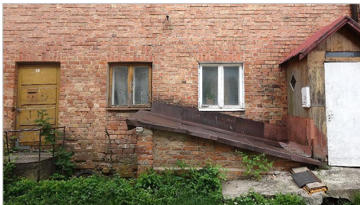
31. attēls. Skats uz ēkas DR fasādes daļu – vēlāk izbūvēto noeju uz pagrabu un samazinātajām logailām L1-3, L1-4
