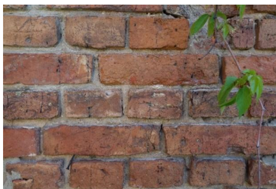
23. attēls. Ķieģeļu mūrējums bez izšuvojuma DR fasādes A daļā
