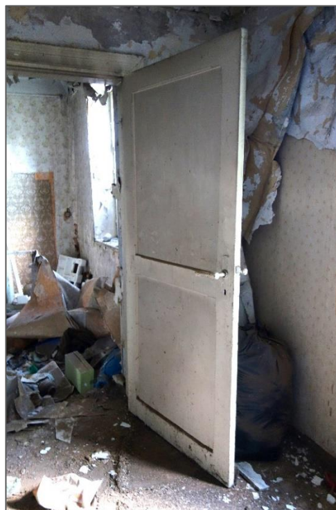
48. attēls. 20. gs. 80. gadu durvis dzīvoklī Nr. 7 - avārijas stāvoklī esošajā ēkas daļā
