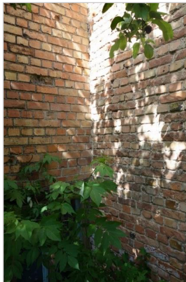
25. attēls. Tuaelesu izbūve celtnes ZA fasādē. Labi redzama ķieģeļu un mūrējuma atšķirības.
