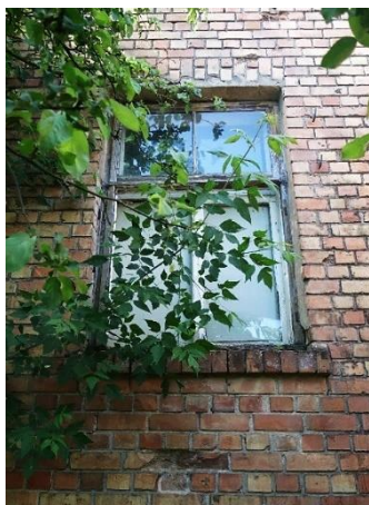
38. attēls. Skats uz logu L2-16 ZA fasādē ar izmūrēto lēzeno pārsedzes arku un izvirzītu palodzi
