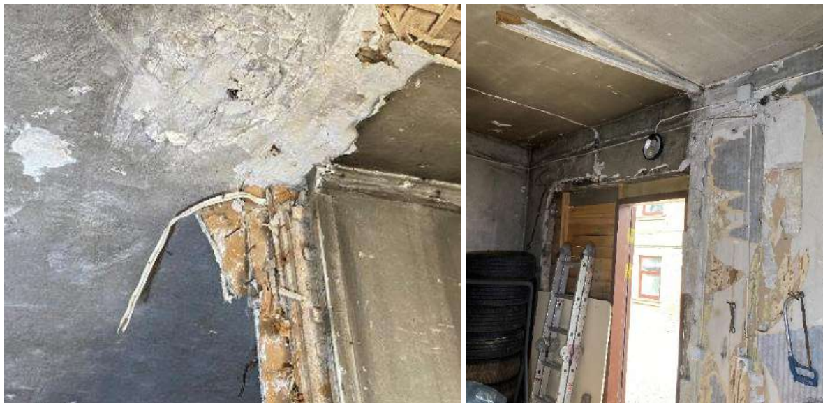
F - 80 Redzami neizolēti kabeļu gali, novecojusi, bojāta elektroinstalācija
