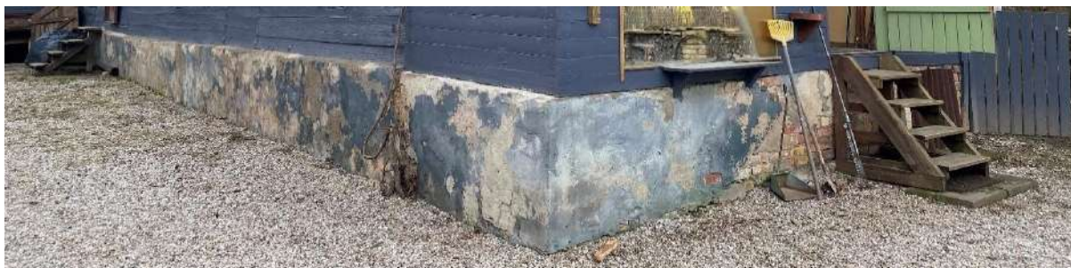
F - 2 Pagalma apjoma cokols. Ievērojami bojāta tā apdare, piebūvētās verandas ieejas zonā apmetums vairākās vietās atslāņojies, zudis. Cokola izvirzījums nav nosegts. Pamatu tiešā tuvumā ieaudzis vītenaugs
