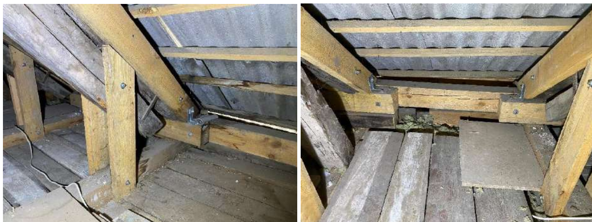
F - 51 Daļā ēkas mainītas pārseguma sijas, no koka zāģmateriāliem izbūvētas spāru uzlikas, kopturi, u.c. pastiprinošās konstrukcijas. Vairākās zonās spāru gali vairs nebalstās pārseguma sijās
