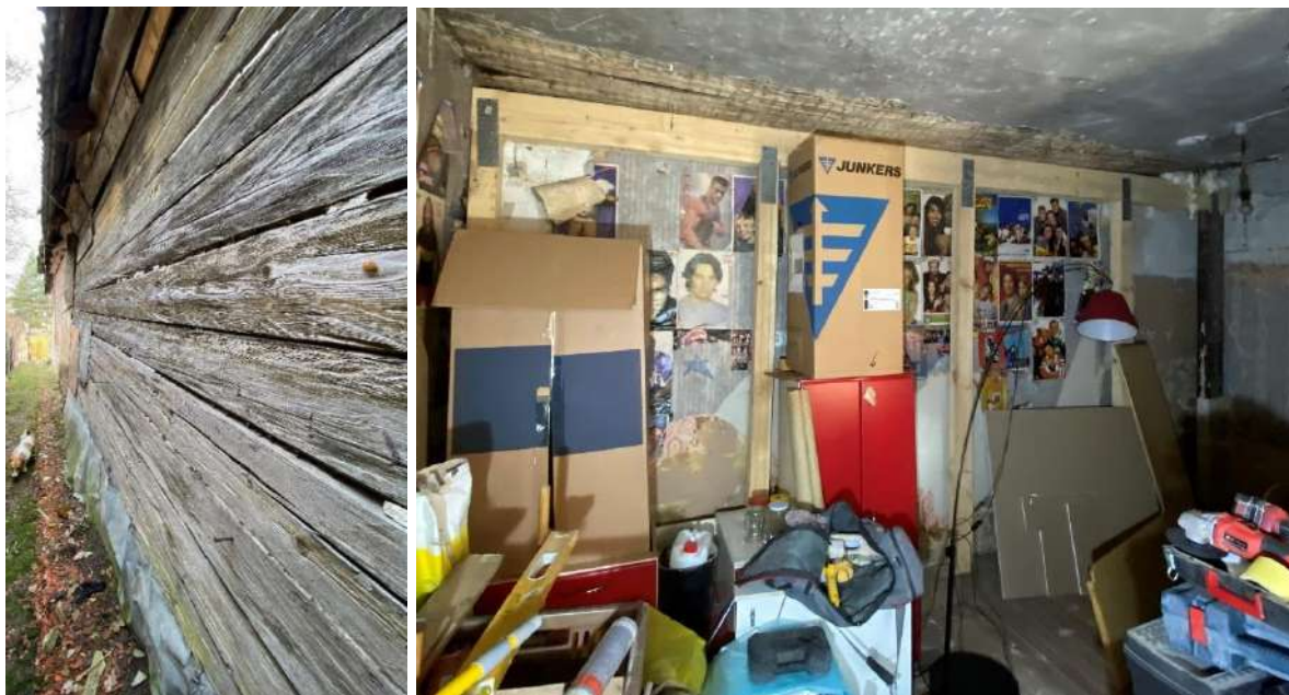
F - 19 Pagalma apjoma R puses ārsiena deformējusies, ēkas iekšpusē izbūvēts papildus balstošais karkass
