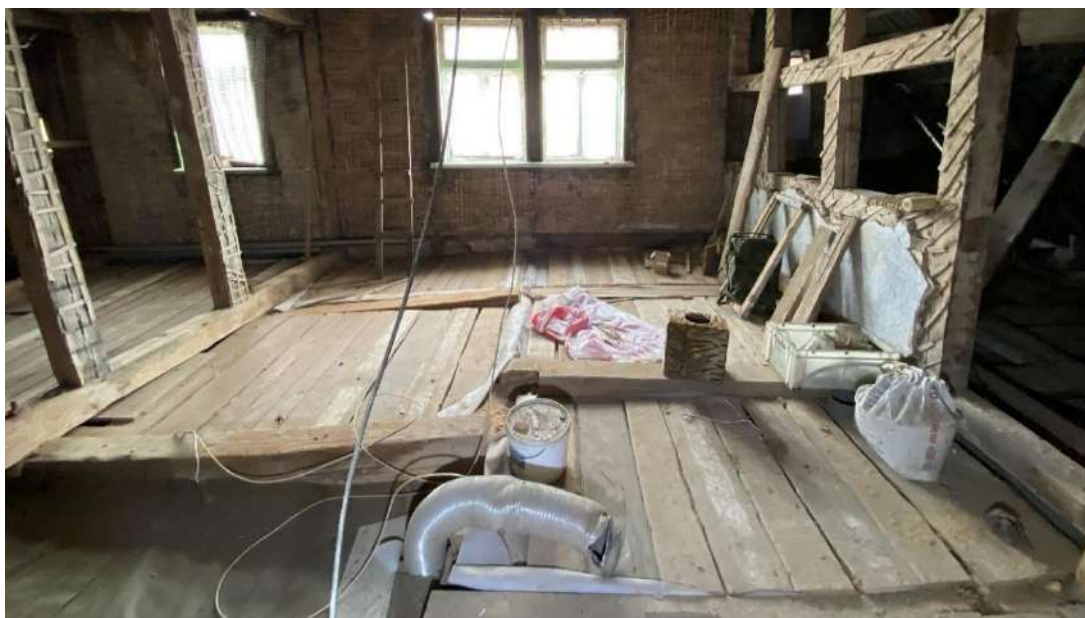
F - 34 Ēkas pamatapjoma A daļā pārsegumam redzamas izteiktas deformācijas. Pārsegumam starp sijām izbūvēts siltinājums, dēļu klājs
