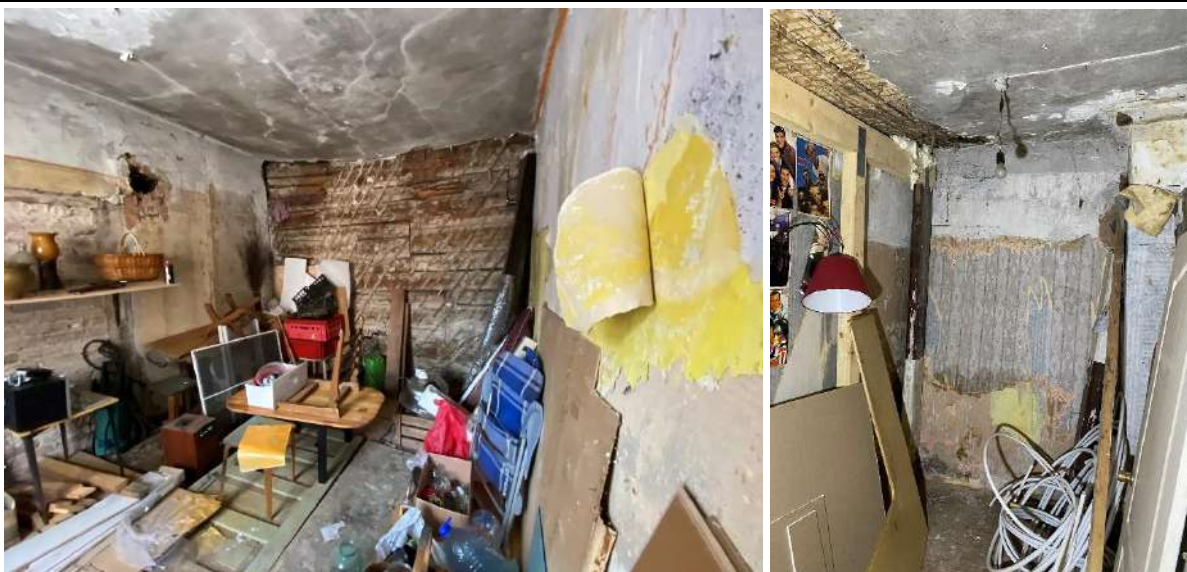
F - 87 Pagalma apjoma iekštelpu apdare nolietojusies, ievērojami bojāta, dažviet demontēta/zudusi
