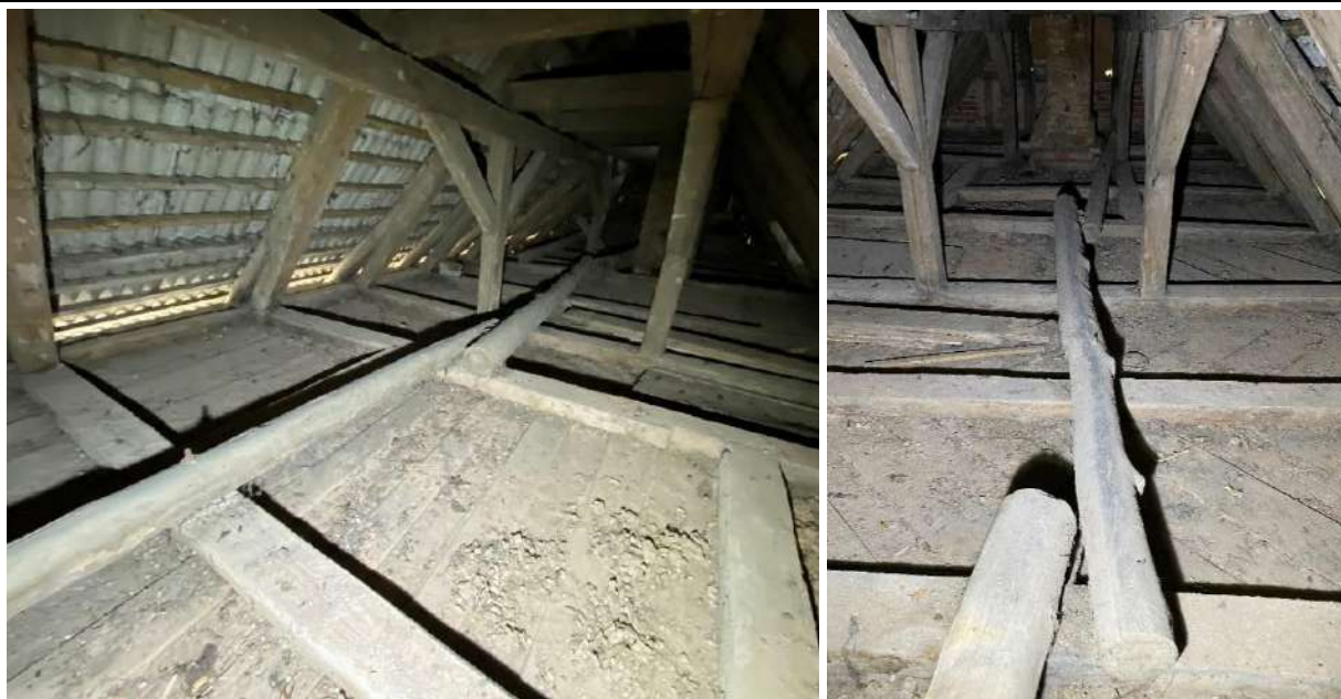
F - 39 Ēkas pagalma apjoma pārseguma sijas balstās uz ārsienām, vidusdaļā tās iekārtas koka kopturos
