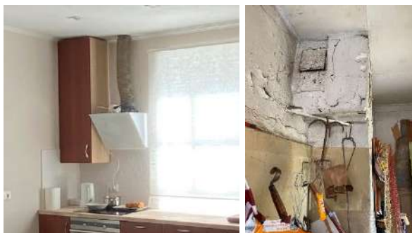
F - 84 Ēkas apdzīvotās daļas virtuvē izbūvēts tvaika nosūcējs, tā izvads caur griestiem ievadīts bēniņos, kur tas apraujas. Pagalma apjoma dabīgās ventilācijas kanāls
