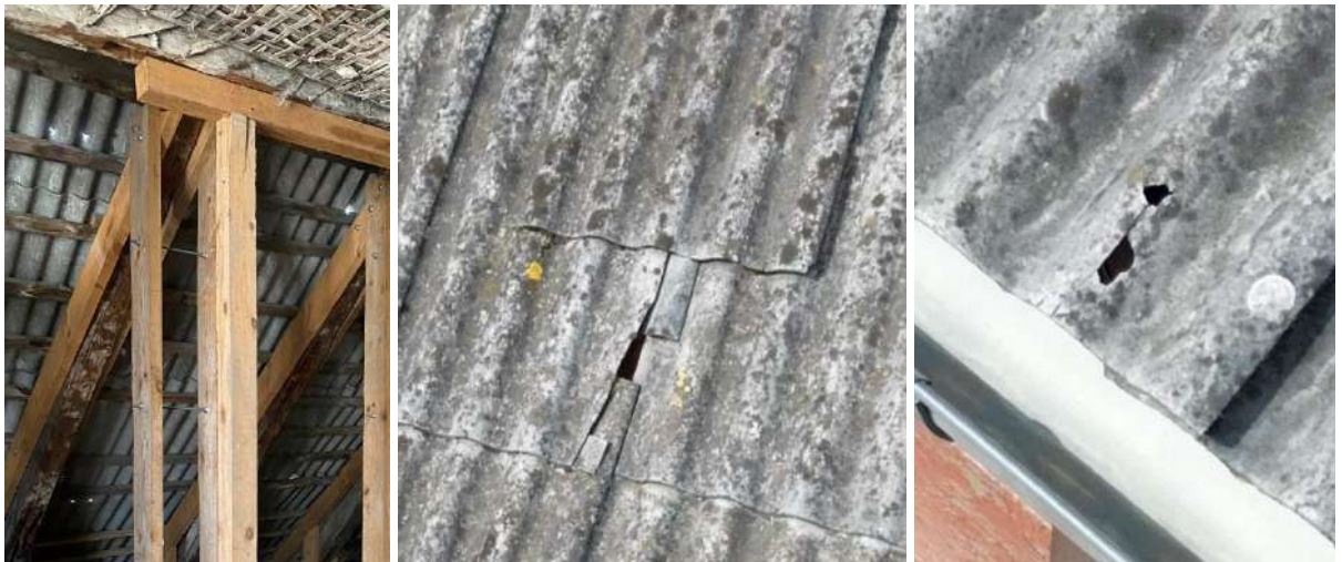
F - 60 Jumta segumā vairākās vietās redzami caurumi, iepīsušas, salūzušas loksnes
