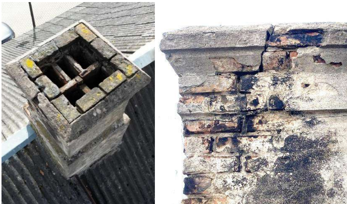
F - 77 Caur ēkas pamatapjoma kori izbūvētajam ķieģeļu mūra skurstenim virsumta daļā redzama mūra erozija, apdares atslāņošanās, izdrupumi, plaisas, atsevišķi nestabili apdares fragmenti
