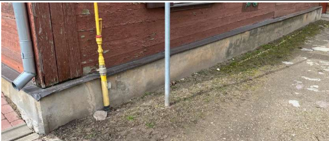
F - 6 Ēkas A fasādes cokols. Cokolam izbūvēts skārda lāsenis, tas lokāli deformējies. Cokola apdarē redzamas plaisas, lokāli apdares bojājumi. Vidusdaļā, kur no nošļauptās jumtgales lietus ūdens notek pie ēkas pamatiem, veidojas mitruma piesātinājums, uzkrājas ūdens, kas skalojas gar ēkas pamatiem
