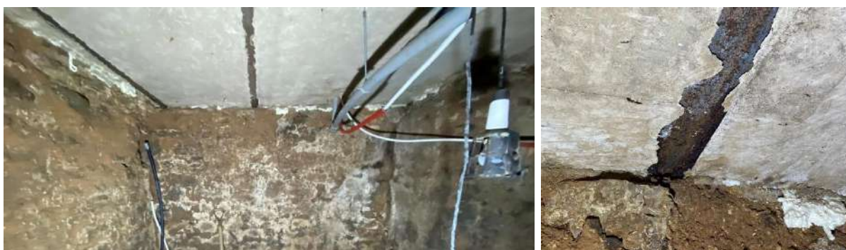
F - 27 Daļā pagraba pārsegumu veido monolītā dzelzsbetona plātnes starp tērauda dubul-T profila sijām. Uz tērauda siju apakšējiem plauktiem veidojas korozija, kas izteiktāk redzama pie balstvietām
