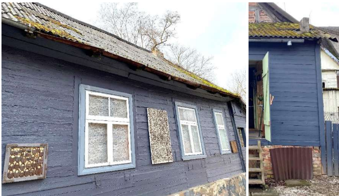
F - 61 Pagalma pusē apjomam korodējušas, deformējušas teknes, zudušas notekcaurules, kā rezultātā nokrišņu ūdens nonāk pie ēkas pamatiem, bojā cokola apdari, cokols piesegts ar jumta seguma loksni
