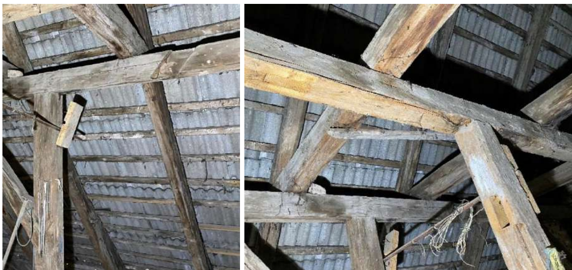
F - 42 Jumta konstrukcijām demontēķi vairāķi atgāķķņķ, redzamas to ligzķu vietas
