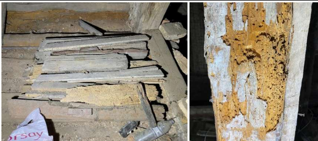
F - 56 Bēniņos dažviet redzami sakrauti trupes, koksnes kaitēkļu bojāti kokmateriāli, kas nepilda nekādu funkciju. Daļai no ēkas jumta konstruktīvajiem elementiem novērojami izteikti koksnes kaitēkļu radīti bojājumi
