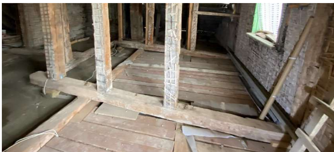
F - 35 Ēkas pamatapjoma A daļā pārsegumam redzamas izteiktas deformācijas
