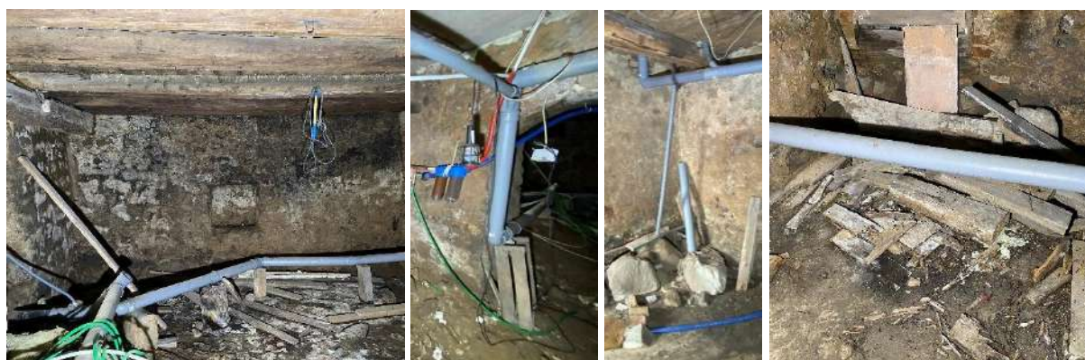
F - 8 Ēkas pagrabā kanalizācijas cauruļu balstīšanai izmantoti apšaubāmi risinājumi – ķieģeļi, koka kastes, PVC caurules. Dažviet pagrabā atrodami satrupējuši kokmateriāli u.c. gruži
