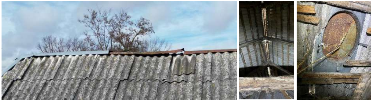
F - 58 Ēkas pamatapjoma jumtam kore un šķautnes nosegtas ar skārdu. Skārds daudzviet korodējis, atsevišķās vietās izklāvēs, nav atbilstoši nostiprināts, kā rezultātā bēniņos var iekļūt nokrišņi. Korodējis jumta lūkas vāks
