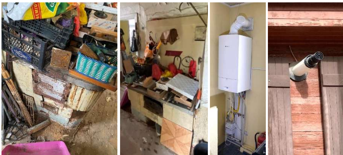
F - 75 Ēkā saglabājusies māla podiņu plīts ar sildmūri, tā bojāta, nav ekspluatējama. Apdzīvotās daļas un bijušo komercietelpu apkuri nodrošina kondensācijas gāzes apkures katls, gaisvads izvadīts galvenajā fasādē
