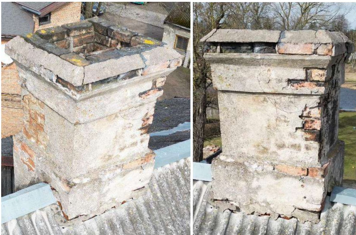
F - 76 Caur ēkas pamatapjoma kori izbūvētajam ķieģeļu mūra skurstenim virsumta daļā redzama mūra erozija, apdares atslāņošanās, izdrupumi, plaisas, atsevišķi nestabili apdares fragmenti
