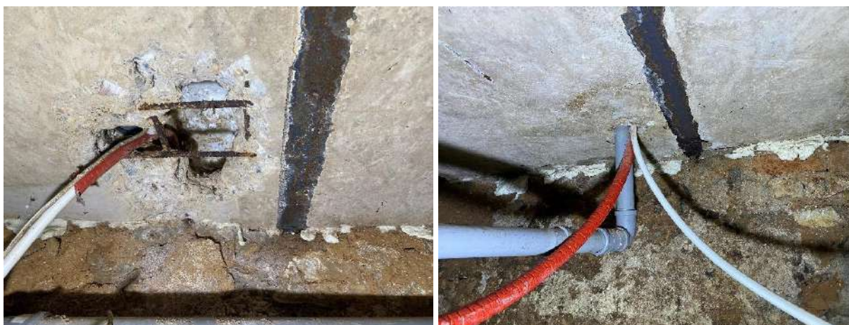
F - 28 Pagraba pārseguma sijām apakšējos siju plauktus klāj korozija. Dzelzsbetona pārsegumā izveidoti atvērumi, šajās zonās korodējis stiegrojums
