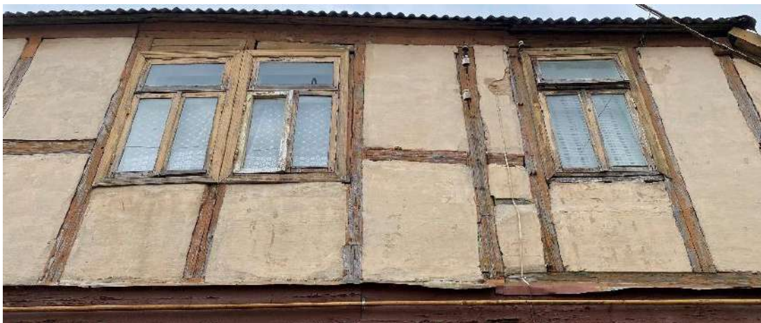
F - 14 Austrumu gala fasādes nošķeltais zelminis izbūvēts pildrežģa konstrukcijā. Koka karkasam nolietojies krāsojums, redzami lokāli trupes bojājumi, deformācijas. Deformēties starpdzegas nosežskārds
