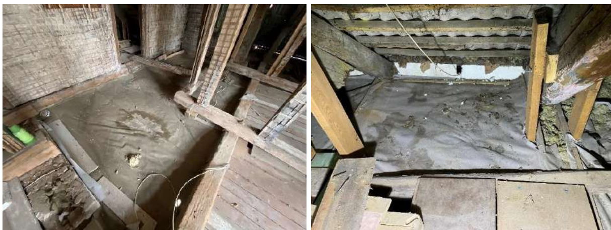
F - 22 Daļā bēniņu dēļu klājs nav atjaunots. Ēkas bēniņos uz pārseguma dažviet redzami notecējumi, kas radušies nokrišņu ūdenim iekļūstot ēkā dēļ jumta seguma bojājumiem
