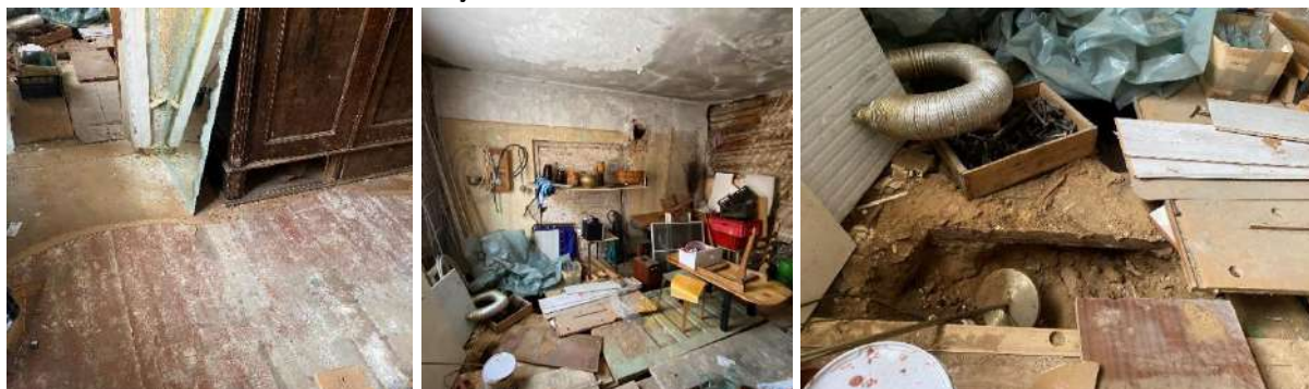
F - 67 Ēkas pagalma apjomam koka dēļu grīdas segumi vairākās zonās ievērojami bojāti, dažviet demontēti vai pārklāti ar dažādiem lokšņu materiāliem
