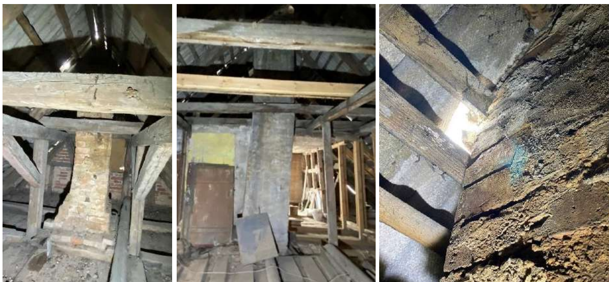
F - 79 Bēniņu daļā skursteņiem veidots pieziedums. Vairākās zonās skursteņu salaidumvietas ar jumtu nav blīvas/hermētiskas, šajās zonās bēniņos nonāk nokrišņu ūdens
