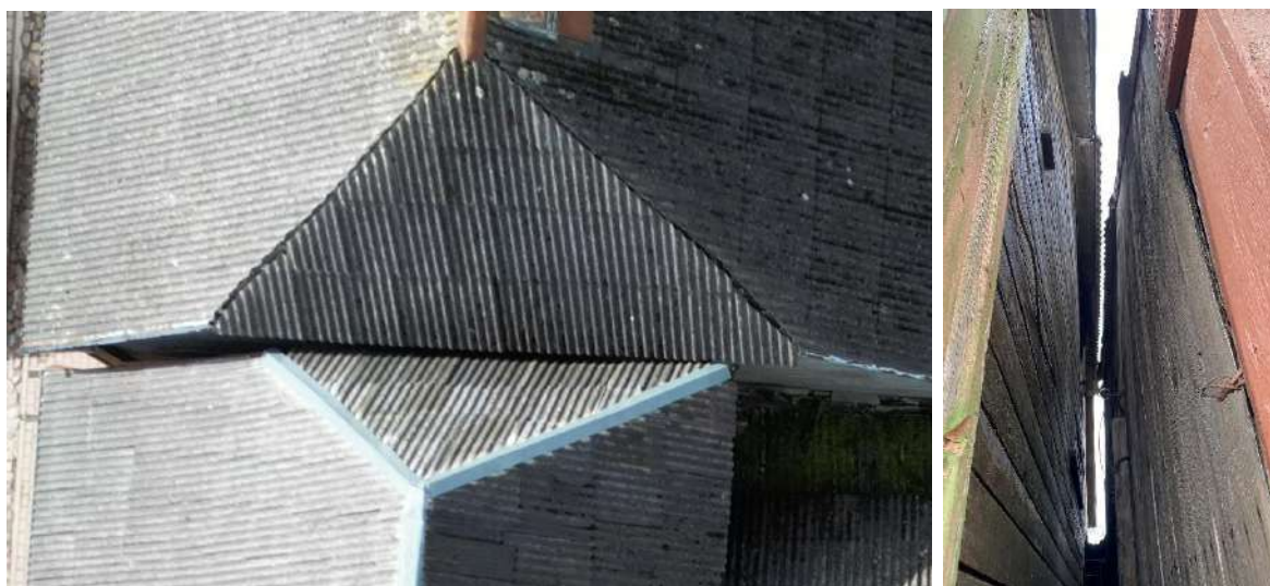
F - 62 Blakus īpašumā (Rīgas ielā 13) esošajai ēkai arī izbūvēta nošļaupta jumtgale, kas vērsta pret apsekotās ēkas R fasādi. Nevienai no ēkām jumta nošļaupumam nav izbūvētas lietus ūdens teknes, kā rezultātā nokrišņu ūdens notek spraugā starp ēkām, veicina ēku sienu bojājumu rašanos
