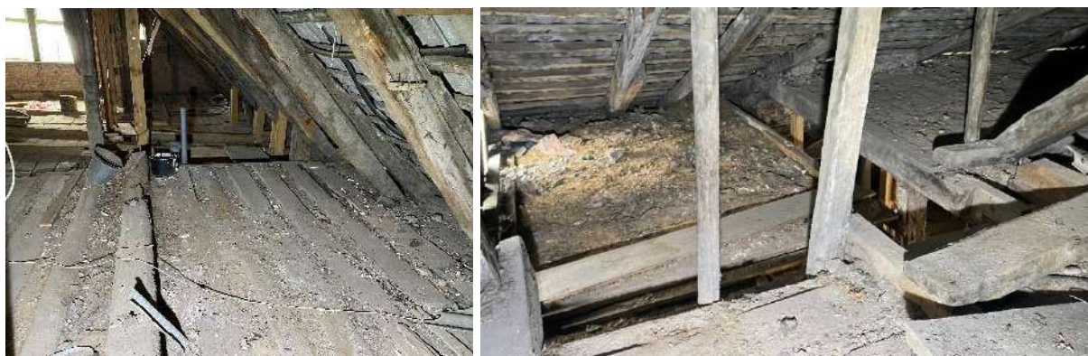
F - 20 Starp sijām veidoti "melnie griesti", dažviet redzamas būvgružu, skaidu siltinājuma paliekas
