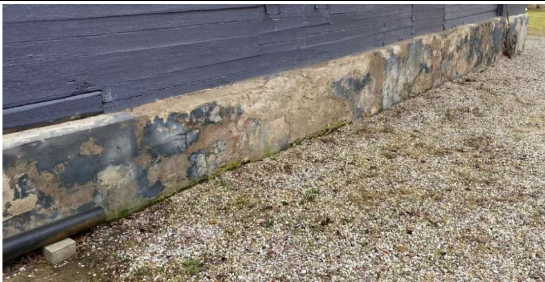
F - 3 Pagalma apjoma cokola bojātā apdare vairākkārt labota. Lietus ūdens notekcaurule ūdeni novada pie cokola. Cokola augšdaļā nav izbūvēts lāsenis
