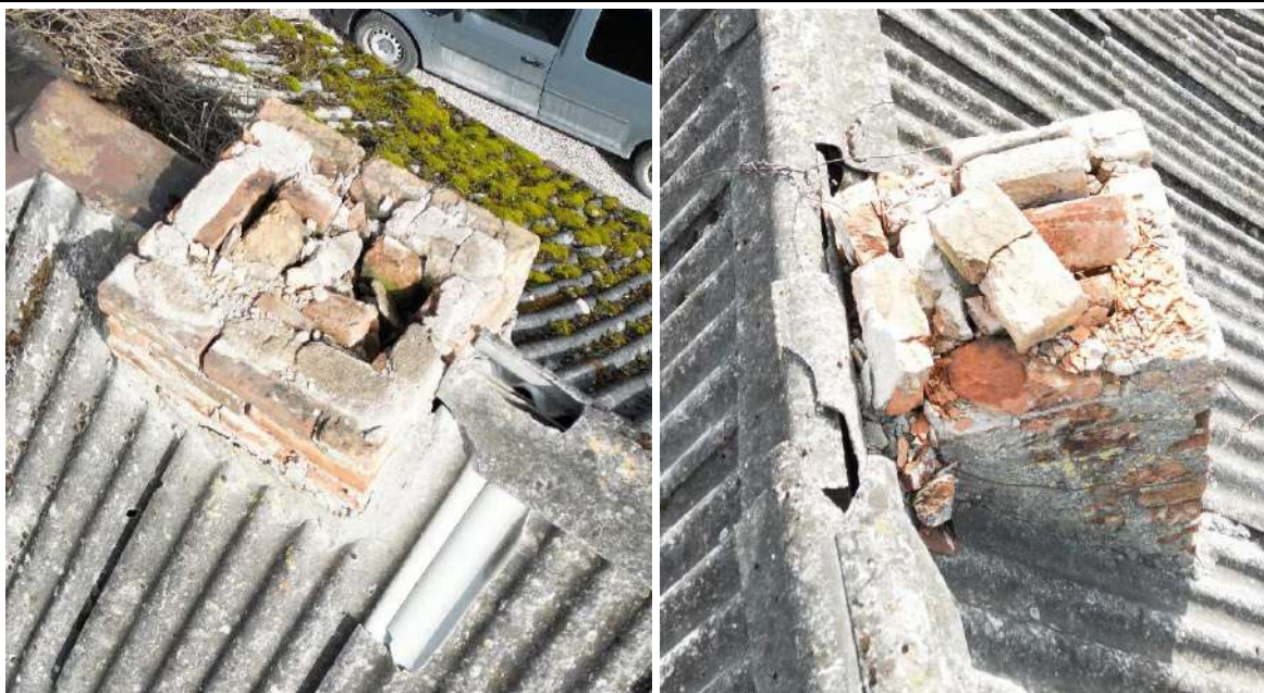
F - 78 Pagalma apjoma dūmeņiem virsjumta daļas iegruvušas, redzami nestabili apdares un mūra fragmenti, jumta kores nosegelementi bojāti, šajās zonās bēniņos iekļūst nokrišņi
