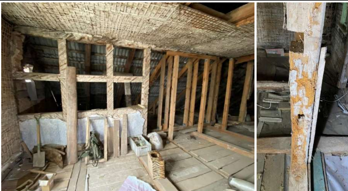
F - 50 Daļā ēkas jumta konstrukcijas savulaik demontētas, izbūvētas pagaidu pastiprinošās konstrukcijas. Pildrežģa sienai, kas kalpo arī kā taisnais jumta krēsls, daļēji demontēts mūra pildījums. Vairākās jumta konstrukcijās konstatēti trupes, koksnes kaitēkļu radīti bojājumi
