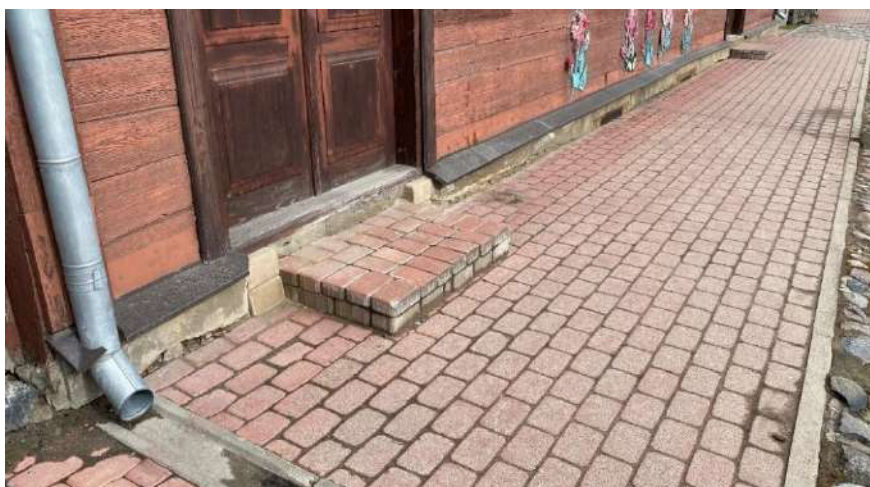
F - 5 Rīgas ielas fasādes cokolam izbūvēts skārda lāsenis. Cokolā redzami izdrupumi, plaisas apdarē. Cokolā izbūvētas atveres pagaba vēdināšanai
