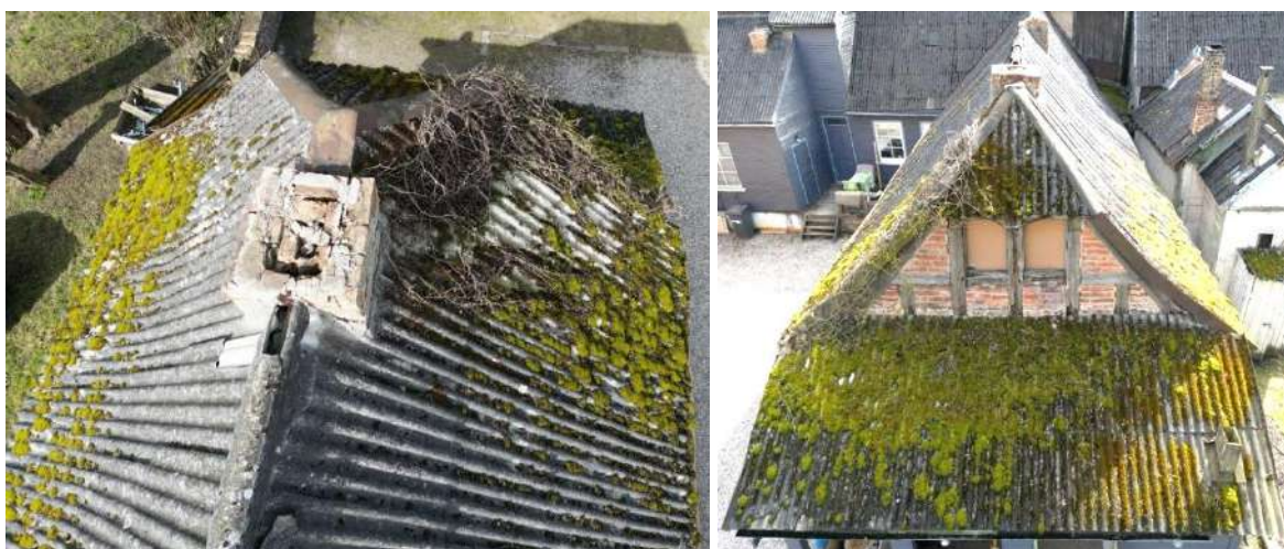
F - 57 Ēkas pagalma apjoma Z daļā dēļ blakus esošā koka uz jumta veidojas izteikts sūnu apaugums, kas kavē nokrišņu novadīšanu no jumta. Šajā zonā uz jumta aug vītenaugs, kas veicina seguma bojājumu rašanos. Z puses verandas vienslīpes jumts apaudzis ar sūnām
