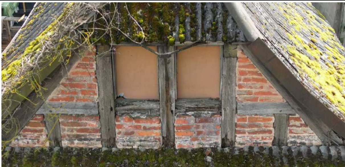
F - 17 Pagalma apjoma Z fasādes zelminis. Pildrežģa koka konstrukcijās apjomīgi trapes bojājumi
