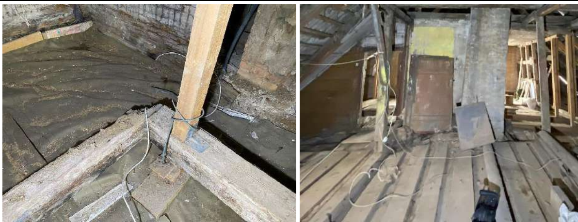
F - 82 Ēkas bēniņos izvilkti elektrokabeļi, tie dažviet aptīti ap koka konstrukcijām, nav nostiprināti, nokarājas
