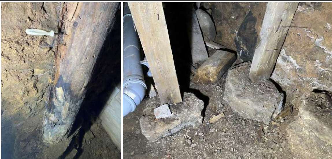
F - 26 Pārsegumu papildus balstošajiem statņiem redzami trupes, koknes kaitēkļu radīti bojājumi, to balstvietas nav attiecīgi nostiprinātas
