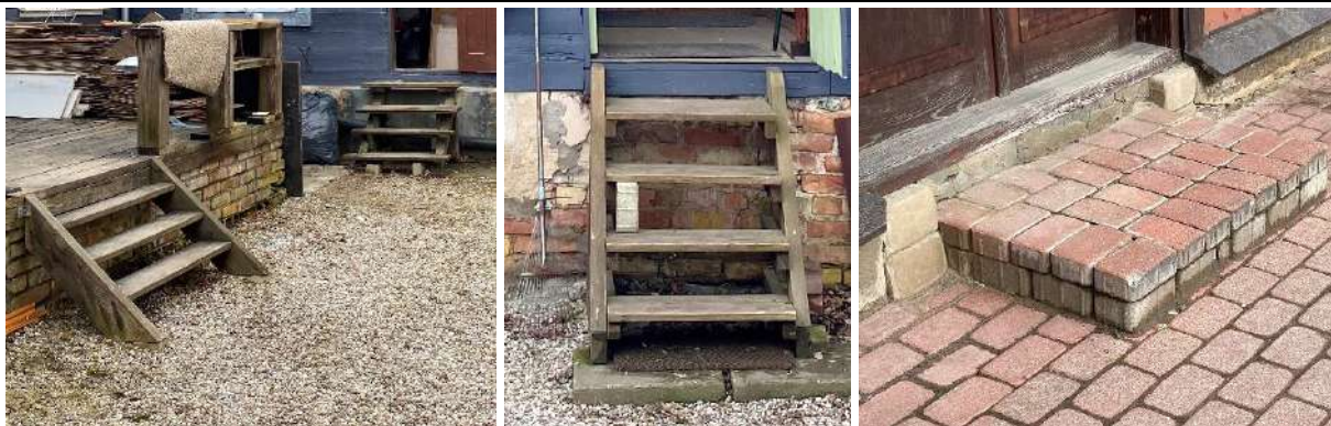
F - 65 Koka pakāpieni pie ēkas ieejām. Ziemeļu puses verandai vienam no pakāpieniem zudis balstījums, tas pabalstīts ar betona bruģakmeni. Rīgas ielas fasāde pie ieejas durvīm izbūvēti pakāpieni no betona bruģakmeņiem
