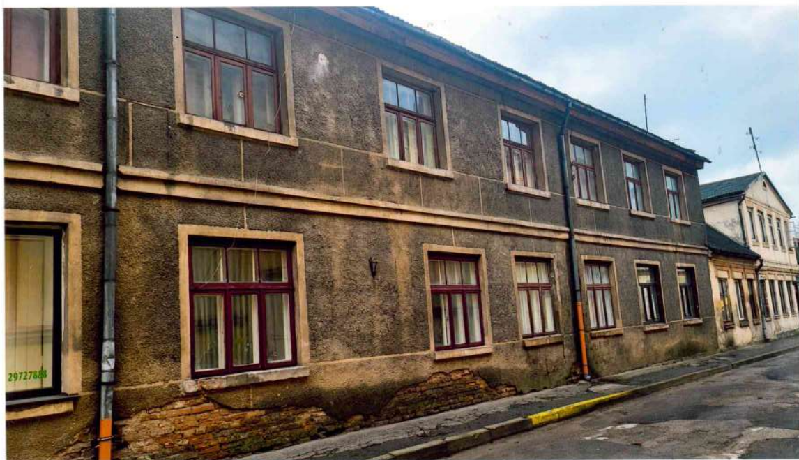
10. attēls. Ielas fasādes fragments ēkas rietumu galā. Fasādes lejasdaļā apmetums mitruma bojāts, vietām zudis. Cokolu sedz ietves segums.
