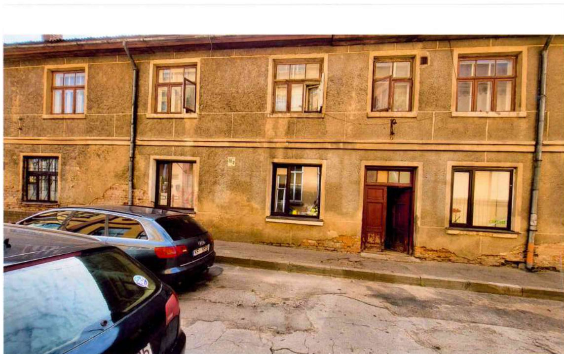
9. attēls. Ielas fasādes fragments ēkas vidusdaļā. Saglabājušās sākotnējās koka pildīņu ārdurvis D-1 un otrā stāva sākotnējie koka logi L-1, L-2 (virs ārdurvīm). Fasādes lejasdaļā apmetums mitruma bojāts. Cokolu sedz ietves segums.
