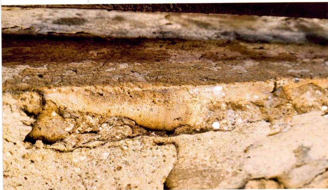
21. attēls. Logailes bojāta apmetuma fragments: ķieģeļu mūra siena apmesta ar kaļķu apmetumu vairākās kārtās.
