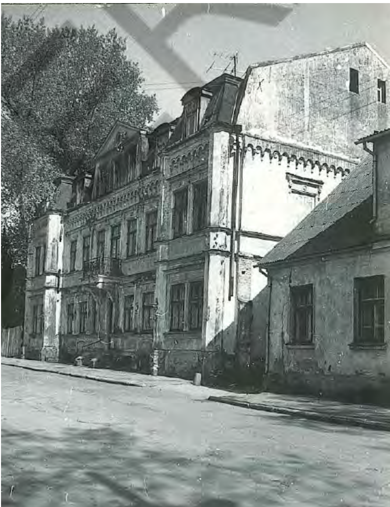
1995. g. Aizmūrētas abas ieejas pagrabā. Zudusi vārtu arka. Mansarda daļā jumta iesegums – skārds. Nacionālās kultūras mantojuma pieminekļu pārvaldes dokumentācijas centra lieta. Fotogrāfe M. Vanaga
