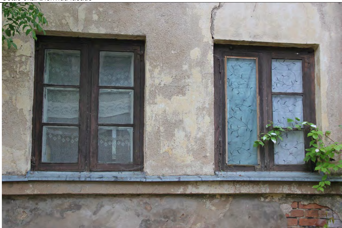
Sētas ēka. Groplogi ēkas ziemeļu fasādē. 1. stāvs
