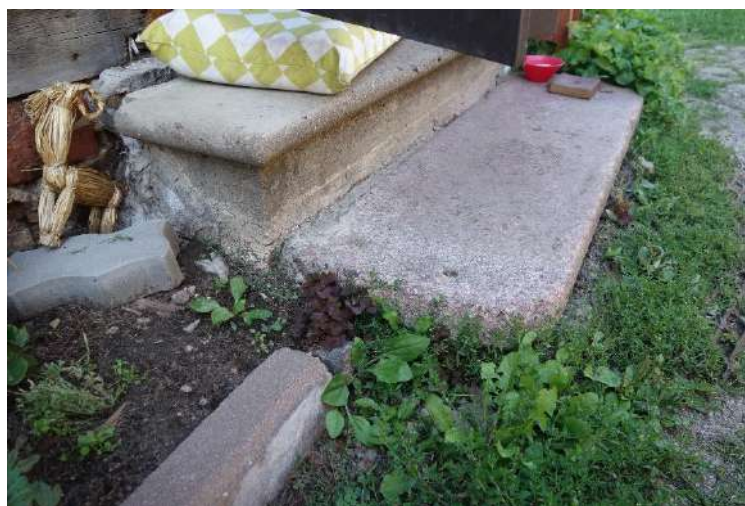
21. attēls. Granīta akmens pakāpiens pie blakus esošās ēkas (Baznīcas ielā 3) D fasādes ārdurvīm.
