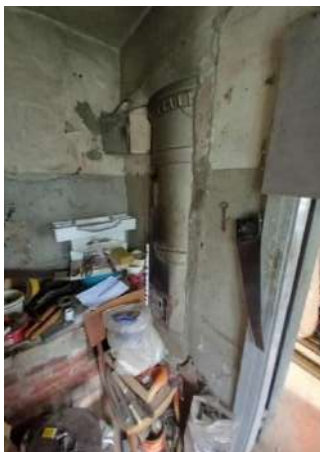
217. attēls. Krāsns dzīvoklī nr. 4.
