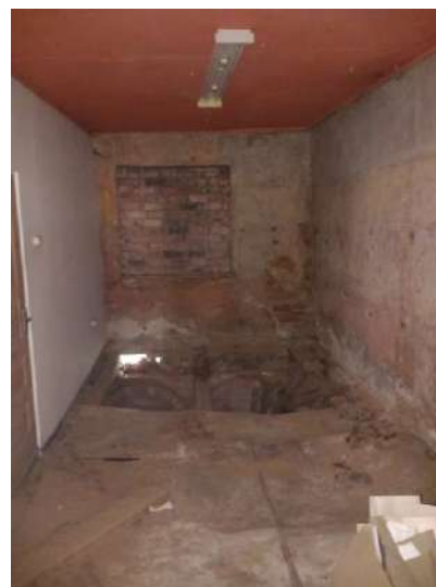
83. attēls. Telpa nr. T3, skats uz dienvidiem ar aizmūrēto logailu un iebrukušo grīdu
