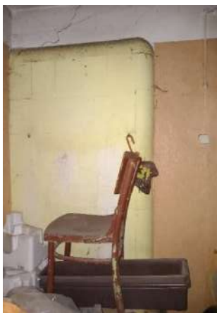
216. attēls. Krāsns dzīvoklī nr. 3
