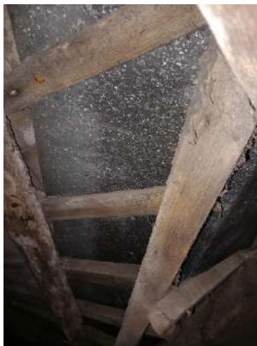
44. attēls. Skārda loksne pamatkorpusa un piebūves jumta savienojuma vietā
