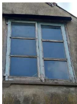
153. attēls. Ziemeļu fasādes otrā stāva rietumu puses logs, plānā L2/2
