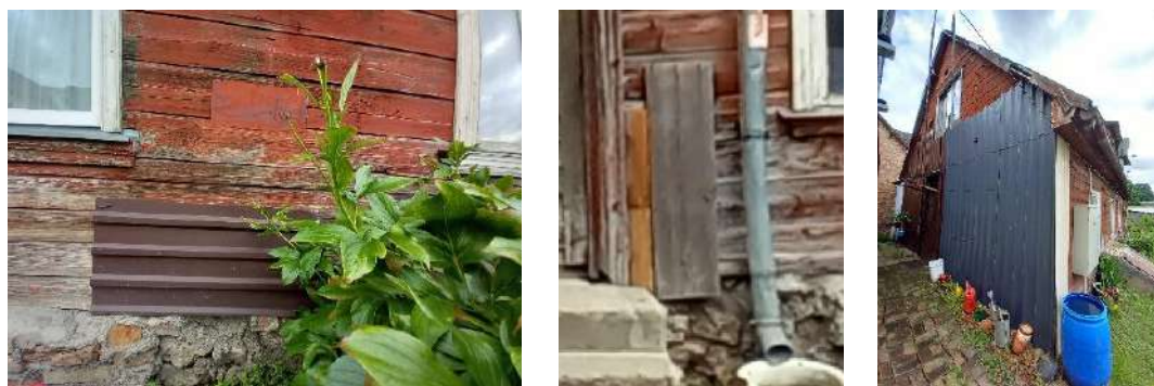
170. attēls. Dažādu laiku un materiālu fasāžu labojumi.
