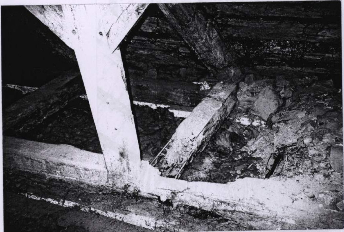
F-20 Satrupējušas jumta krēslu konstrukcijas.
