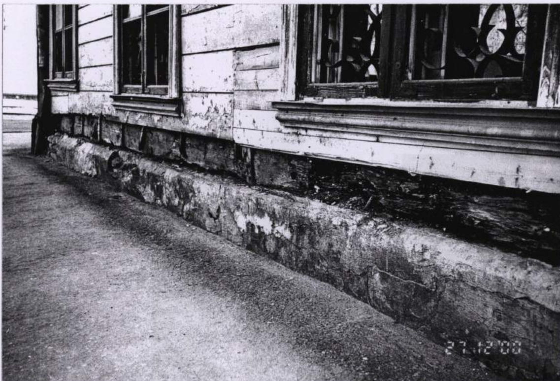
F-9 Plūdoņa ielas fasādes fragments. Satrupējuši guļbūves balķi.
