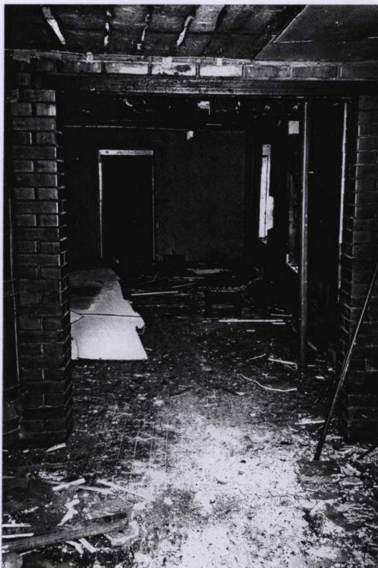
F-12 Pēdējā remonta laikā izbūvēta mūra siena. Pārsegumi balstīti ar tērauda caurulēm.
