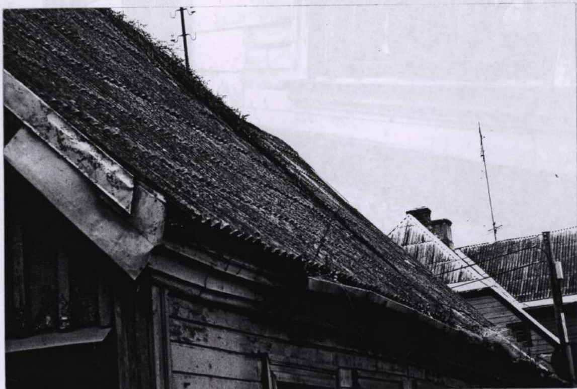
F-7 Profilētie dzegas apšuvuma dēļi. Deformētas lietus ūdens notekrenes.
