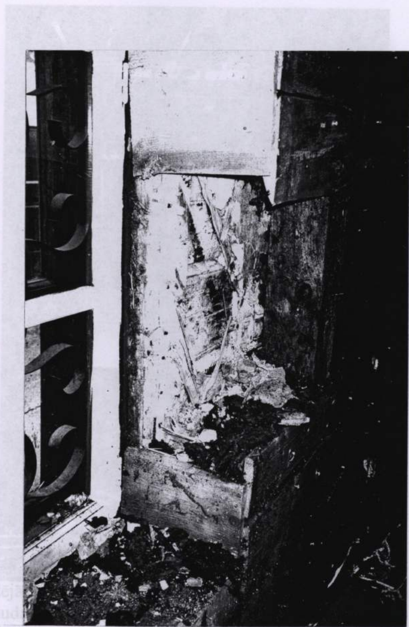
F-11 Ārsiena gar Plūdoņa ielu. Pārsegums un siena stiprināta ar statiem. Starp statiem kūdras aizbērums.
