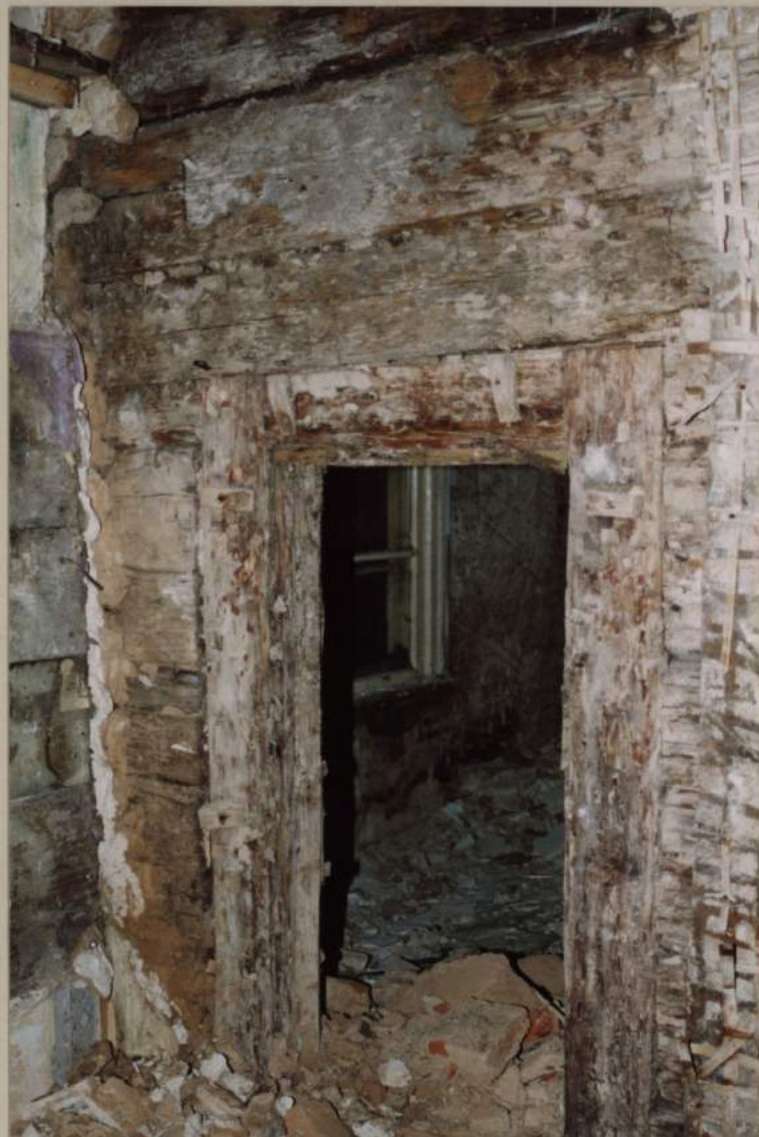
F-14 T105 D siena. Neliela durvju aila kādreizējās 18.gs. ēkas pagalma ārsienā – iespējams uz ateju. Apmetums uz ķīļiem. Pa kreisi – 20.gs. 20.gados T110 no dēļiem izbūvēta niša.
