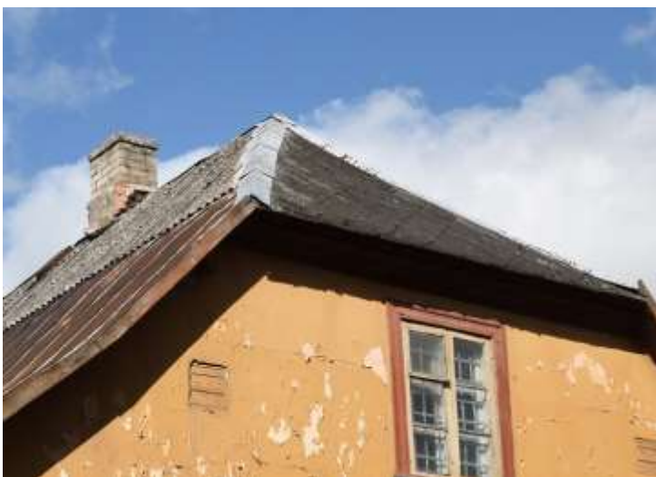
58. attēls. Ēkas pamatkorpusa A gals (skats uz ZR), kur uz jumta vienlaikus redzami visi trīs uz tā šobrīd esošie pārseguma materiāli.
