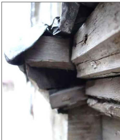
96. attēls. Profiljoslas bojājums ēkas D fasādē.
