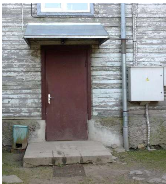
83. attēls. Padomju laikā izveidotā galvenā ieeja ēkā (durvis AD1) ar pēdējā desmitgadē uzstādītajām vērtņēm un jumtiņu.
