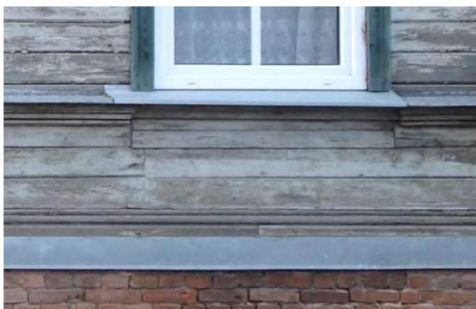
40. attēls. Trīspakāpju profiljoslas bojājums D fasādē zem loga L1/5, skats uz Z.
