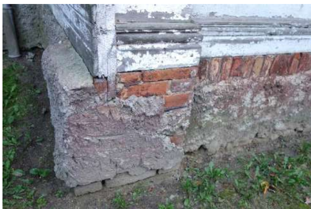
94. attēls. Virspamatu bojājumi ēkas Z fasādē.
