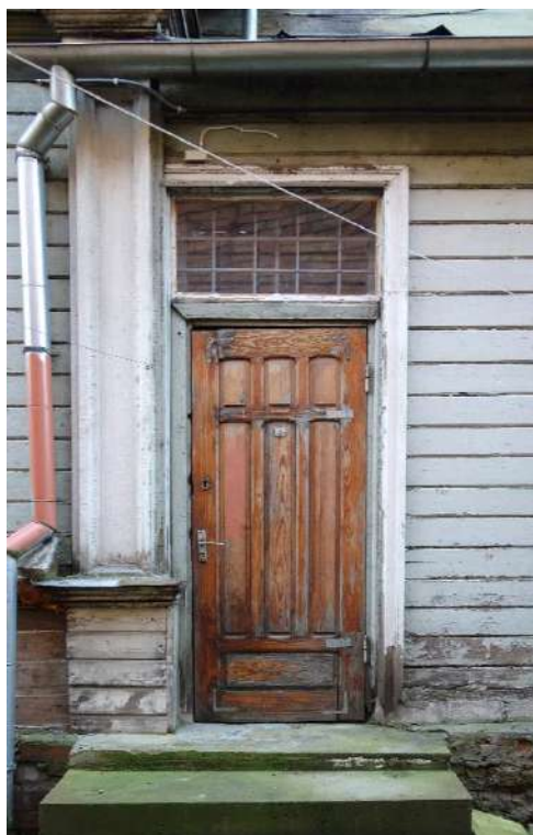
82. attēls. Saimnieciskā ieeja ēkas R fasādē (AD2). Durvjaila un apmale labajā pusē ir sākotnējā. Vērtne izgatavotas padomju laikā.
