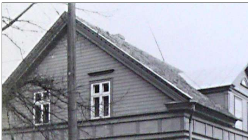
69. attēls. Ēkas jumts 1939. gadā. Redzams robdēlis abās A fasādes jumta slīpnēs. LVVA
